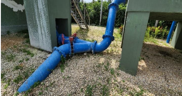
Imagen 6 Salida desarenador (entrega de agua a las 2 PTAP's).
