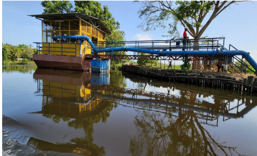
Imagen 2 Fuente de abastecimiento y captación
