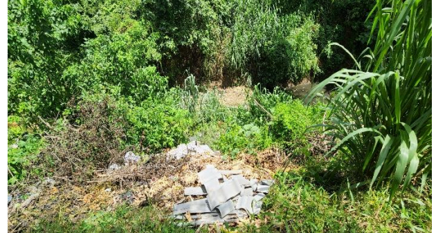
Imagen 25 Presencia de residuos sólidos y maleza sobre el canal
