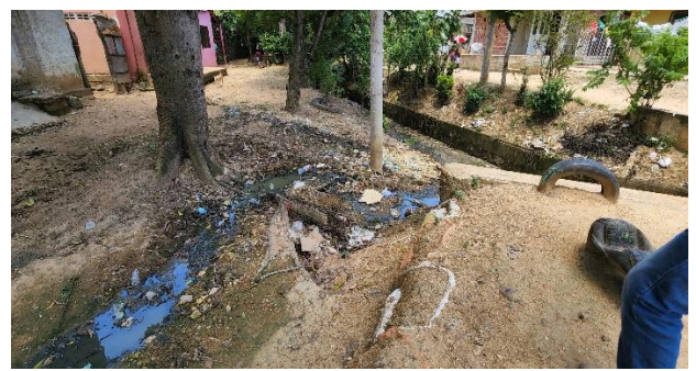
Imagen 21 Rebose de aguas residuales.
