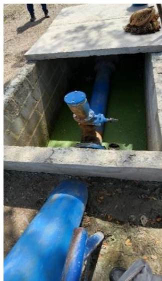
Imagen 3. Línea de aducción
