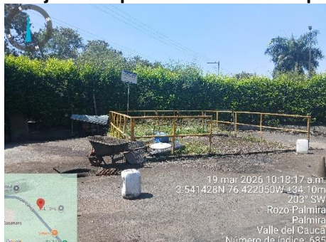
Fotografía 11. Vista tanque de almacenamiento de lixiviados ubicado al costado izquierdo de la portería, nótese que la caja de inspección carece de tapa
