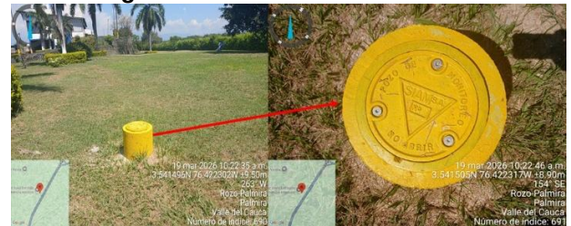
Fotografía 51. Vista piezómetro para monitoreo de aguas subterráneas en la estación
