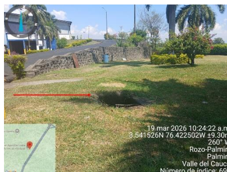
Fotografía 12. Vista de caja de inspección sin tapa junto a báscula de ingreso a zona de transferencia
