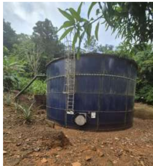
Tanque de almacenamiento
