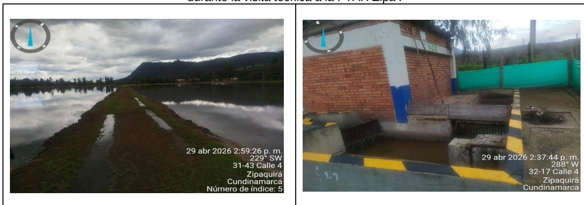
Imagen 17. Registro fotográfico - Infraestructura preliminar de tratamiento y lagunas de oxidación observadas durante la visita técnica a la PTAR Zipa I
