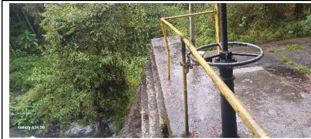
Estructura de control hidráulico mediante compuerta manual tipo volante
