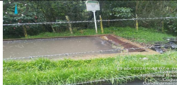
Desarenador asociado al sistema de captación previo al tratamiento
