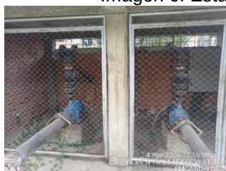
Imagen 6. Estación de bombeo San Joaquín
