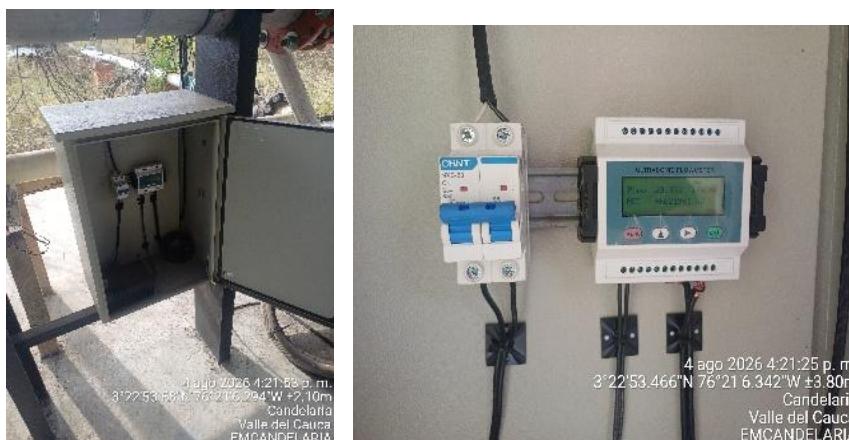
Imagen 16. Macromedición en pozo de captación – PTAP ARENAL
