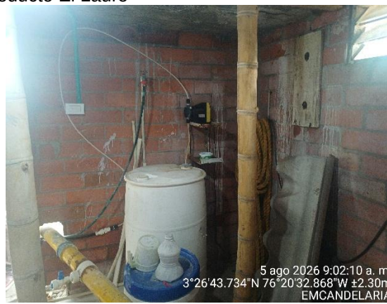
Dosificador de cloro para desinfección
