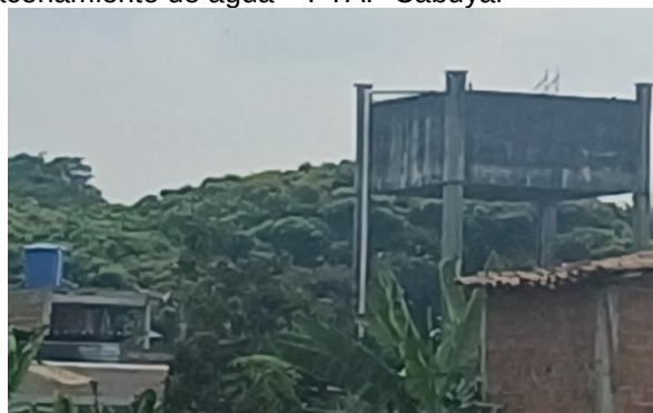
Tanques de almacenamiento de agua – PTAP Cabuyal
