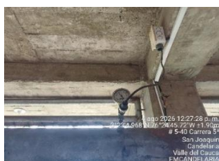
Paso de agua a electrobombas y manómetro
