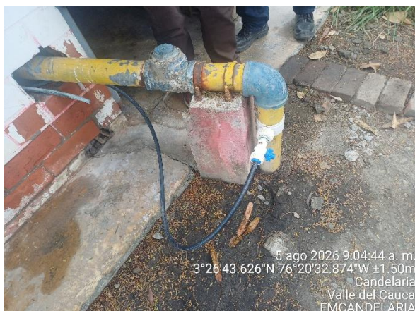
Punto de inyección de cloro
