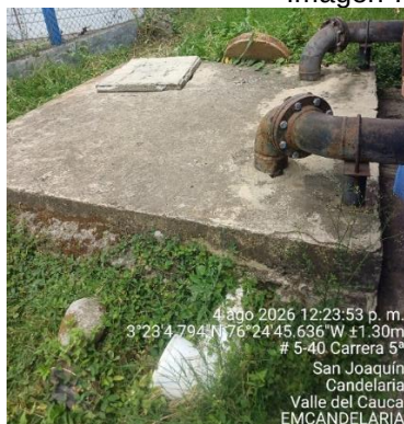
Tanque de almacenamiento temporal de agua potable – Estación de Bombeo
