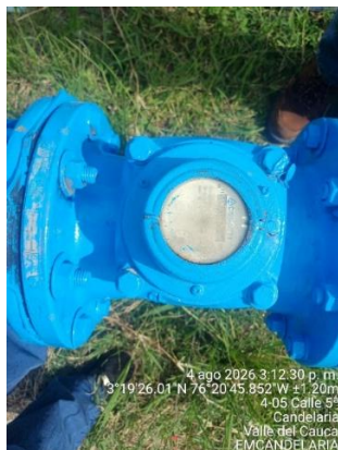
Imagen 8. Macromedidor a la salida del sistema de bombeo del pozo y entrada Planta Cabuyal
