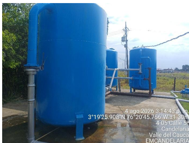
Tanque de aireación inicial
