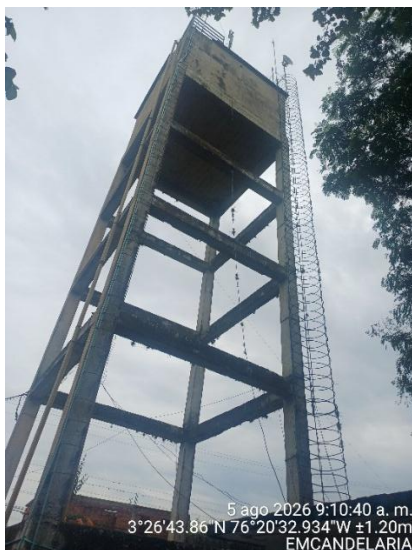
Tanque de almacenamiento
