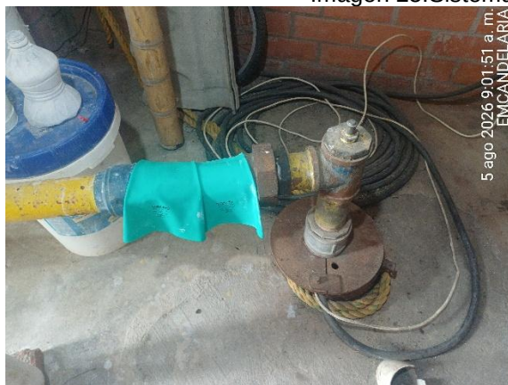
Pozo de captación de aguas subterráneas
