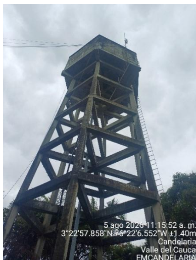
Tanque de almacenamiento
