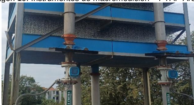
Macromedición en torre de aireación
