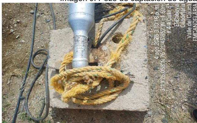
Pozo de captación de aguas subterráneas
