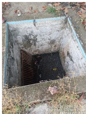
Pozos de inspección sin tapa
