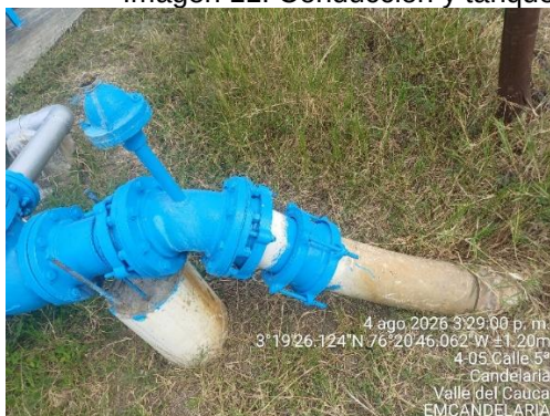
Conducción de agua potable hacia tanque de almacenamiento
