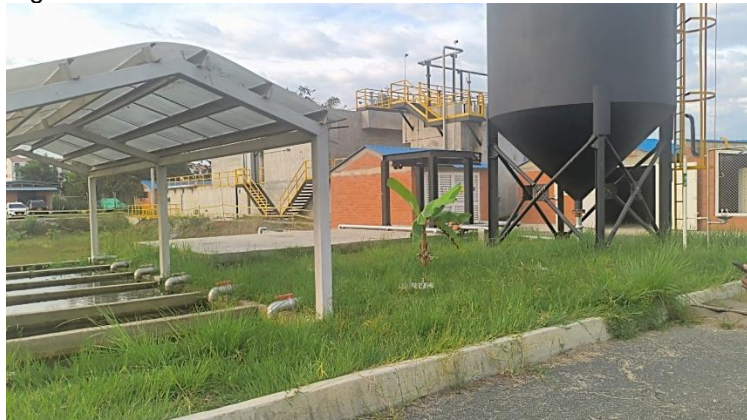
Imagen 23. Infraestructura tratamiento de Lodos – PTAP Arenal
