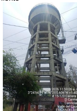
Tanque de almacenamiento El Tiple
