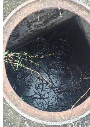
Pozos de inspección sin tapa
