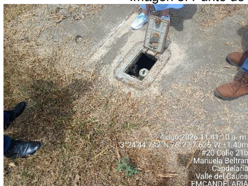
Macromedidor punto de interconexión
