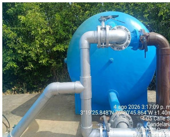
Tanque de precloración
