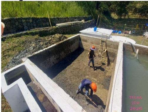
Imagen 20. Mantenimiento filtros lentos.
