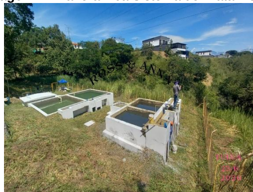
Imagen 17. Panorámica Sistema de Tratamiento.
