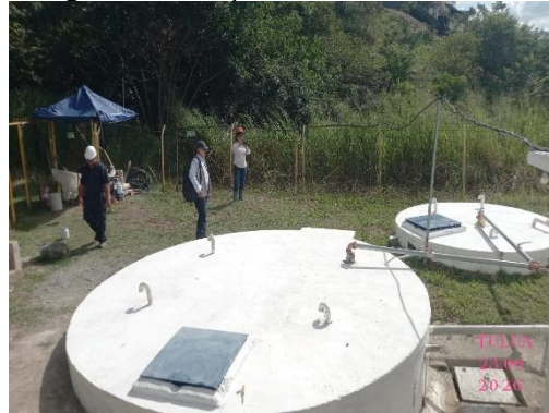
Imagen 18. Tanques de almacenamiento.
