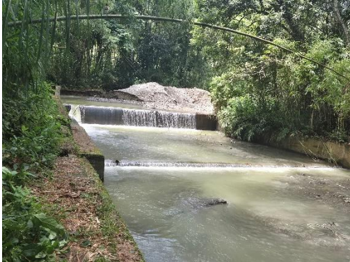
Imagen 9. Captación - Primer Partidor.
