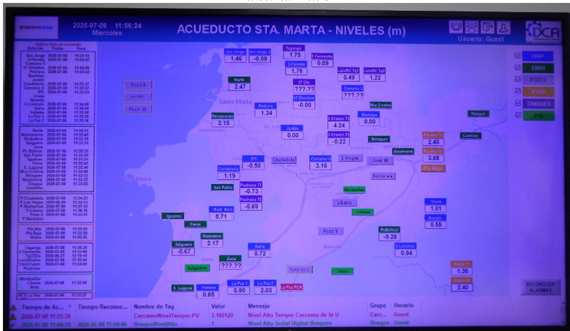
Imagen 7. Tablero telecontrol seguimiento operación de los sistemas de acueducto y alcantarillado
