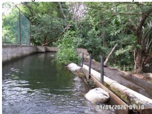
Imagen 22. Desarenador zona baja
