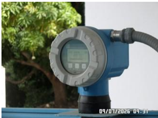
Imagen 24. Medición de caudal entrada PTAP
