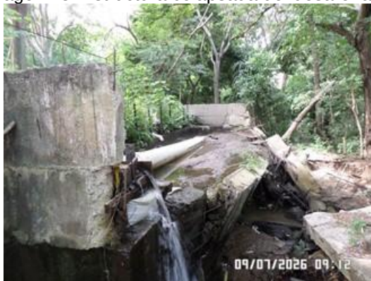
Imagen 23. Estructura colapsada del desarenador
