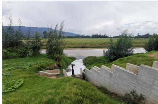
Descarga del efluente
