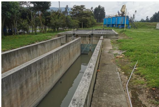
Canal de entrada y tanques de extracción de lodos
