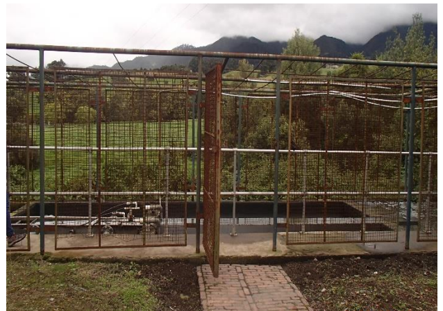
Imagen 6. Estructura de encerramiento deteriorada.
