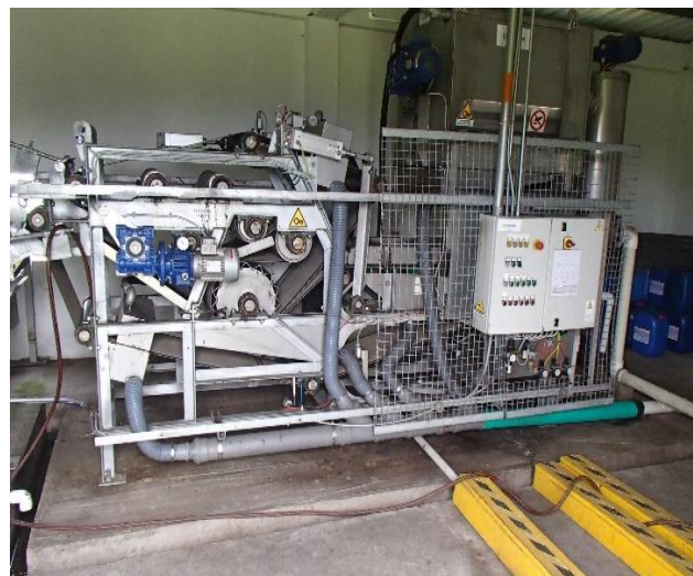
Imagen 4. Cuarto de máquinas
