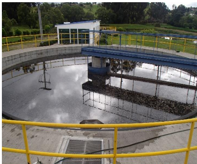
Imagen 3. Tanque de contacto
