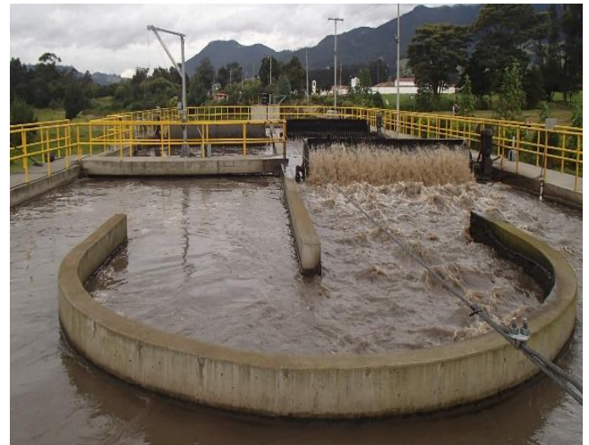
Imagen 2. Zanja de oxidación
