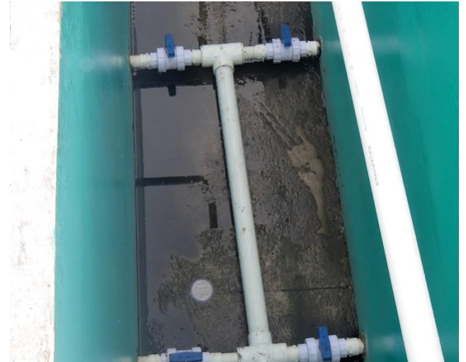
Imagen 24. Filtración de agua residual
