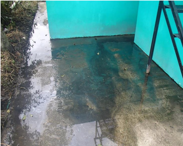
Imagen 23. Remanente de agua residual
