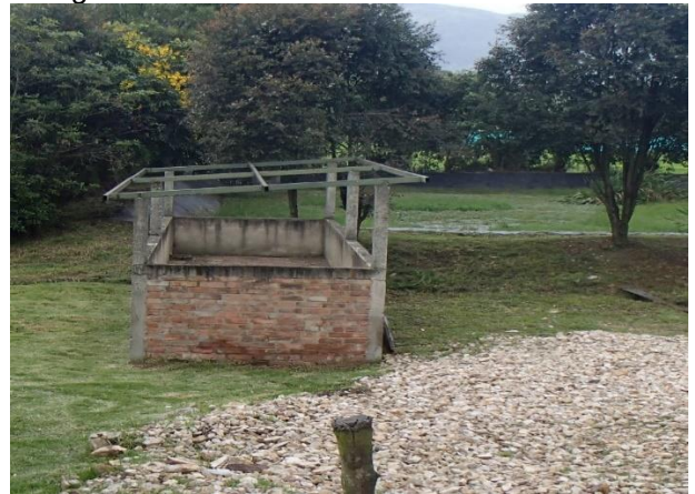
Imagen 26. Cuna de secado de lodos sin cubierta
