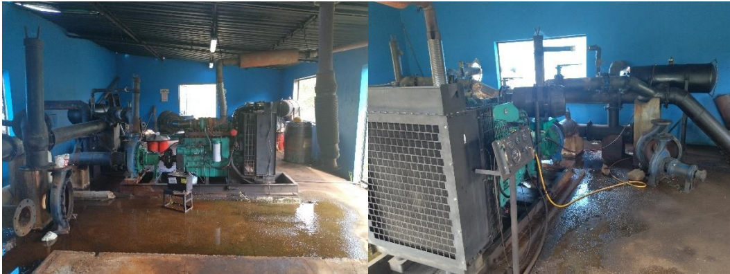
Imagen 14. Sistema de Impulsión
