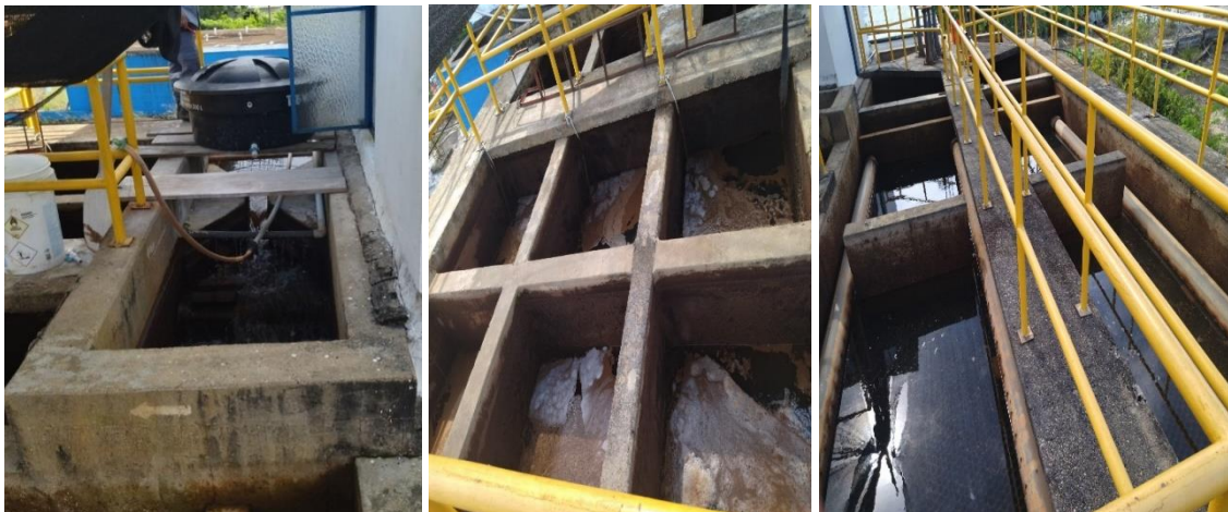
Imagen 10. Módulo de coagulación, floculación y sedimentación.
