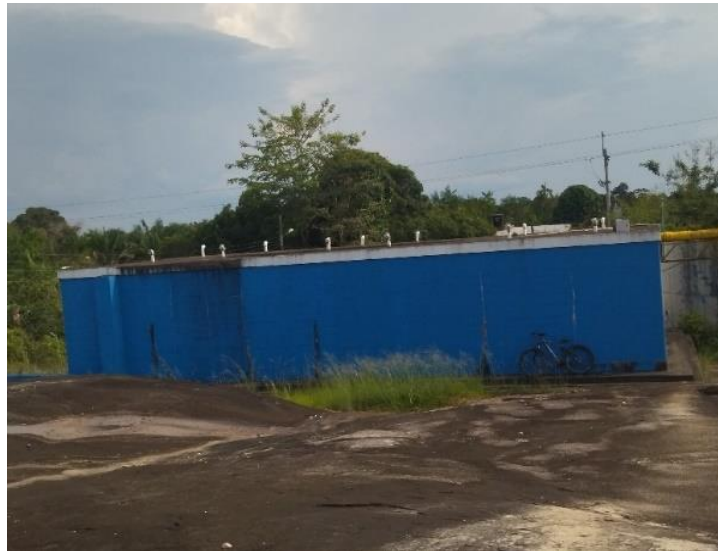
Imagen 13. Tanque de almacenamiento de agua tratada
