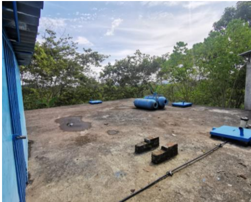
Imagen 13. Tanques de almacenamiento
