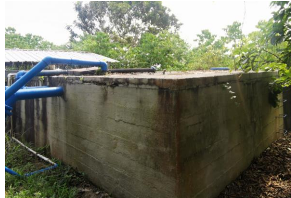
Tanques Planta Oriente
