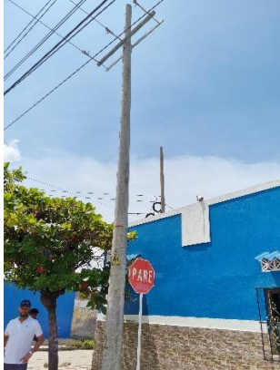
11°00'37.6"N 74°14'46.5"W Poste 12x1030 Inicio tramo conductor 4/0
