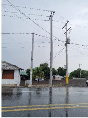
10°58'42.9"N 74°19'32.7"W Estructura fin de circuito
