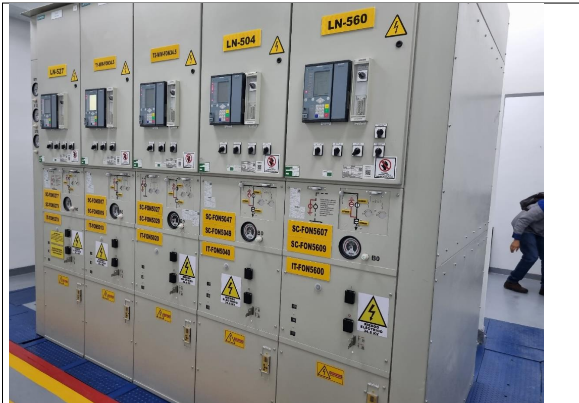
Gabinete de llegada – Salida tipo interior SF6 – Barra sencilla – UC NS361 – 3 UNIDADES Control y protección Bahía de línea N3- UC N3P1 – 3 UNIDADES
