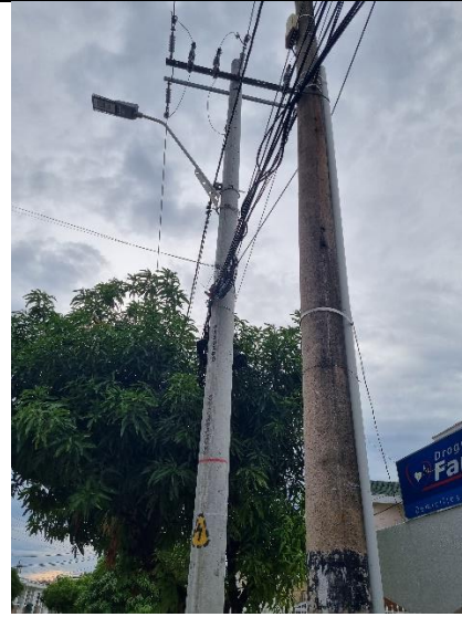
11°00'16.0"N 74°49'56.6"W Seccionamiento y poste 12x1324
