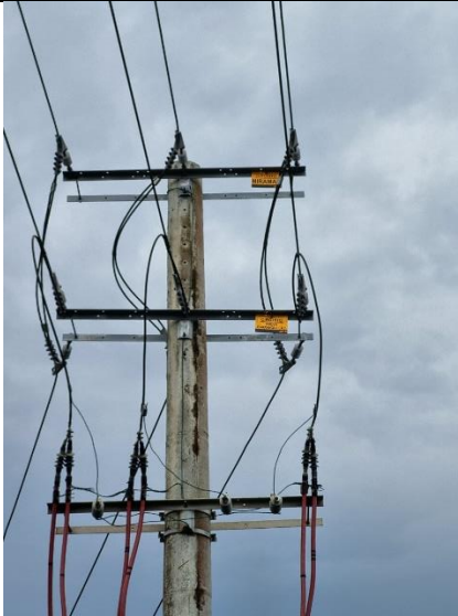
10°59'49.0"N 74°50'32.0"W Estructura terminal circuito Miramar 1324 metros
