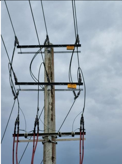
10°59'49.0"N 74°50'32.0"W Estructura terminal circuito Miramar 1324 metros
