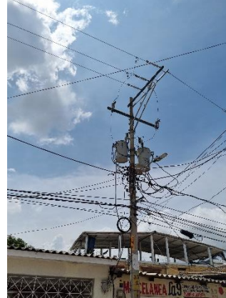
11°00'41.8"N 74°14'49.6"W Inicio tramo 2 en cable AAC 123
