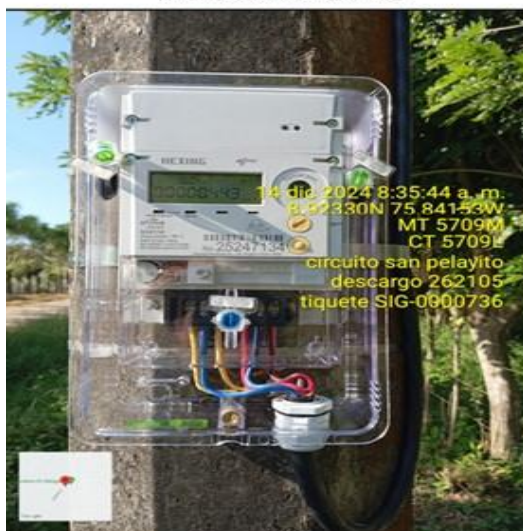
FOTO MACROMEDIDA INSTALADA
