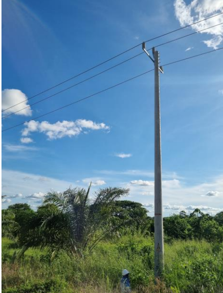
10°30'29.5"N 74°09'45.8"W, Poste de 14x1324 y SPT
