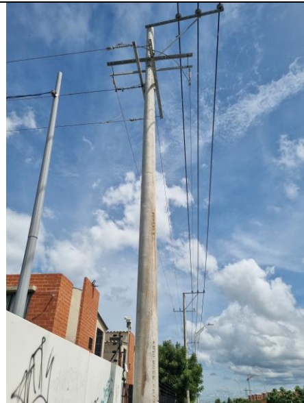
10°55'10.9"N 74°46'56.4"W, Estructura fin de tramo 2 conductor AAAC 123, 300 ml.
