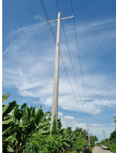
10°44'33.9"N 74°09'11.5"W, Poste de 14x1030 y SPT.
