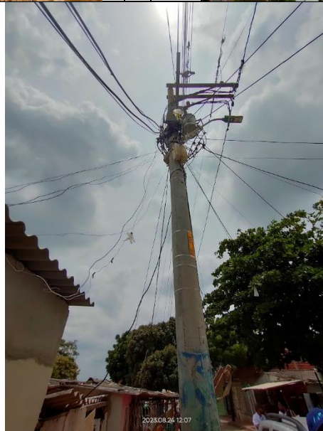
10°58'14.7"N 74°49'15.8"W AOE con sistema de puesta a tierra del transformador.
