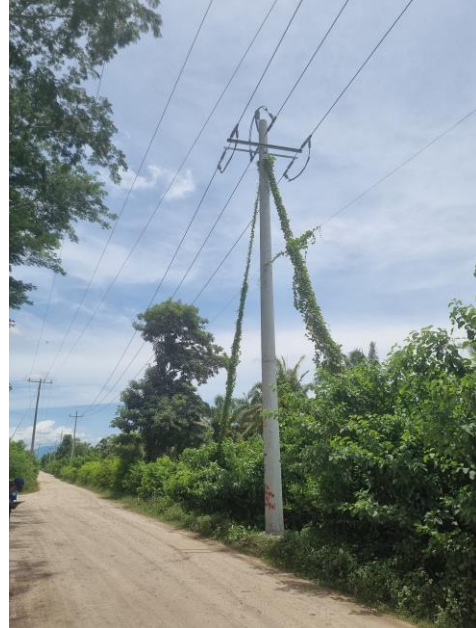
10°43'24.0"N 74°11'52.3"W, Poste de 14x2500 y SPT.
