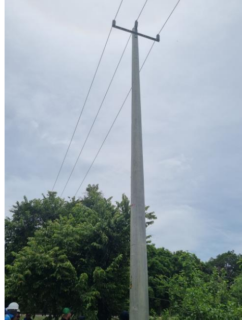
10°39'16.8"N 74°10'07.2"W, Poste de 16x2500 y SPT.
