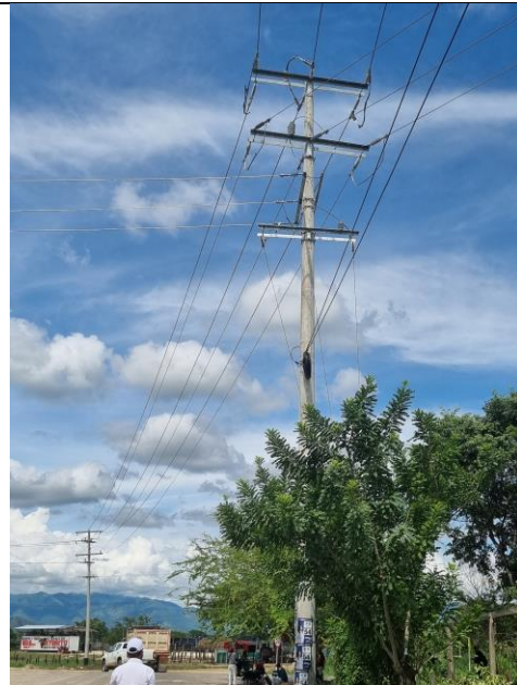
10°35'28.6"N 74°10'12.9"W, Poste de 18x1350 y SPT.
