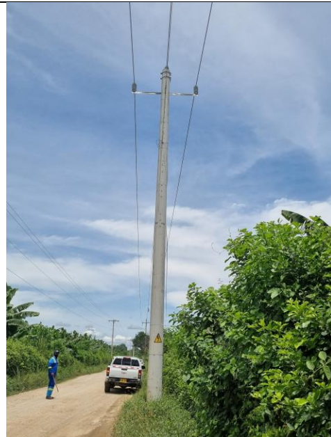
10°44'07.1"N 74°11'02.3"W, Poste de 14x2500 y SPT.
