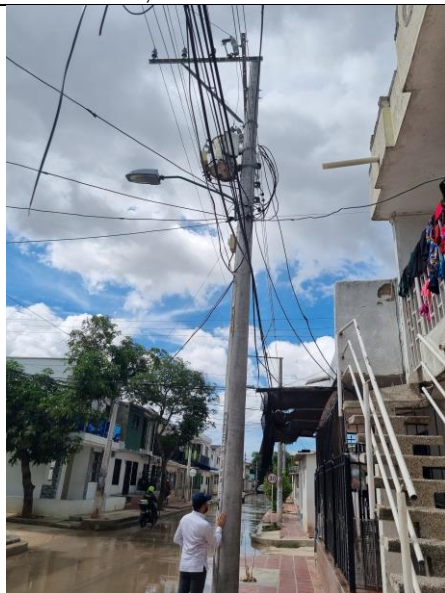
10°54'32.8"N 74°47'04.8"W, Poste de 12x1324 y puesta a tierra reportada.
