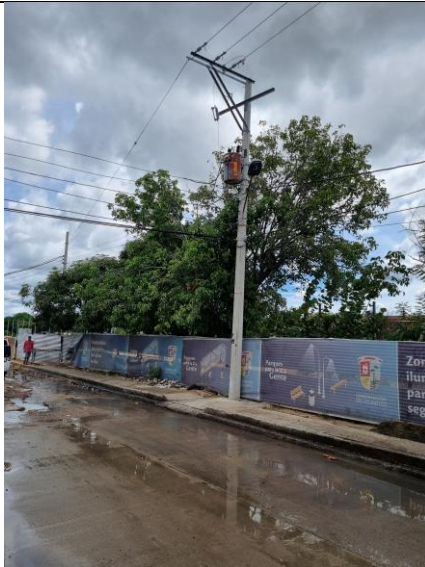
10°54'18.1"N 74°47'06.2"W, Poste de 12x1324 y puesta a tierra reportada.
