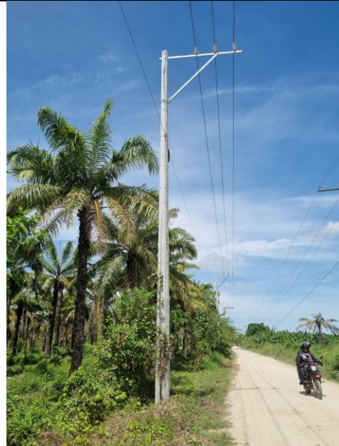
10°44'30.6"N 74°09'24.3"W, Poste de 14x1324 y SPT.
