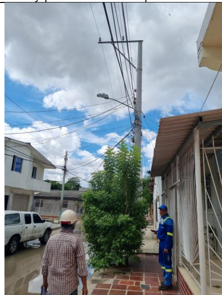
10°54'34.4"N 74°47'04.5"W, Poste de 12x1324 y puesta a tierra reportada.
