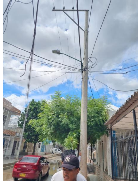
10°54'31.9"N 74°47'04.9"W, Poste de 12x1324 y puesta a tierra reportada.
