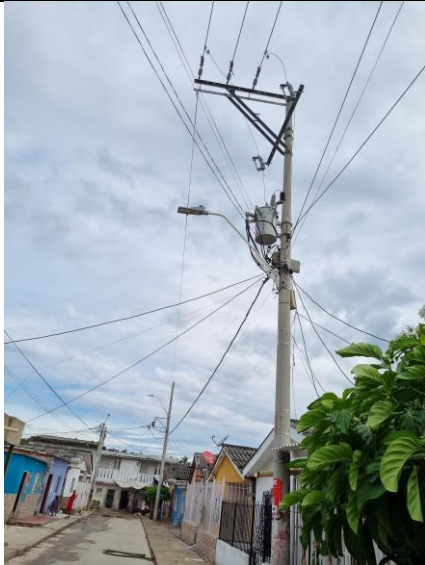
10°59'23.8"N 74°46'40.5"W, Estructura inicio tramo 2 en cable AAAC 246,9.
