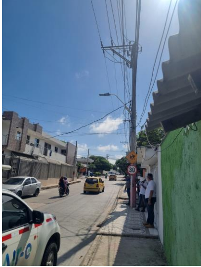
10°58'30.3"N 74°48'47.4"W, Estructura inicio tramo 2 en cable AAAC 123
