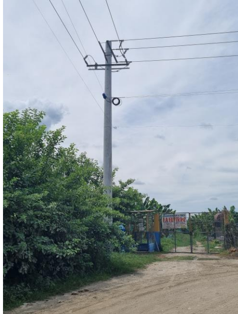
10°44'09.9"N 74°10'35.1"W, Poste de 14x4000 y SPT.
