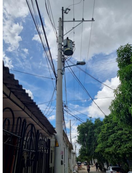
10°54'22.4"N 74°47'07.3"W, Poste de 12x1324 y puesta a tierra reportada.
