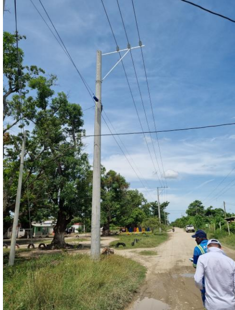
10°44'22.4"N 74°09'55.5"W, Poste de 14x2500 y SPT.
