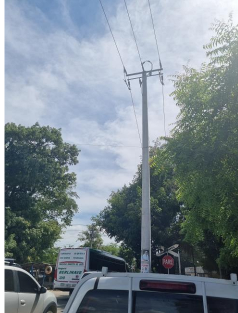
10°35'16.8"N 74°11'26.7"W, Poste de 18x1350 y SPT
