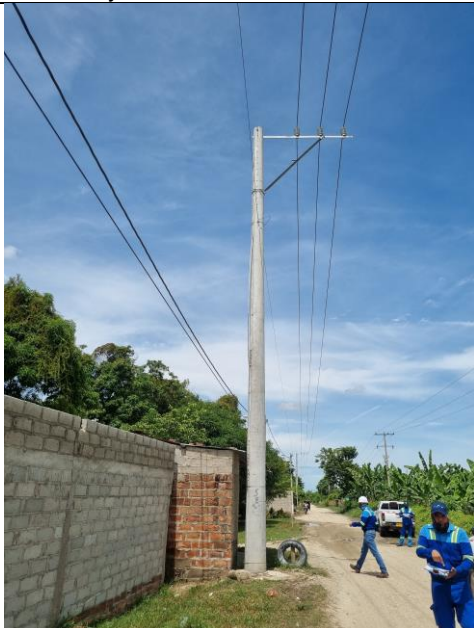
10°44'24.9"N 74°09'50.3"W, Poste de 14x2500 y SPT.
