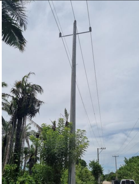
10°43'44.2"N 74°11'45.3"W, Poste de 14x1324 y SPT.
