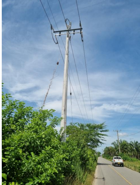
10°44'36.5"N 74°09'04.6"W, Poste de 14x1324 y SPT.
