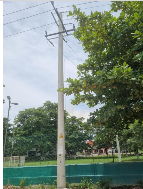
10°43'14.0"N 74°11'55.6"W, Poste de 14x2500 y SPT.
