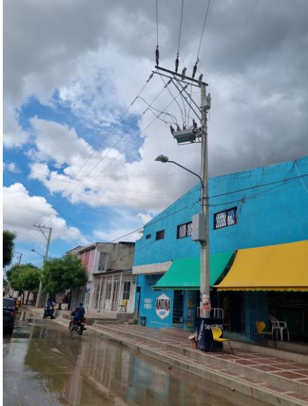
10°54'30.5"N 74°47'05.2"W, Estructura inicio tramo 3, conductor AAAC 123
