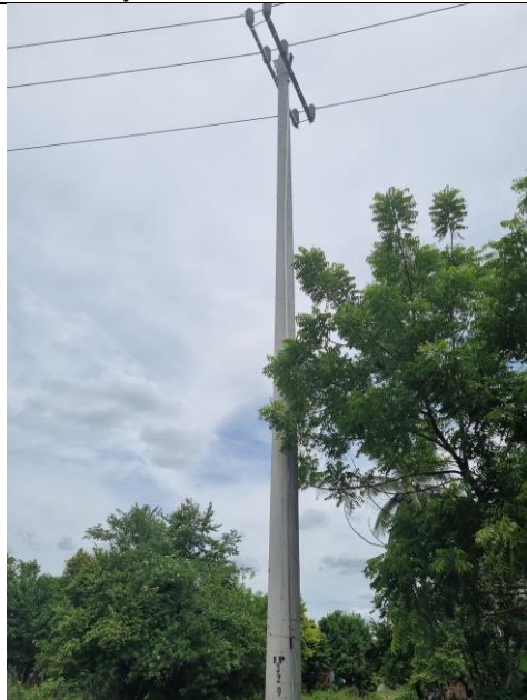
10°39'15.5"N 74°10'02.8"W, Poste de 14x1050 y SPT.
