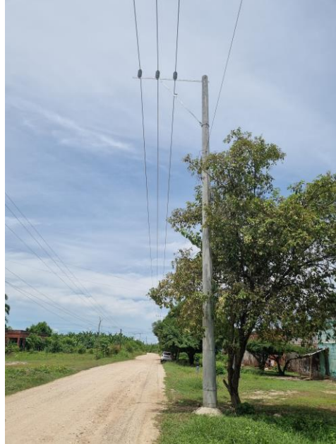
10°44'02.0"N 74°11'31.8"W, Poste de 14x1324 y SPT.
