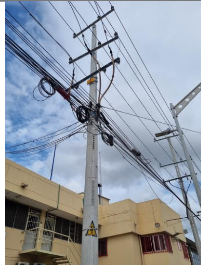
11°01'46.1"N 74°48'23.3"W, Estructura inicio tramo circuito Siape, en conductor 336 Kcmil.
