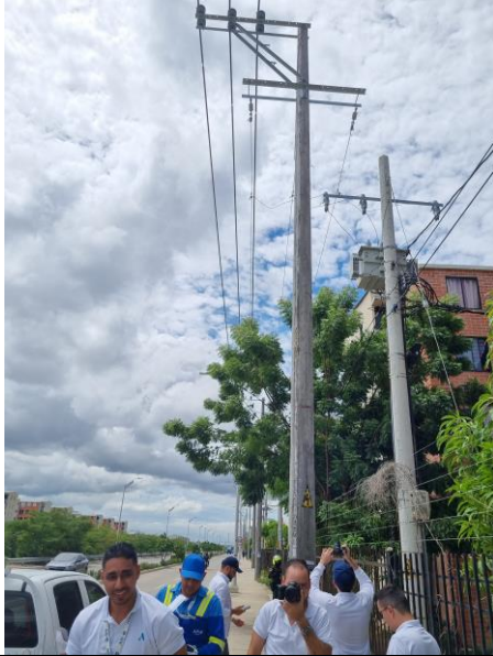
10°54'52.1"N 74°46'47.6"W, Poste de 14x1324, inicio tramo AAAC 123.
