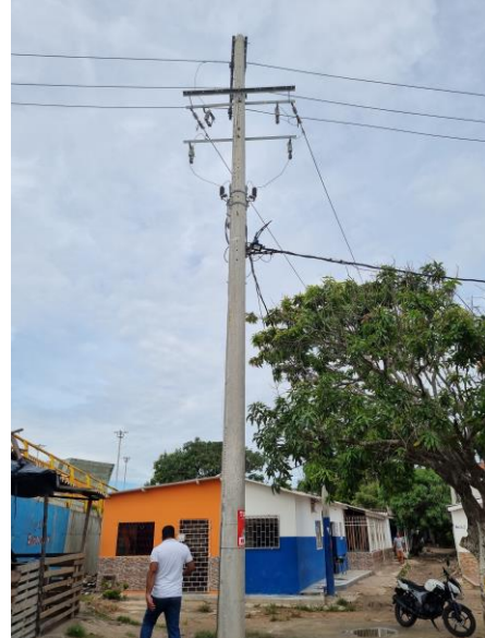
10°59'19.5"N 74°46'35.8"W, Poste de 14x1324, deriva tramo bifásico
