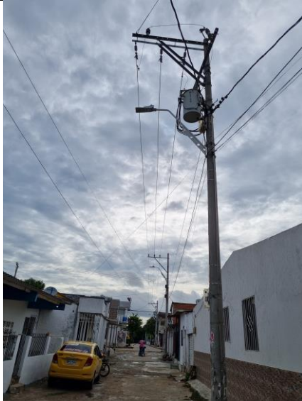
10°59'22.6"N 74°46'41.5"W, Estructura inicio tramo 1 conductor AAAC 246,9.
