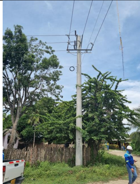
10°44'13.6"N 74°10'36.5"W, Poste de 14x4000 y SPT.
