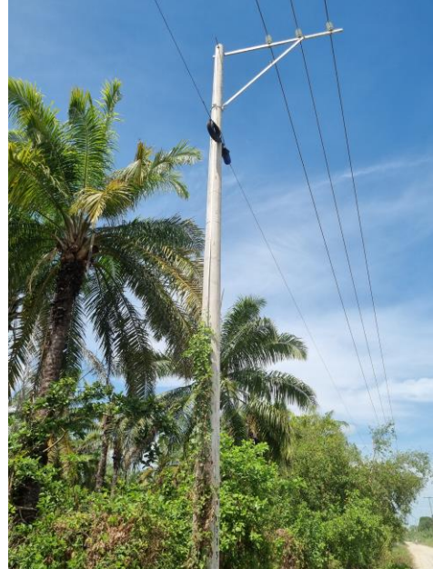
10°44'31.5"N 74°09'21.0"W, Poste de 14x1030 y SPT.
