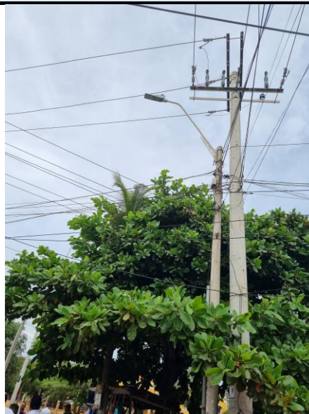
10°59'20.2"N 74°46'40.4"W, Estructura cambio de dirección.
