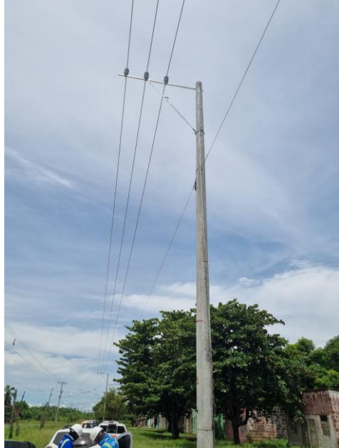
10°44'02.6"N 74°11'29.1"W, Poste de 14x1324 y SPT.
