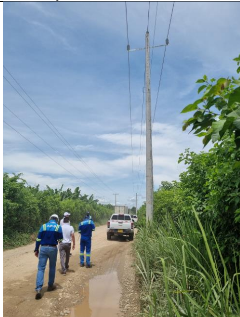
10°44'07.3"N 74°10'58.6"W, Poste de 14x1324 y SPT.
