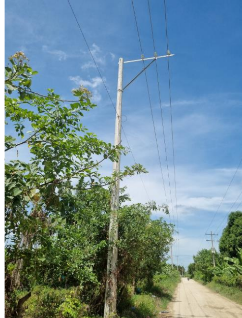
10°44'29.5"N 74°09'29.6"W, Poste de 14x1324 y SPT.
