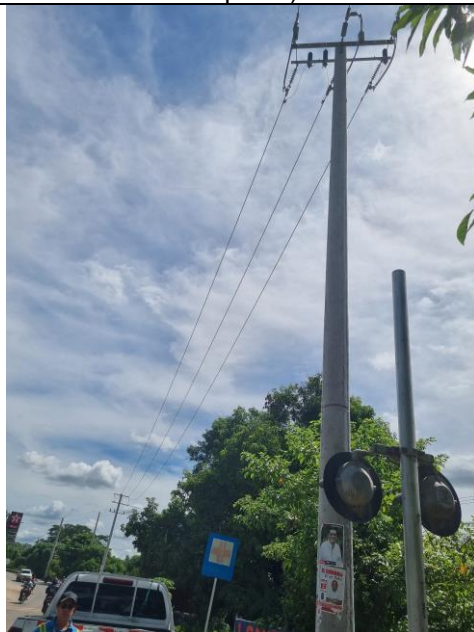
10°35'14.9"N 74°11'28.2"W, Poste de 16x2500 y SPT
