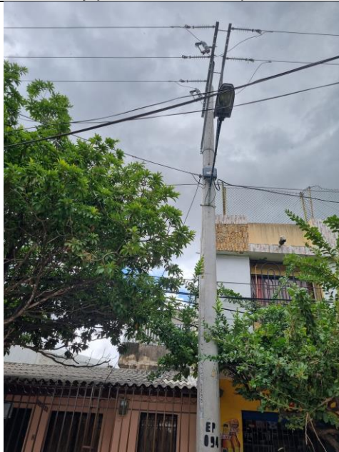
10°54'40.7"N 74°47'03.1"W, Estructura inicio tramo 4 conductor AAAC 123.
