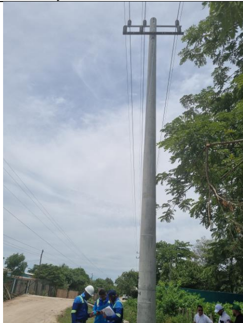
10°43'17.6"N 74°11'54.2"W, Poste de 14x2500 y SPT.
