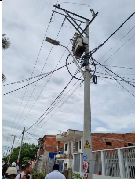
10°59'22.4"N 74°46'37.3"W, Poste de 12x1050, inicio tramo 3 cable AAAC 246,9.
