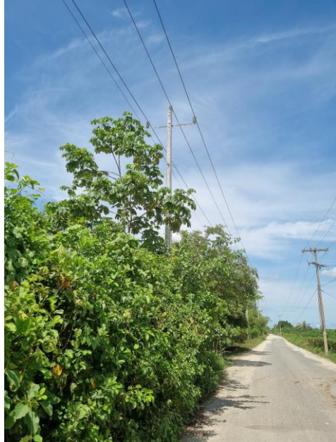
10°44'31.8"N 74°09'18.9"W, Poste de 14x1030 y SPT.
