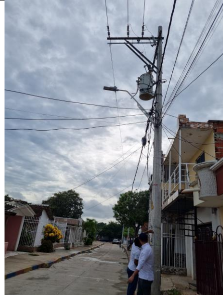
10°59'23.0"N 74°46'38.6"W, Estructura final tramo 1 cable AAAC 246,9 80 ml.
