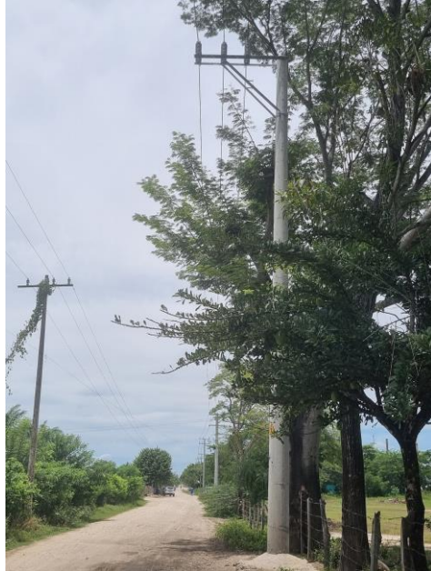
10°43'21.4"N 74°11'52.8"W, Poste de 14x2500 y SPT.
