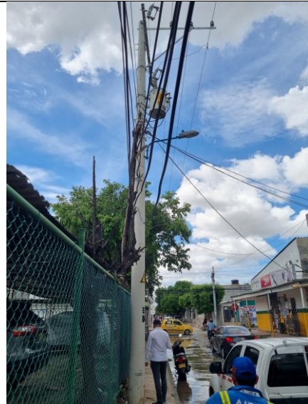
10°54'20.2"N 74°47'06.7"W, Poste de 12x1324 y puesta a tierra reportada.
