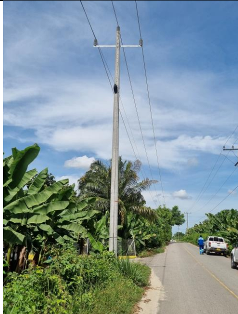
10°44'33.4"N 74°09'13.2"W, Poste de 14x1030 y SPT.
