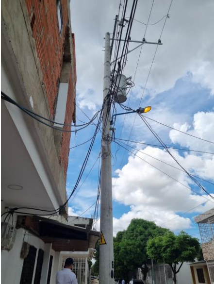
10°54'21.6"N 74°47'07.1"W, Poste de 12x1324 y puesta a tierra reportada.
