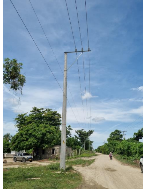
10°44'21.8"N 74°09'59.9"W, Poste de 14x2500 y SPT.
