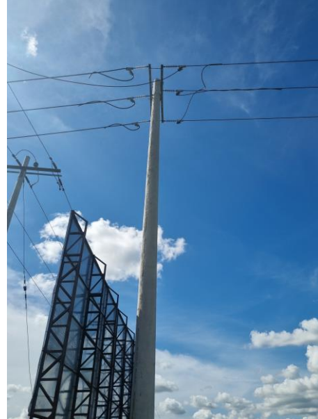
10°32'01.2"N 74°10'51.4"W, Poste de 16x2500 y SPT, fin tramo semiaislado 336 Kcmil. 4.930 metros
