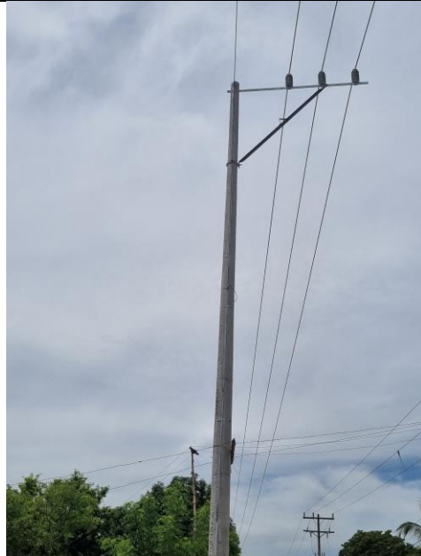
10°43'39.8"N 74°11'46.6"W, Poste de 14x1324 y SPT.
