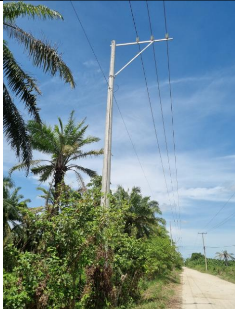
10°44'30.8"N 74°09'22.8"W, Poste de 14x1030 y SPT.
