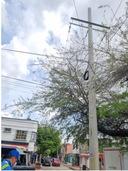
10°54'31.9"N 74°46'57.9"W, Poste de 12x1324, SPT e inicio tramo 1 conductor AAAC 123.
