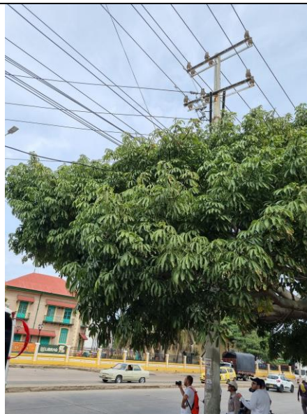
10°59'23.0"N 74°46'46.3"W, estructura inicio Tramo 6 cable AAAC 246,9.
