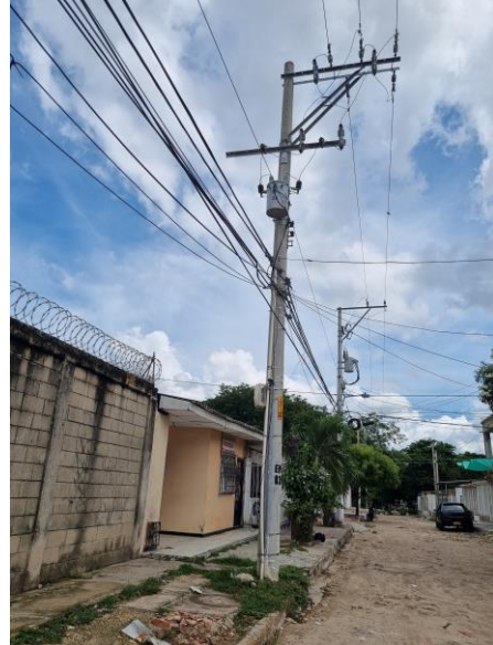
10°54'22.0"N 74°46'56.3"W, Estructura final tramo 1 cable AAAC 123, 300 ml.
