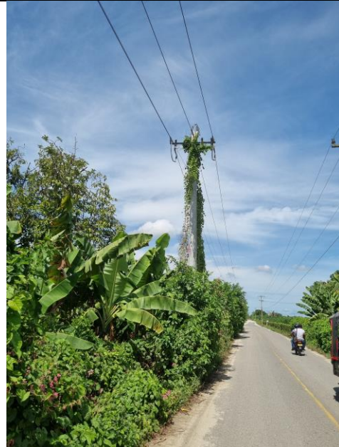
10°44'32.4"N 74°09'16.2"W, Poste de 14x2500 y SPT, fin tramo 1 conductor 394, 570 ml.
