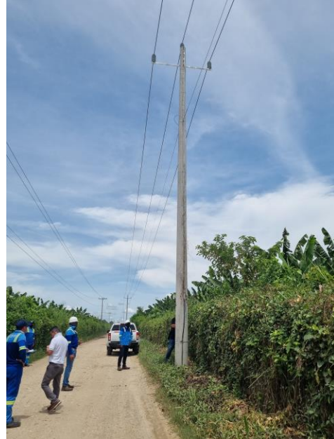
10°44'06.8"N 74°10'51.2"W, Poste de 14x1324 y SPT.
