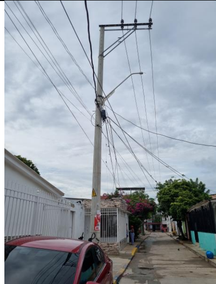
10°58'27.2"N 74°48'32.1"W, Estructura final tramo 1 en cable AAAC 123, 420 ml.
