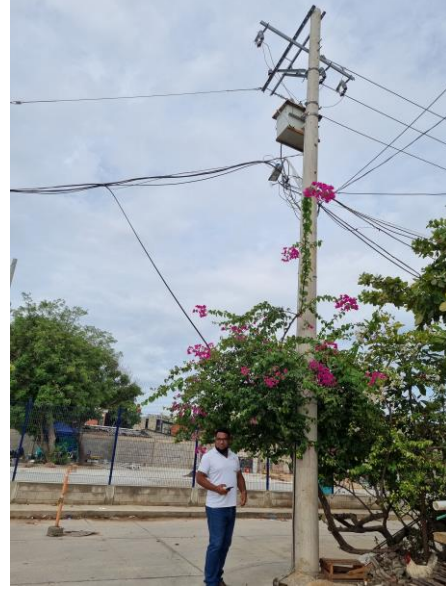
10°59'13.6"N 74°46'32.5"W, Estructura de inicio tramo No 4 en cable AAAC 246,9.
