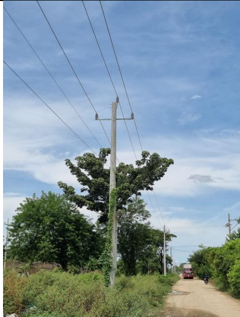
10°44'21.8"N 74°09'59.9"W, Poste de 14x2500 y SPT.
