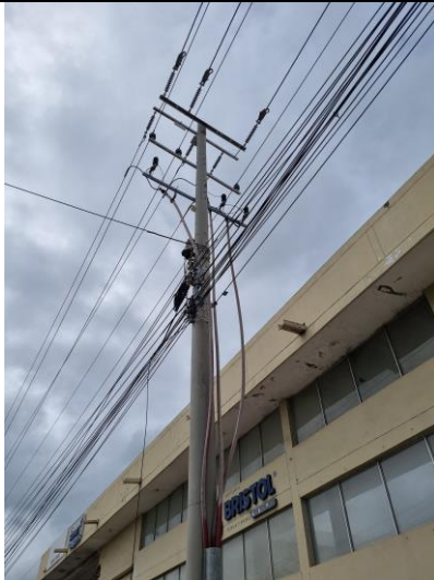
11°01'49.3"N 74°48'25.9"W, Estructura inicio tramo circuito Rayón Norte, en conductor 477 Kcmil.
