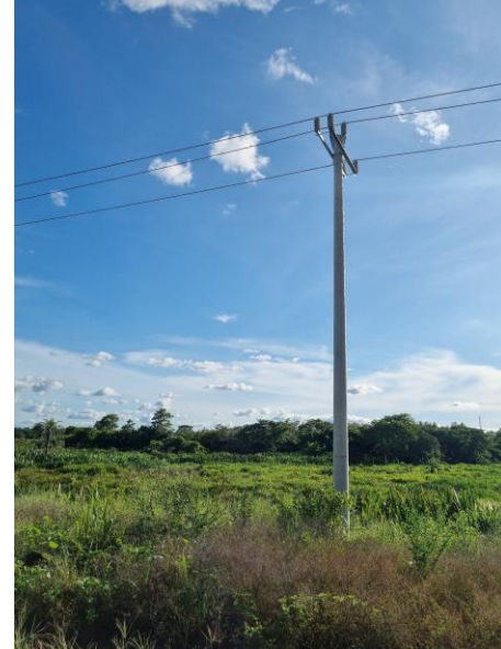
10°30'37.1"N 74°09'47.6"W, Poste de 14x1324 y SPT
