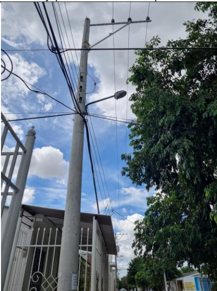
10°54'23.0"N 74°47'07.3"W, Poste de 12x1030 y puesta a tierra reportada.
