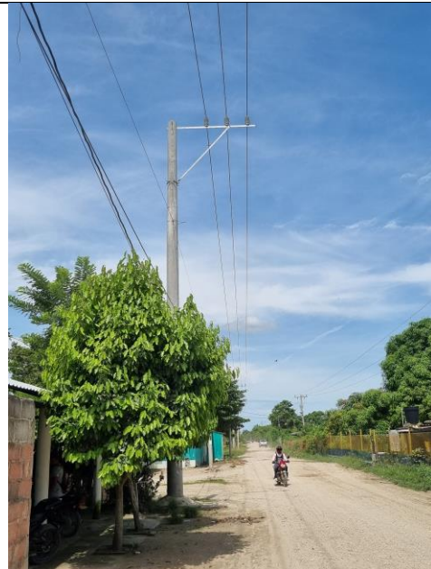
10°44'24.1"N 74°09'53.0"W, Poste de 14x2500 y SPT.
