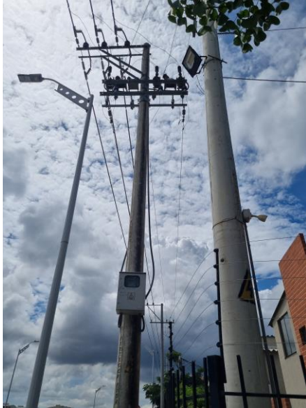
10°55'02.2"N 74°46'52.0"W, Poste de 14x1324 y inicio tramo 2 conductor AAAC 123
