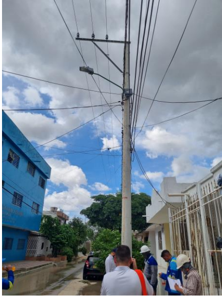
10°54'39.4"N 74°47'04.1"W, Poste de 12x1350 y puesta a tierra reportada.
