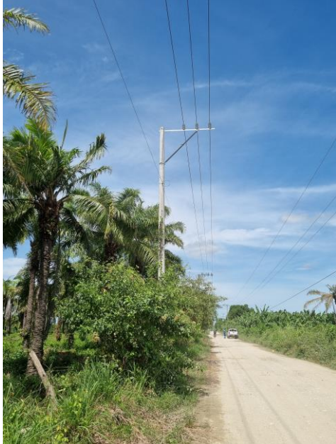
10°44'30.9"N 74°09'25.4"W, Poste de 14x1324 y SPT.
