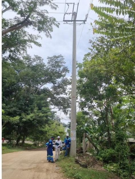
10°39'17.2"N 74°10'09.1"W, Poste de 16x2500 y SPT.
