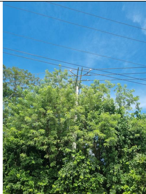
10°34'31.1"N 74°11'41.5"W, Estructura inicio cable semiaislado 336 Kcmil.
