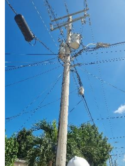
10°56'45.1"N 74°45'46.5"W, Estructura inicio tramo No 3 AAAC 123.
