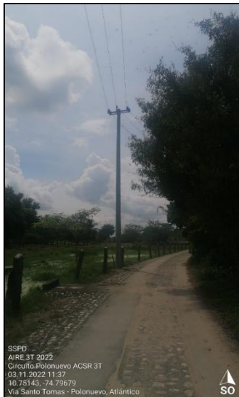
Circuito Polonuevo – Reemplazo ACSR
