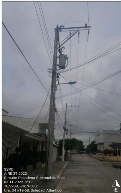
Circuito Pasadena _Sustitución Red Monohilo
