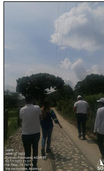
Circuito Polonuevo – Reemplazo ACSR
