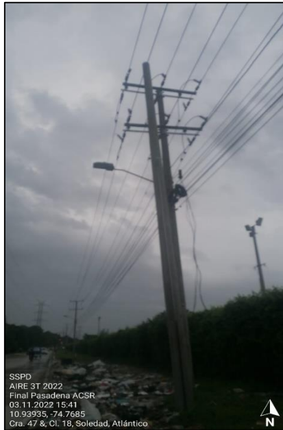
Circuito Pasadena – Reemplazo ACSR
