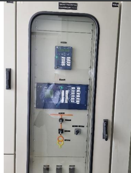
Módulo control transformador- UC NOP3
