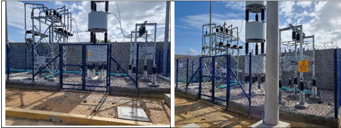
Banco compensación tipo pedestal 13,8 KV, 3 MVAR – UC N2EQ3E Fuente: SSPD visita en campo
