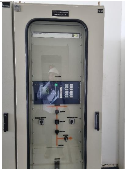
Módulo control transformador- UC NOP3
