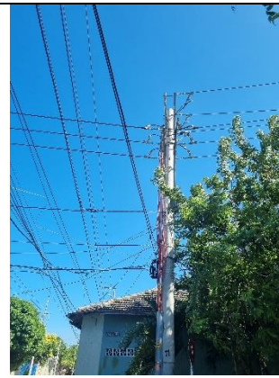
10°58'33.2"N 74°47'26.3"W, Estructura termina cable CF200, 150 metros aproximadamente.
