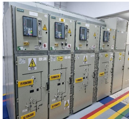
Control y Protecciones 4 UND - UC N2P1
