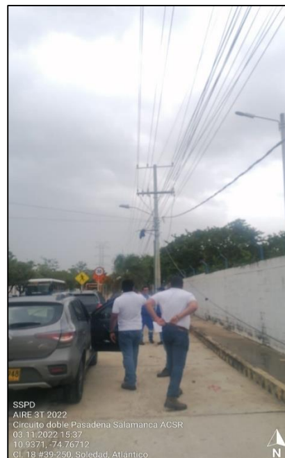
Circuito Salamanca – Pasadena – Reemplazo ACSR
