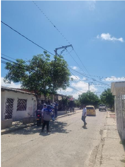
10°58'47.9"N 74°50'37.6"W, Estructura inicio tramo 5 en cable AAAC 246,6, línea bifásica
