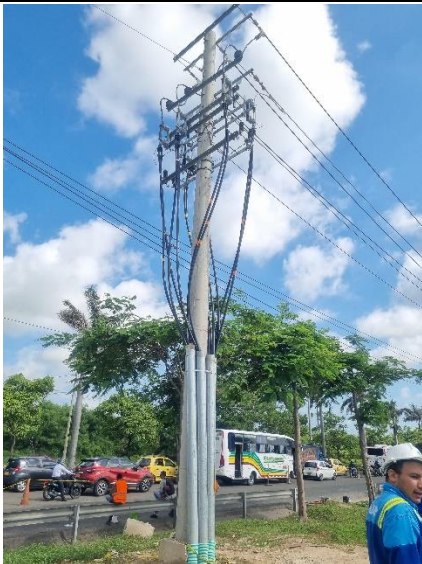
10°56'09.5"N 74°50'03.0"W, Estructura transición subterránea – aérea No 1, los dos tubos a la izquierda.
