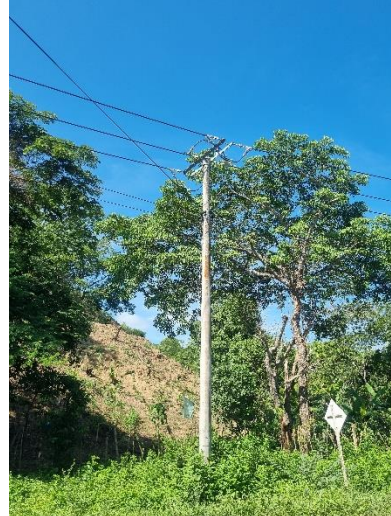
10°48'40.6"N 75°04'22.5"W, Estructura inicio tramo 2 en cable CF125.
