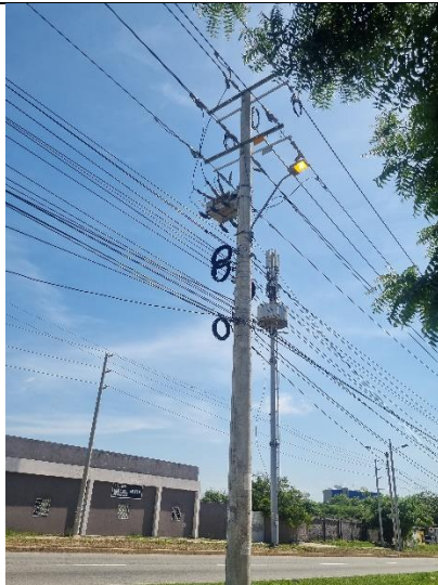
11°01'11.0"N 74°52'03.3"W, Estructura inicio tramo cable CF159.
