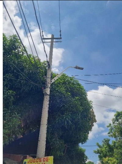
10°58'24.6"N 74°47'37.0"W, Estructura terminal tramo 1 cable CF63, 215 ml.
