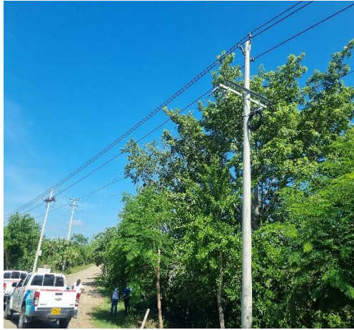
10°49'21.1"N 75°03'42.4"W, Estructura cruce bifásico en ACSR 1/0 30 ml, equivale a 20 ml trifásicos.
