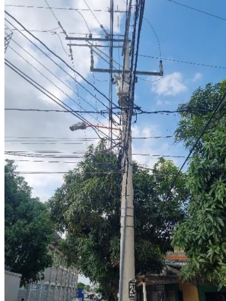
10°55'32.3"N 74°46'12.7"W, Estructura final tramo 3 en ACSR 1/0 97 metros aproximadamente.
