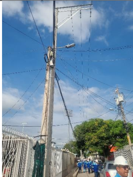
10°55'33.7"N 74°46'19.5"W, Estructura final tramo 4 en ACSR 1/0 103 metros aproximadamente.
