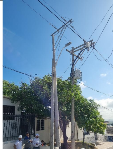
10°58'18.4"N 74°48'51.1"W, Estructura de inicio tramo No 4 en cable AAAC 123, línea bifásica
