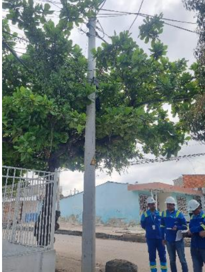
10°55'34.1"N 74°46'06.2"W, Poste de 10x1030 en baja tensión.
