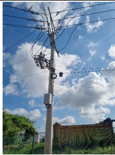
10°56'07.4"N 74°50'02.3"W, Reconector, equipo de control y comunicaciones, 3 seccionadores, 3 pararrayos.
