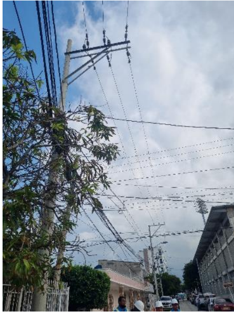
10°55'35.7"N 74°46'12.1"W, Estructura inicio tramo 3 en ACSR 1/0.
