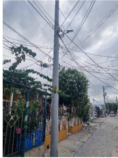
10°55'33.1"N 74°46'07.5"W, Poste de 10x1030 en baja tensión.
