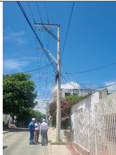
10°58'50.6"N 74°50'23.3"W, Poste de 12x1030, con tierra reportada y tres cortacircuitos.
