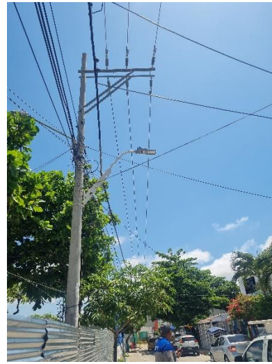
10°58'41.7"N 74°50'18.0"W, Estructura inicio tramo 7 en cable AAAC 246,6.
