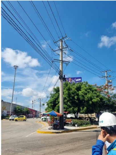
10°58'56.5"N 74°50'12.0"W, Estructura inicio tramo 3 en cable AAAC 559
