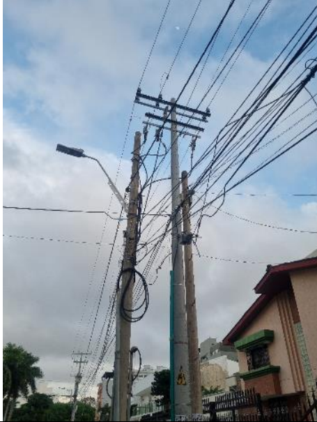
11°00'40.5"N 74°49'32.3"W, Poste de 12x735 en suspensión y tierra reportada, se requiere trasladar acometida 15 KV a Nueva estructura
