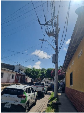
10°58'27.2"N 74°48'32.1"W, Estructura inicio tramo 1 en cable AAAC 123.
