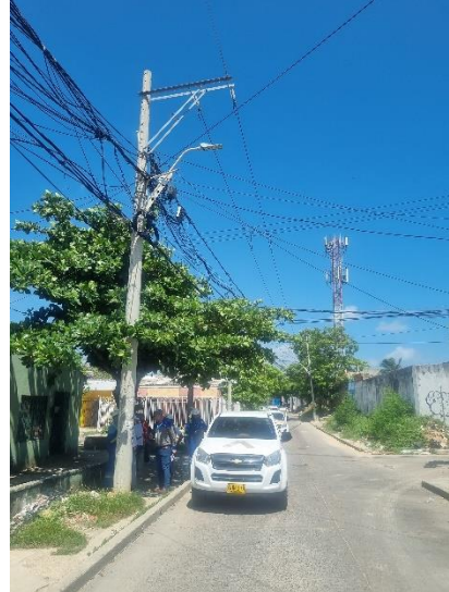
10°58'51.6"N 74°50'22.5"W , Estructura final tramo 5 en cable AAAC 246,6, línea bifásica, 460 m/m, equivale a 307 ml trifásicos
