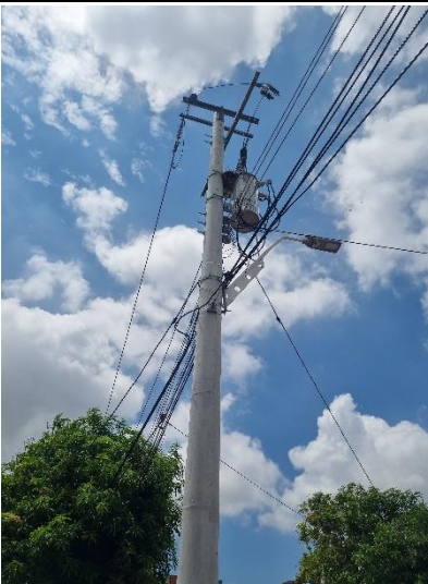
10°58'17.3"N 74°48'14.5"W, Estructura inicio tramo 1 cable CF63, línea bifásica.
