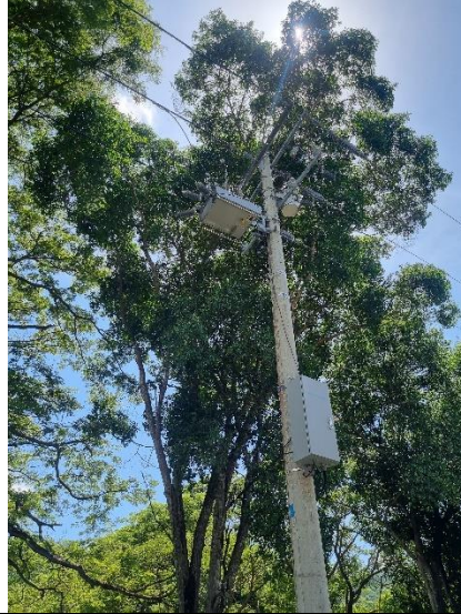
10°48'38.6"N 75°06'14.0"W, Estructura inicio tramo 4 en cable CF125.
