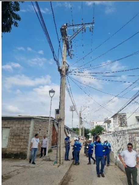
10°55'33.1"N 74°46'17.1"W, Estructura inicio tramo 4 en ACSR 1/0.
