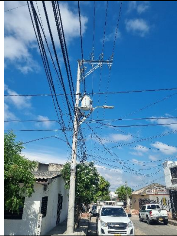
10°58'27.2"N 74°48'32.1"W, Estructura final tramo 1 en cable AAAC 123, 420 ml.
