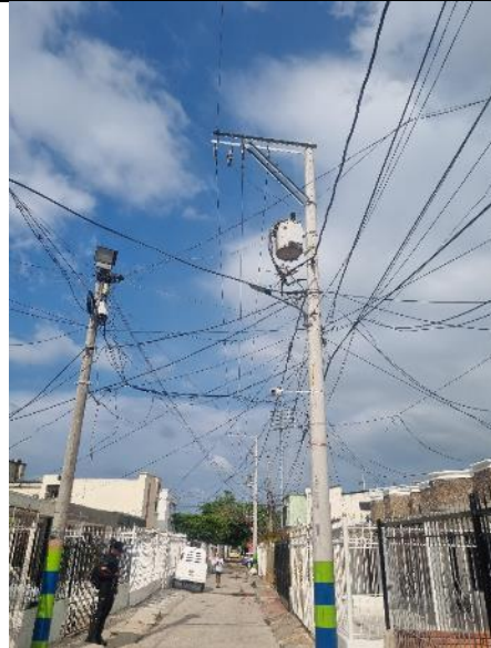
10°55'36.7"N 74°46'20.1"W, Estructura inicio tramo No 1 en ACR 1/0.
