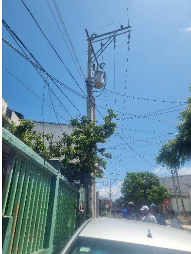
10°58'48.5"N 74°50'22.8"W, Estructura final tramo 6 en cable AAAC 246,6, 180 ml, poste de 12x1030 y tierra reportada
