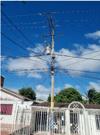
Estructura terminal tramo No 3 en cable AAAC 123, 240 ml
