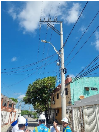
10°58'50.4"N 74°50'11.6"W, Estructura inicio tramo 4 en cable AAAC 246,6, poste de 12x130, tierra reportada y 3 cortacircuitos.
