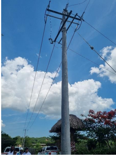
10°48'37.6"N 75°07'14.6"W, Estructura inicio tramo 5 en cable CF125 y poste de 12x1324.
