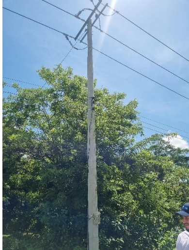
10°48'38.2"N 75°06'30.3"W, Poste de 12x1324 en retención.
