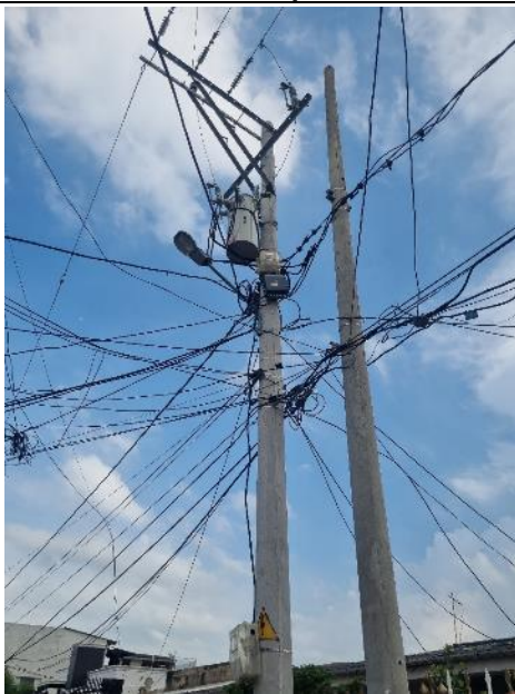
10°55'33.3"N 74°46'09.1"W, Estructura inicio tramo 2 en ACSR 1/0.
