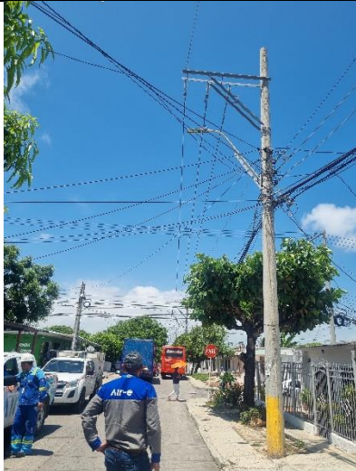
10°58'51.1"N 74°50'18.0"W Estructura final tramo 7 en cable AAAC 246,6, 295 ml
