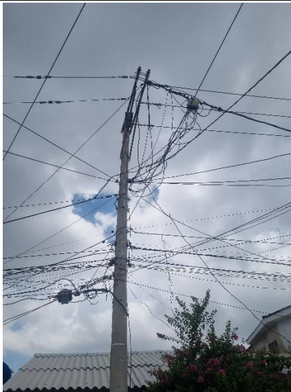
10°58'00.5"N 74°48'28.9"W, Estructura inicio tramo 3 en conductor CF63.
