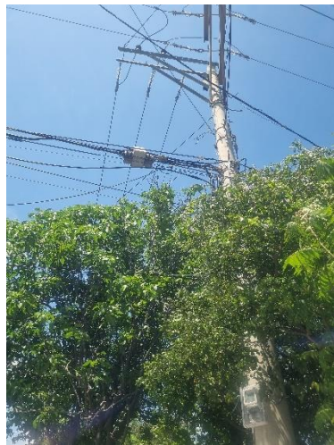
10°58'54.2"N 74°50'23.7"W Estructura inicio tramo 6 en cable AAAC 246,6.
