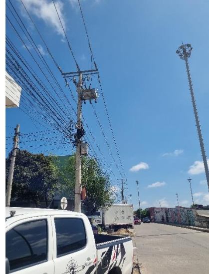
10°58'52.7"N 74°50'10.8"W, Estructura final tramo 3 en cable AAAC 559, 180 ml
