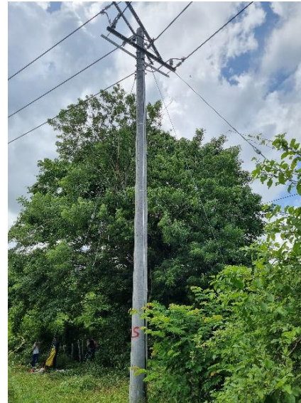
10°48'40.2"N 75°04'24.6"W Poste 12 x 1324, Estructura doble terminal, termina tramo cable ecológico -600 metros
