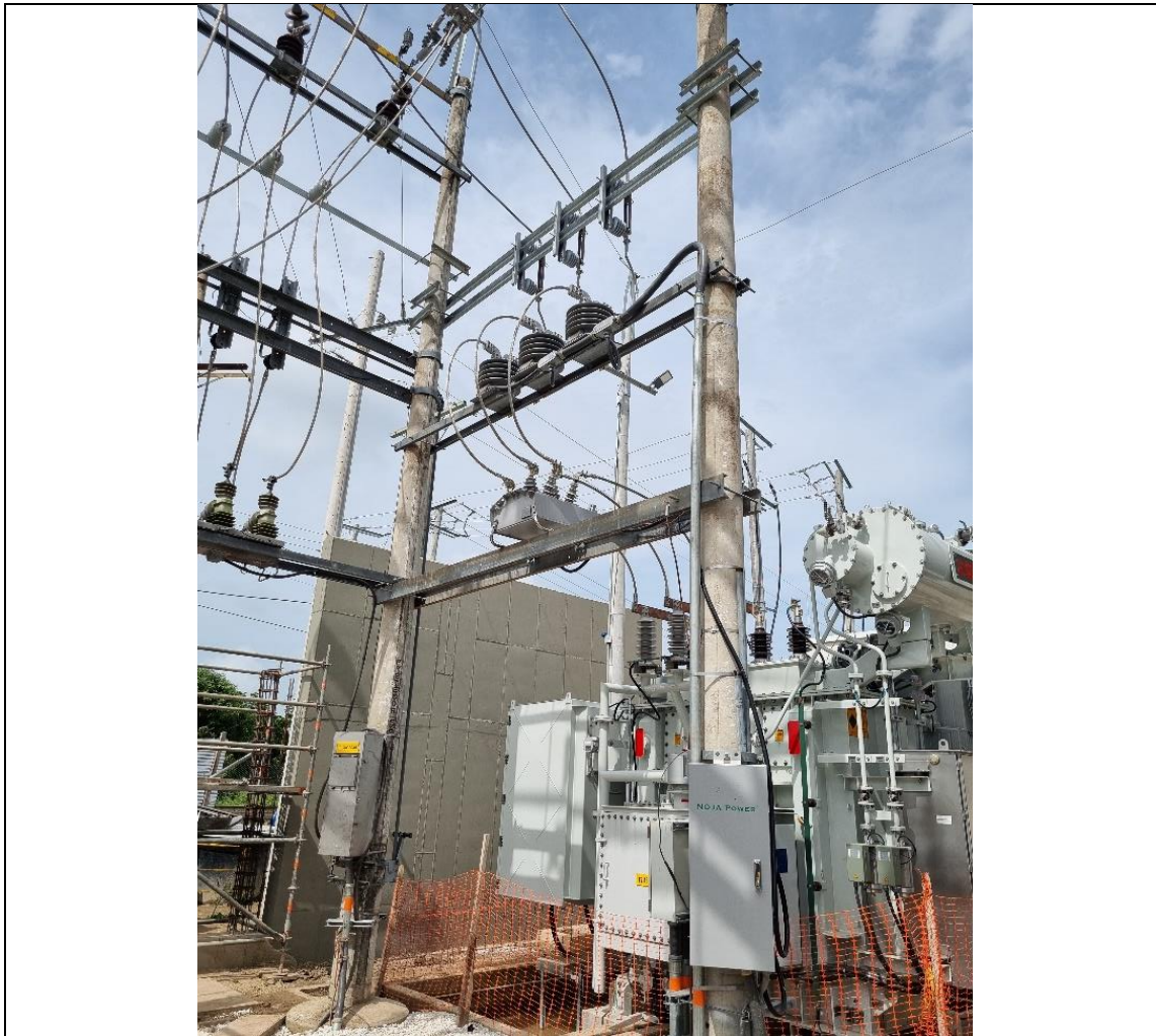
Bahía de línea – subestación Reducida N2S7
