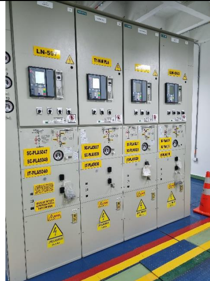
Control subestación tipo 4, control y protección bahía línea N3- N3P1, Control y protección bahía de transformador N3 - N3P2, Gabinetes de llegada – salida sub interior SF6 barra sencilla -N3S61
