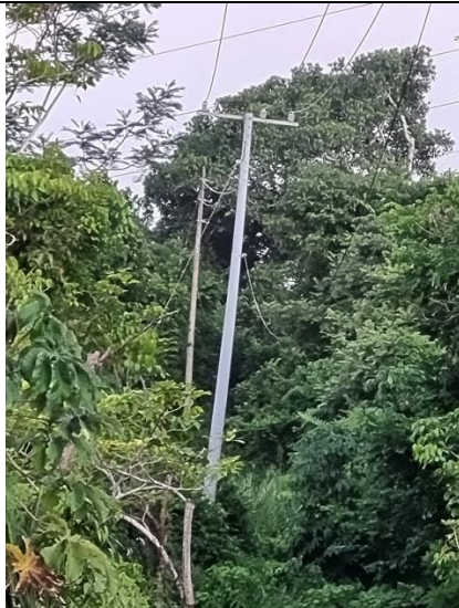
Poste 12 metros fibra
