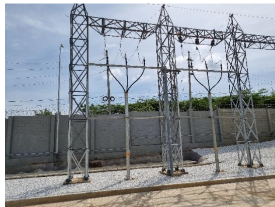
Transición aérea – subterránea N3- N3EQ9, Cables de salida de circuito N3S62
