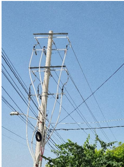
Estructura de arranque circuito en subestación
