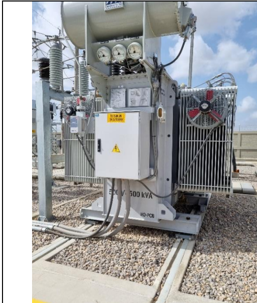
11°43'01.3"N 72°17'12.0"W Transformador trifásico 6500 kVA
