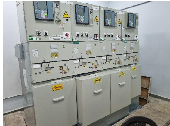
Control subestación tipo 4 – Módulo común bahía tipo 4 interior N3S37- Gabinete llegada o salida interior SF6 barra sencilla N3S61
