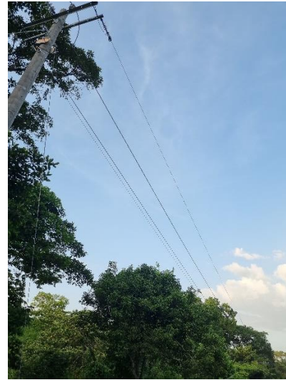
Cambio línea del centro, AAC 312,8 - 350 metros
