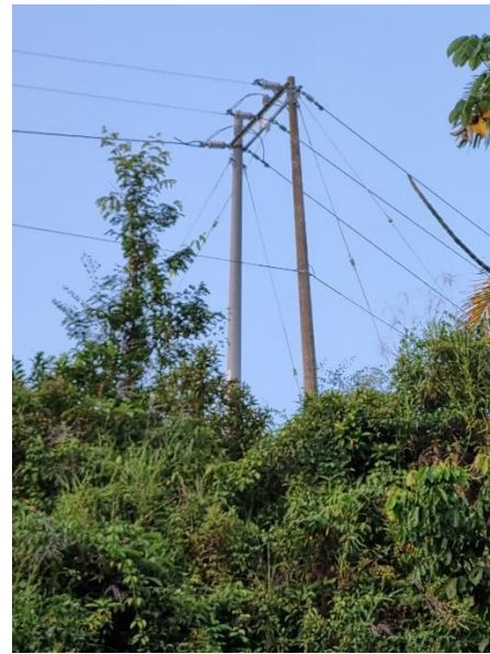
11°12'54.1"N 73°24'03.2"W Estructura doble terminal termina tramo 312,8 AAC -700 metros Poste 12 metros en fibra
