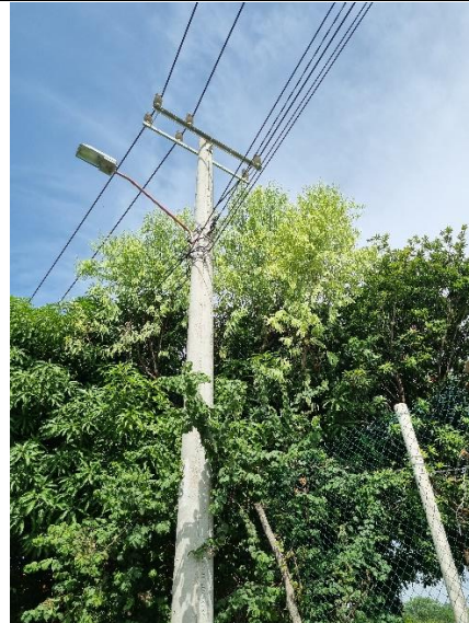
Tramo cable ecológico 336 Kcmil
