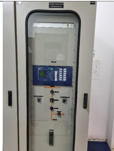
Control y protecciones bahía de línea- N3
