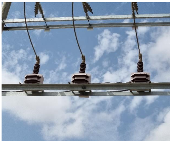
Transformadores de tensión N3
