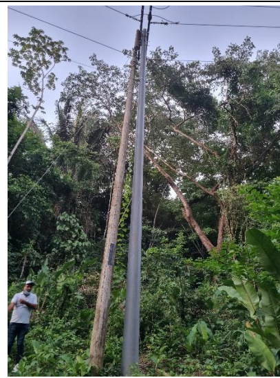
Poste 12 metros fibra
