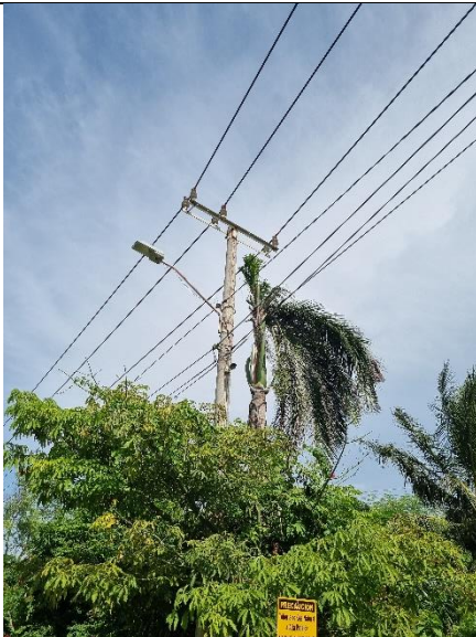
11°00'46.8"N 74°53'23.1"W Estructura fin cable 336 Kcmil - 1200 metros tramo 1 y arranque tramo 2
