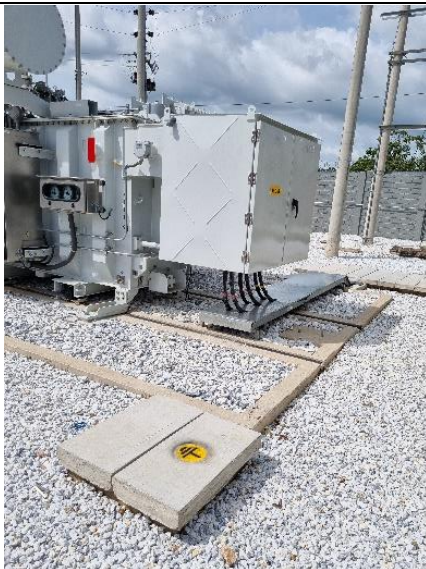
Cables de llegada transformador – N2S14
