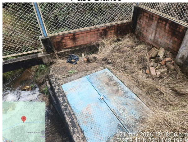
Imagen 26. Cámara lateral captación quebrada Paso Blanco
