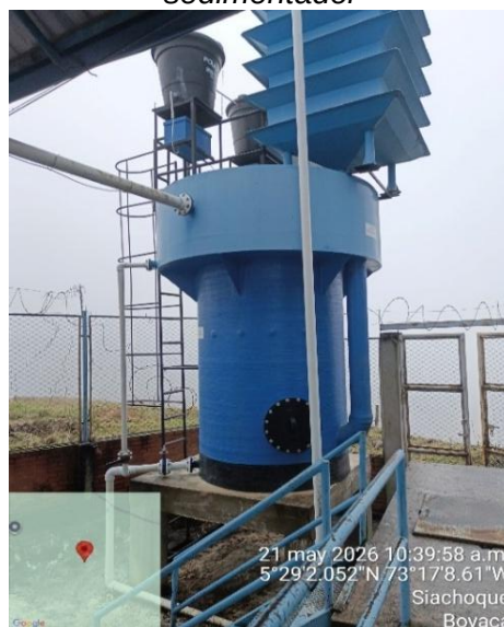
Imagen 31. Torre de aireación floculador y sedimentador
