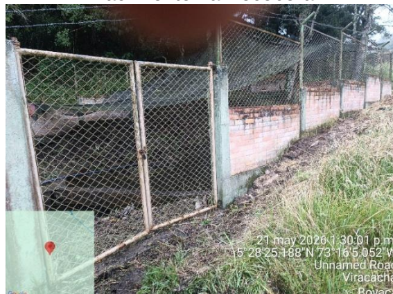
Imagen 43. Encerramiento captación Nacimiento La Recebera
