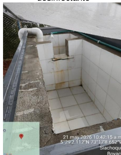
Imagen 33. Tanque para la dosificación de desinfectante
