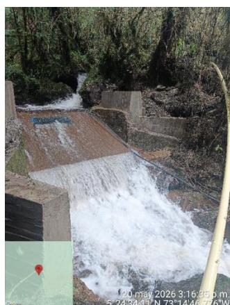
Imagen 35. Bocatoma quebrada La Isla
