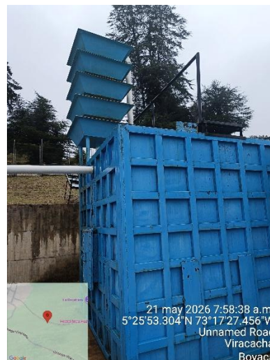
Imagen 17. Tanques de filtración
