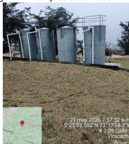
Imagen 24. Tanques de almacenamiento
