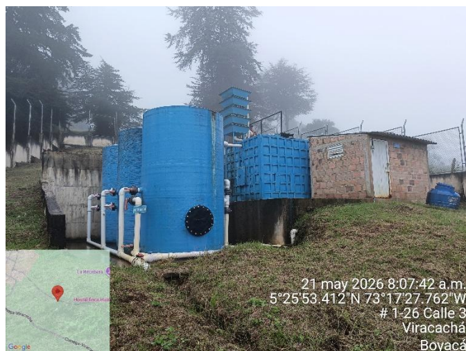
Imagen 16. Cámara de mezcla rápida y floculador – sedimentador
