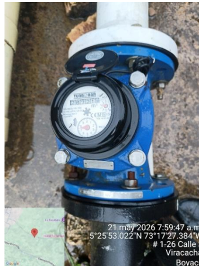
Imagen 23. Macromedidor entrada a PTAP fuera de operación
