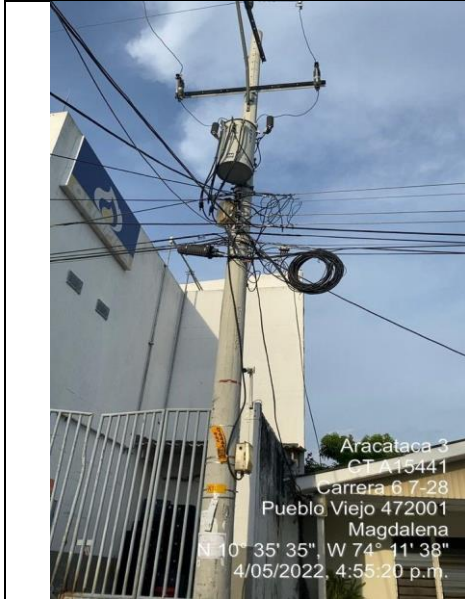
Transformador y protecciones
