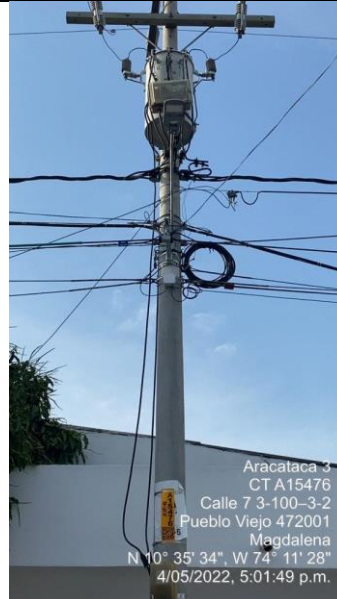
Transformador y protecciones
