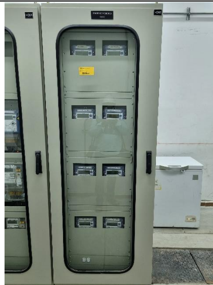
Celda de medidas N2
