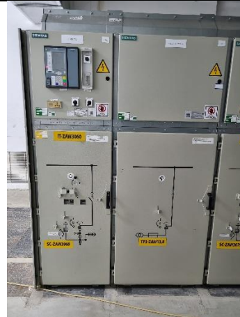
Control -protección Bahía N2 y medida en celda remonte N2
