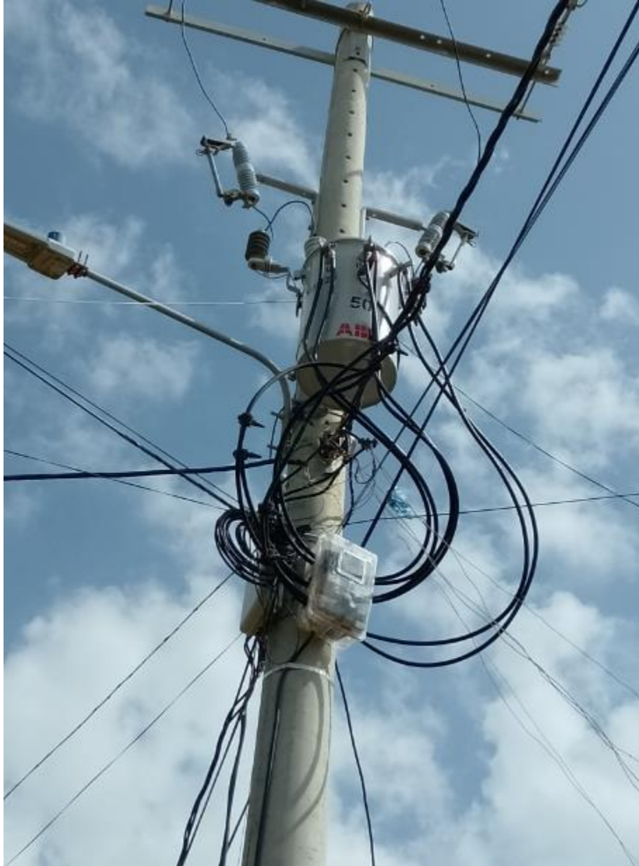
Nuevo Horizonte sec. 02 Totalizador - Riohacha
