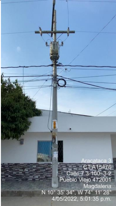
Transformador y protecciones
