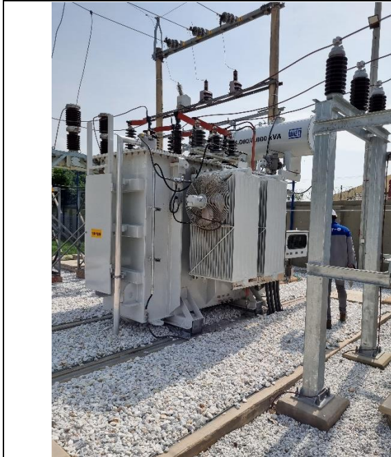
Nuevo transformador 8 MVA
