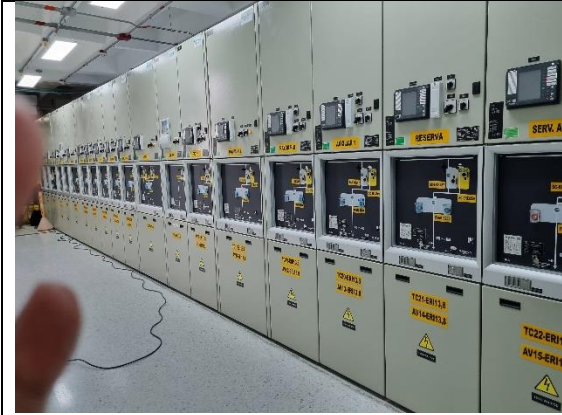
Celdas salida 13,8 KV
