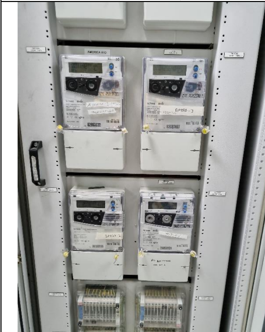
Celda de medidas N2
