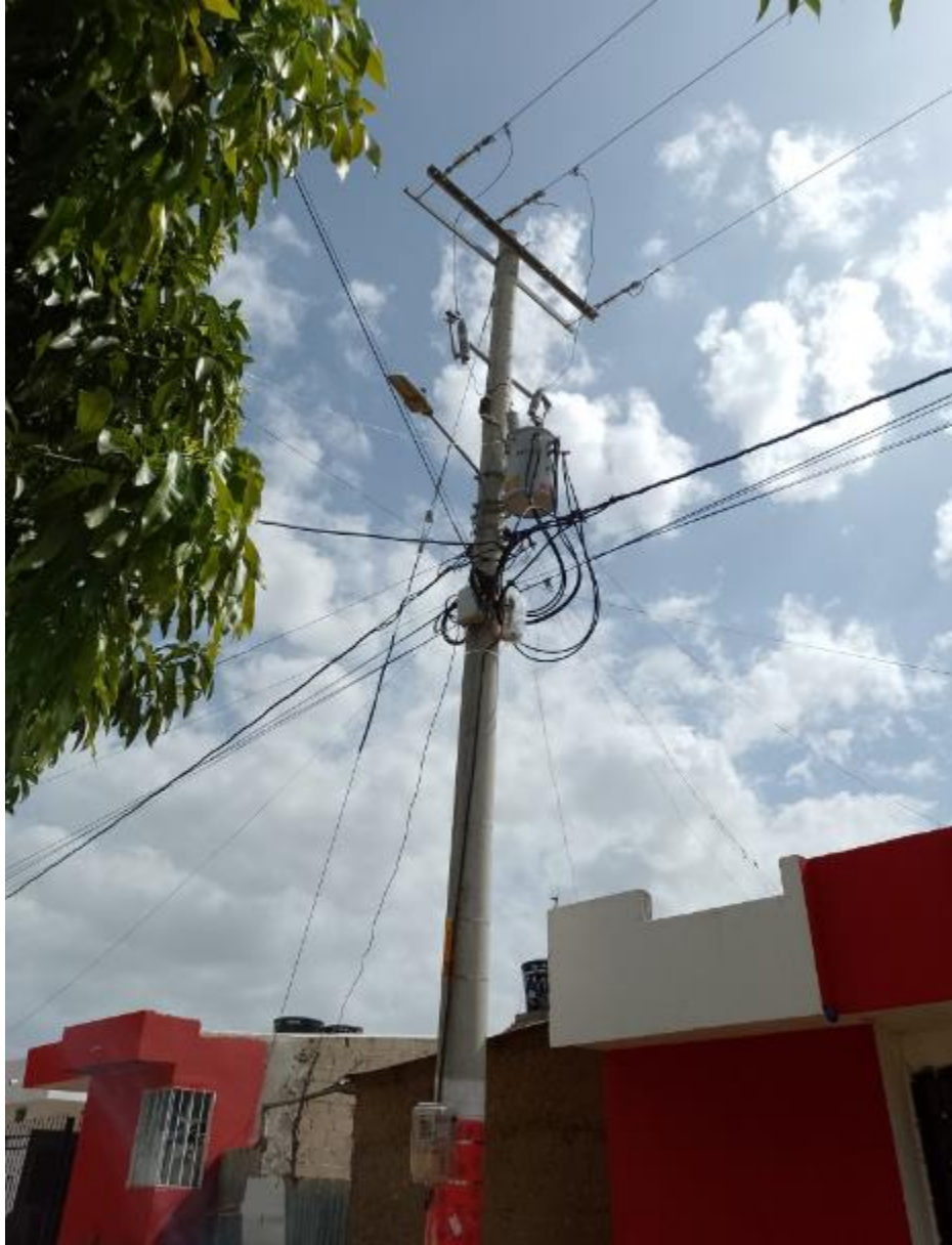
Nuevo Horizonte sec. 02 Totalizador - Riohacha
