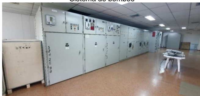
Sistema electrónico del bombeo
