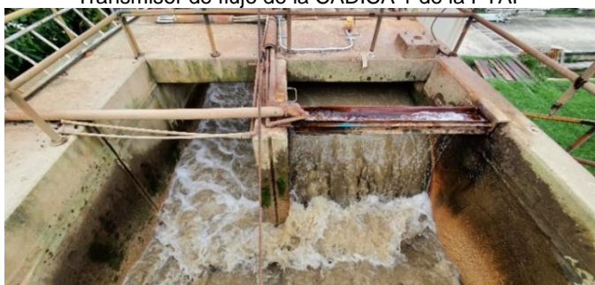
Punto de dosificación de coagulante y mezcla rápida
