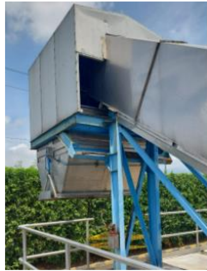
Tolva de la rejilla gruesa
