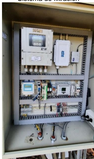
Transmisor de flujo de la salida Sur de la PTAP Río Cauca
