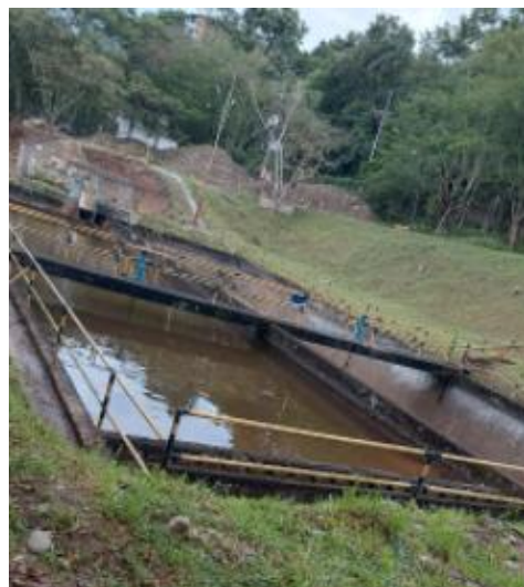
Imagen 20. Desarenador PTAP Río Cali
