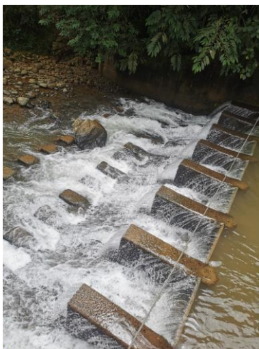
Bocatoma lateral y estructura de disipación de energía
