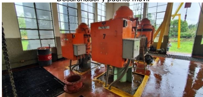
Sistema de bombeo
