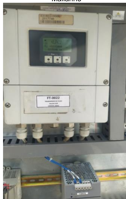
Transmisor de flujo a la salida Sur de la PTAP Puerto Mallarino
