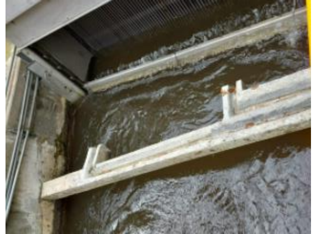
Punto dosificación cal primaria
