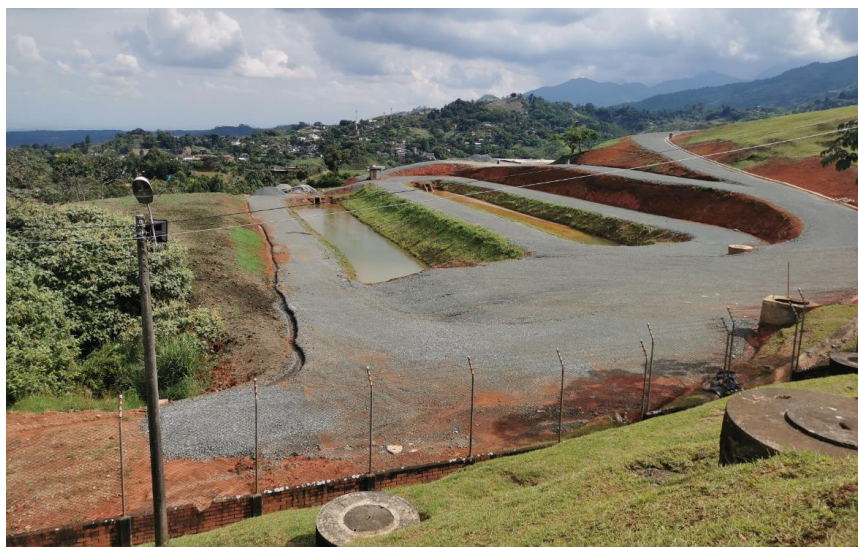
Imagen 36. Tratamiento de lodos generados en la PTAP La reforma
