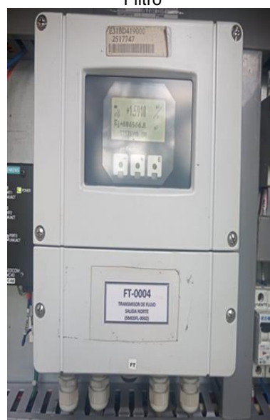
Transmisor de flujo a la salida Norte de la PTAP Puerto Mallarino
