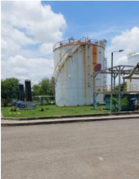
Tanque de almacenamiento de biogás
