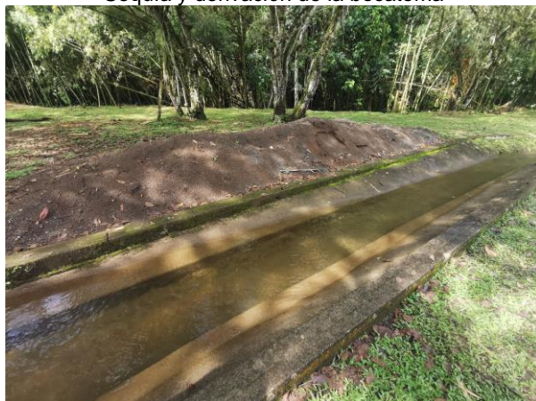
Desarenador y disposición de arenas
