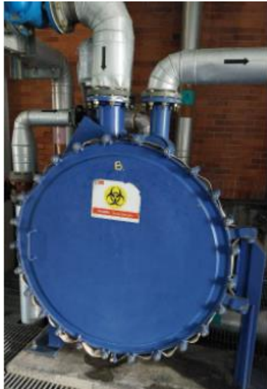
Sistema de calentamiento Digester anaerobio
