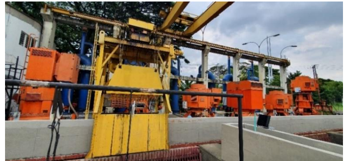
Sistema de bombeo
