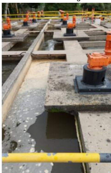
Cámaras de floculación
