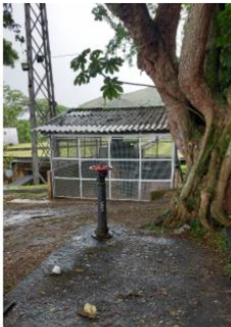
Imagen 22. Planta diésel de energía respaldo
