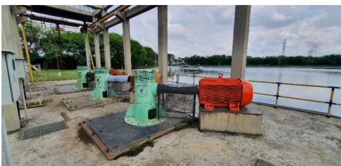
Estación de bombeo hacia la cámara presurizada
