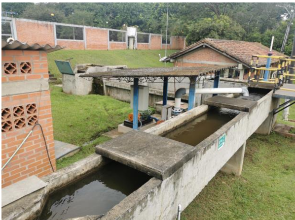
Entrada a PTAP
