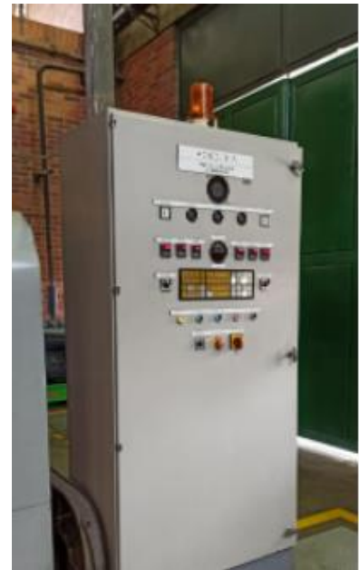
Panel de control generador 1
