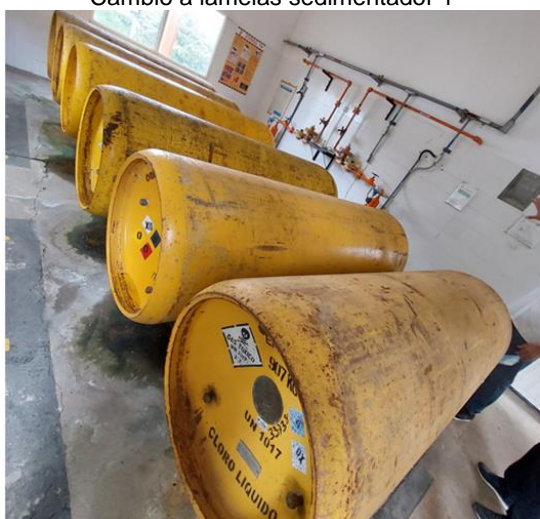
Tanques de cloro líquido
