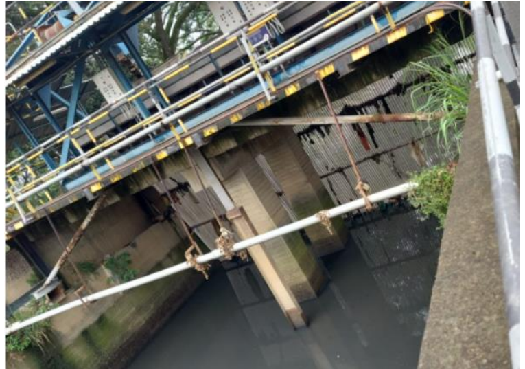
Sistema de retención de sólidos canal 1
