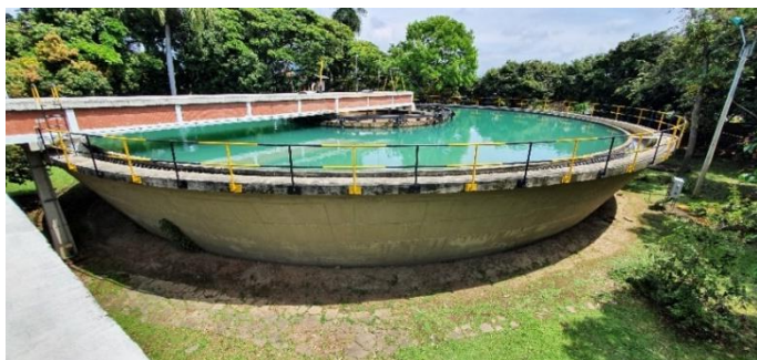
Reactor de manto de lodos
