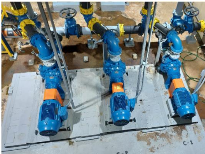
Bomba de lodos
