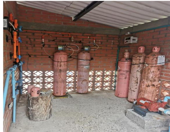
Caseta de almacenamiento de cloro
