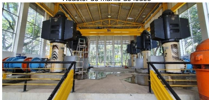
Estación de bombeo de agua tratada
