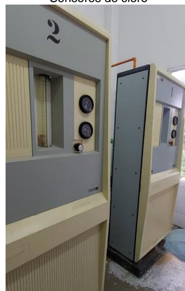
Clorinador 1 y 2 (post cloración)
