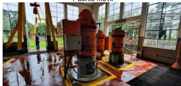
Sistema de bombeo
