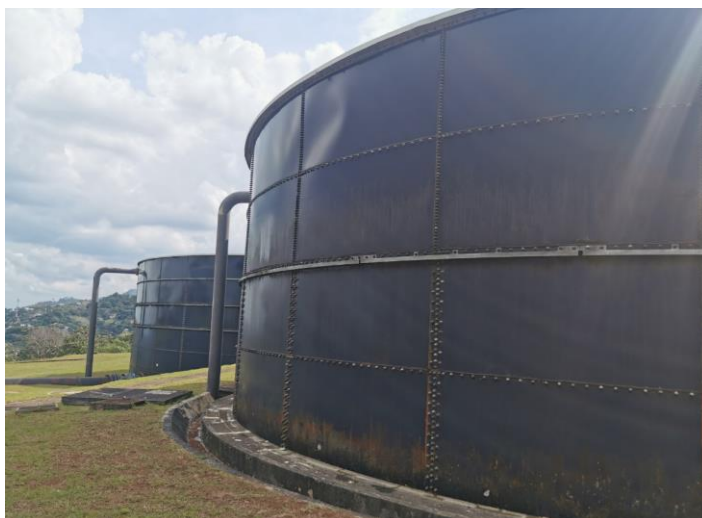
Imagen 37. Tanques de almacenamiento en la PTAP La reforma
