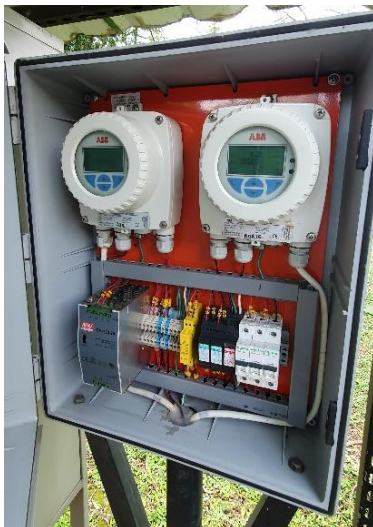
Transmisores de flujo a la entrada de la PTAP Río Cauca
