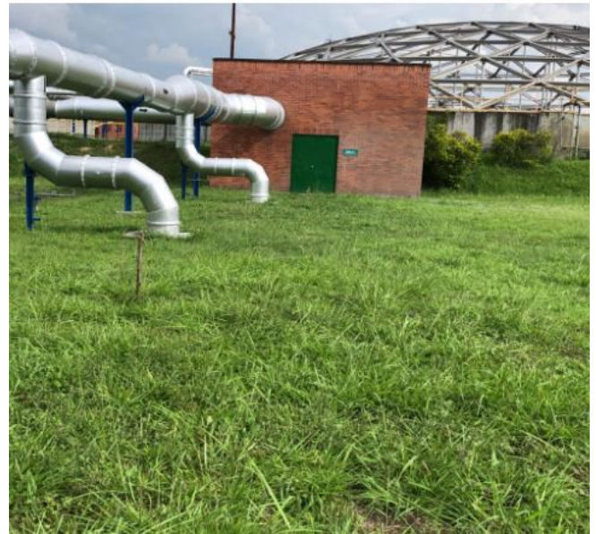
Soil Bed Sedimentadores
