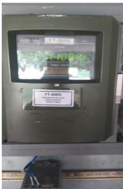
Transmisor de flujo a la salida Oriente de la PTAP Puerto Mallarino
