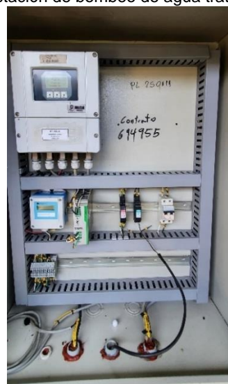
Transmisor de flujo de la salida Norte de la PTAP Río Cauca
