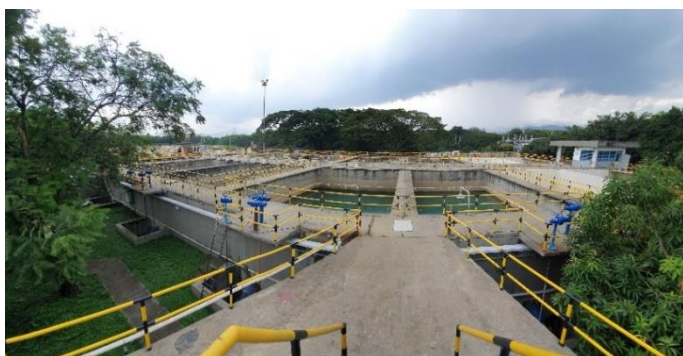
Sistema de filtración
