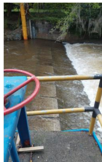
Captación de Fondo
