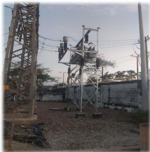
Imagen No. 17 Instalación del banco de condensadores Línea 534 de 6 MVAR SE Mompox - Bolívar
