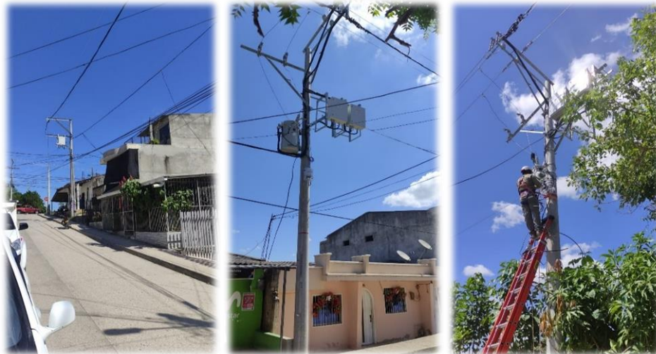
Imagen No. 46 Proyecto de medición Avanzada y aseguramiento de red en Sincelejo, Sucre
