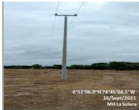
Circuito La Solera - 1,40 Kms de Red Intervenidos
