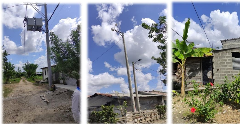
Imagen No. 45 . Proyecto de medición Avanzada y aseguramiento de red en Montería, Córdoba
