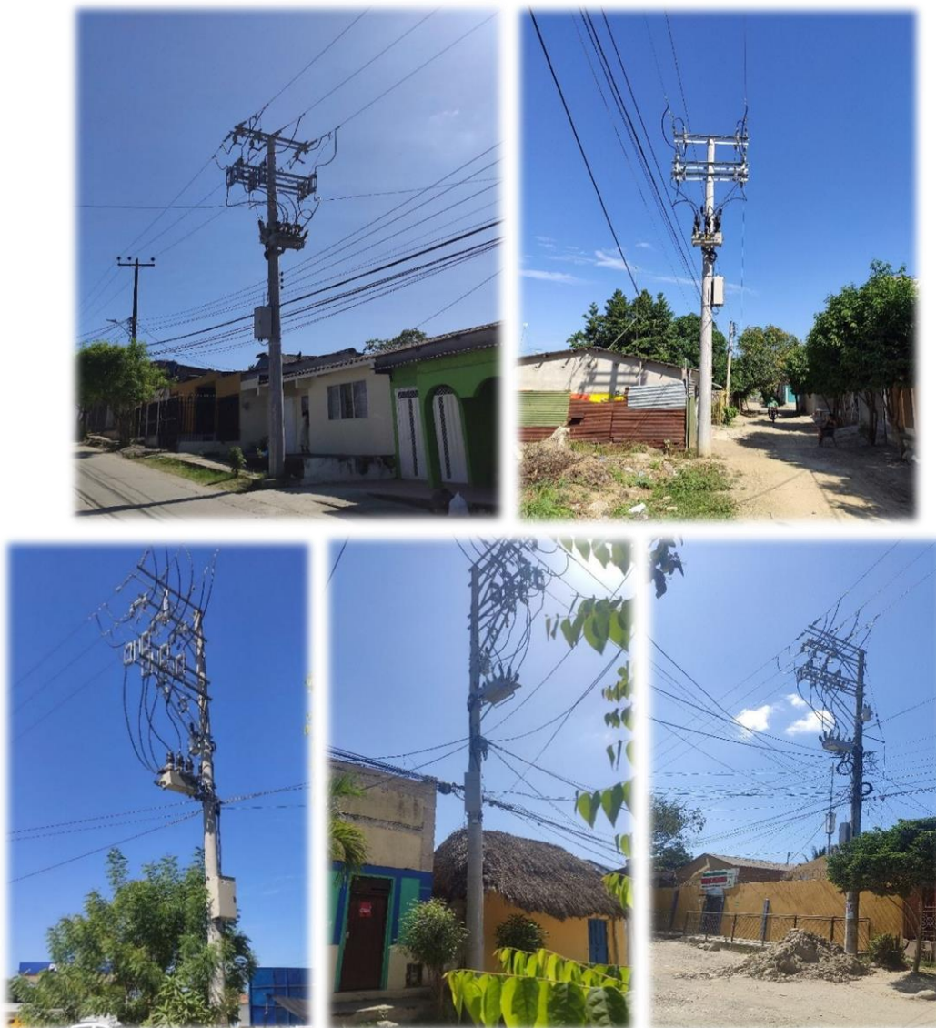
Imagen No. 5. Nuevos reonectadores (10702, 10704, 10705, 10706, 10707) en los circuitos Corozal 01 y 02
