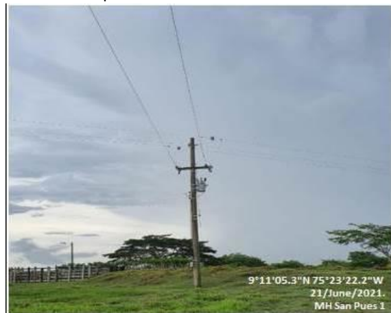
Circuito Sampués 1 - 0,80 Kms de Red Intervenido
