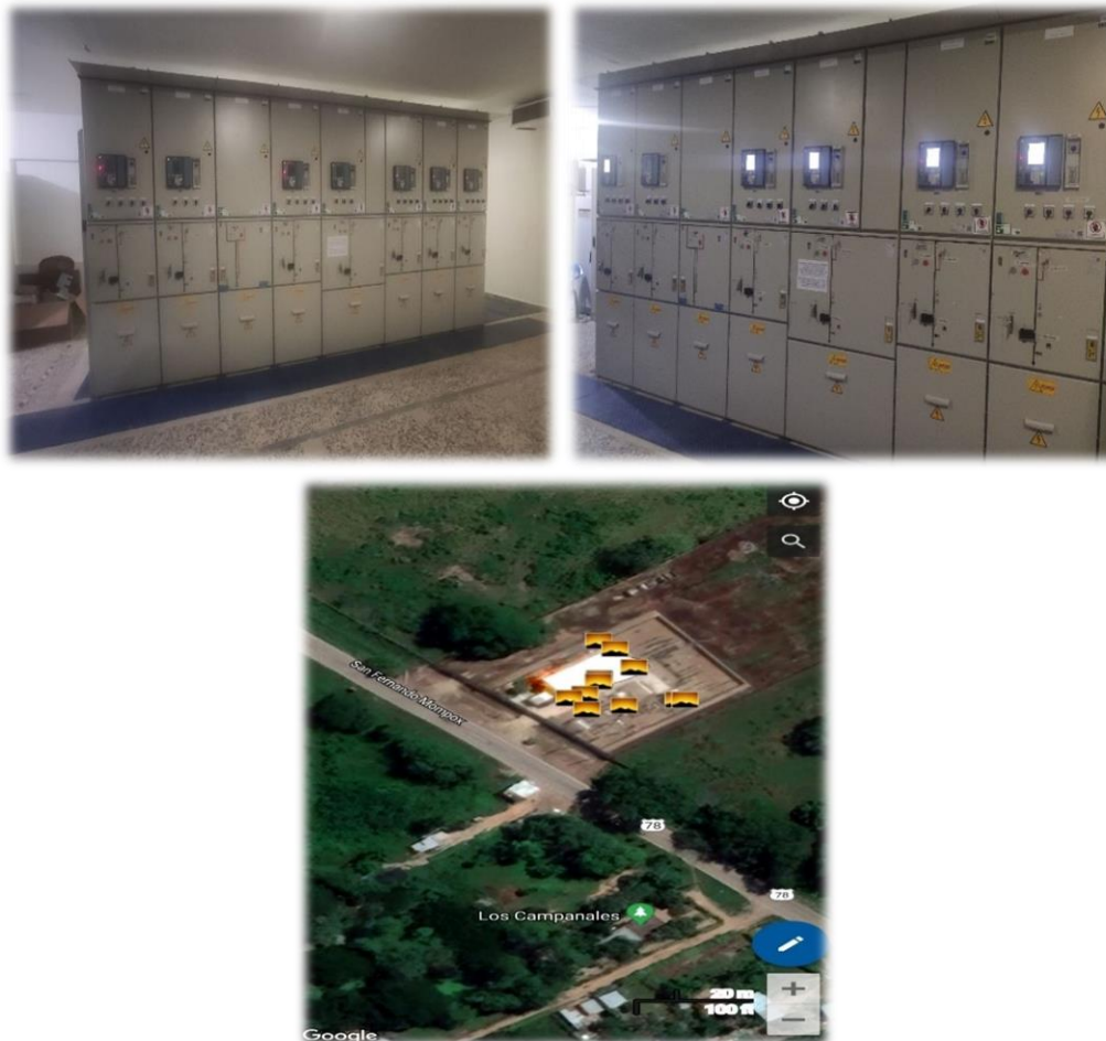
Imagen No. 9 Celdas nuevas a 13,8 V al interior de la subestación Mompox
