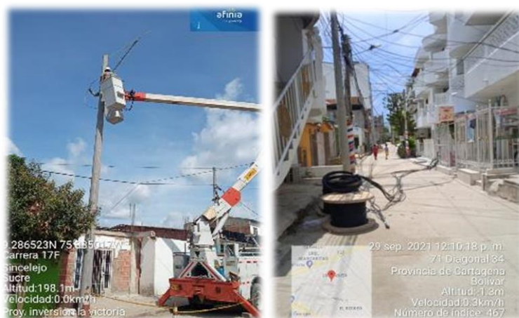
Imagen No. 38 Avance proyecto de aseguramiento de red en Sincelejo, Sucre.
