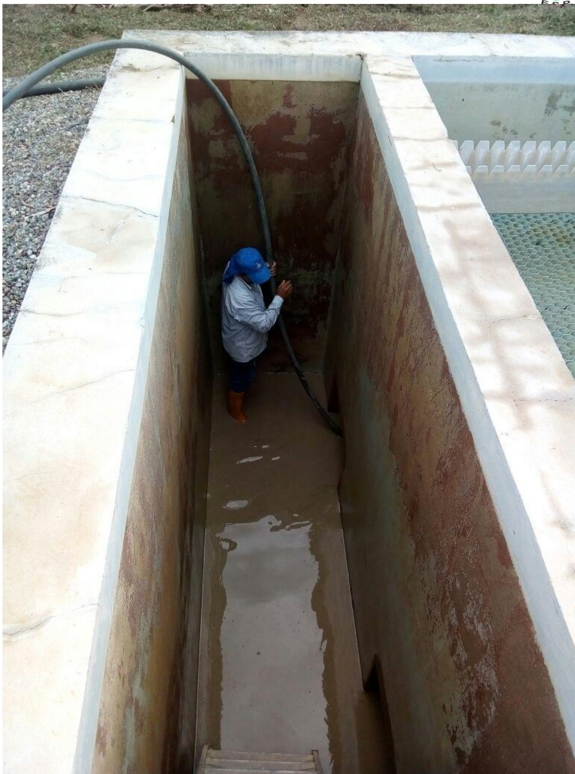
Lavado de un modulo del sedimentador
