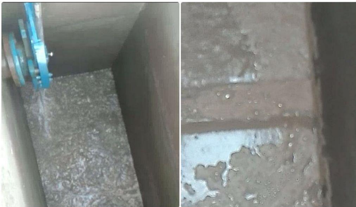
Lavado de filtros
