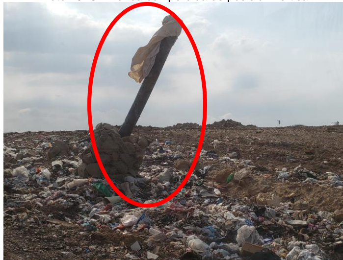
Foto 16. Chimenea con pérdida de posición vertical
