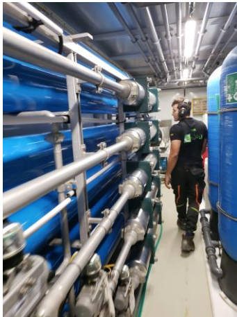
Foto 17. Planta de tratamiento
