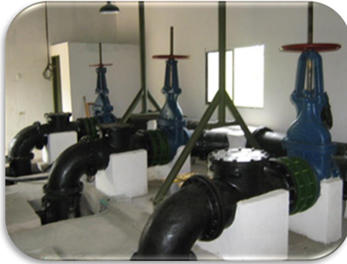
Conjunto Motores-bomba Ebar Venecia
