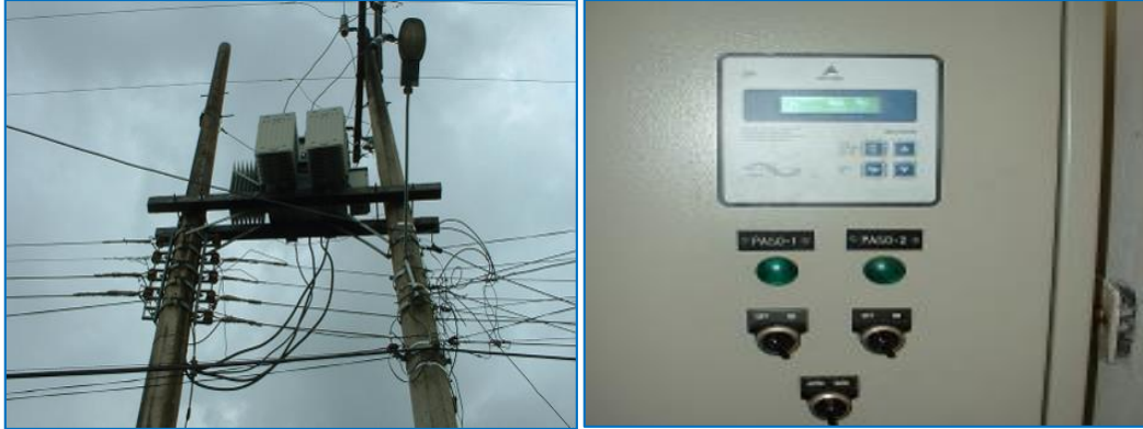
Sistema Eléctrico Ebar el Milagro
