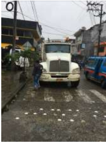
Ilustración 7. Compactador con placas OET 400. No cuenta con logos que permitan identificarlo como parte AGUAS NACIONALES EPM S.A. E.S.P. Fuente: Visita de inspección y vigilancia del 06, 07 y 08 de junio de 2017
