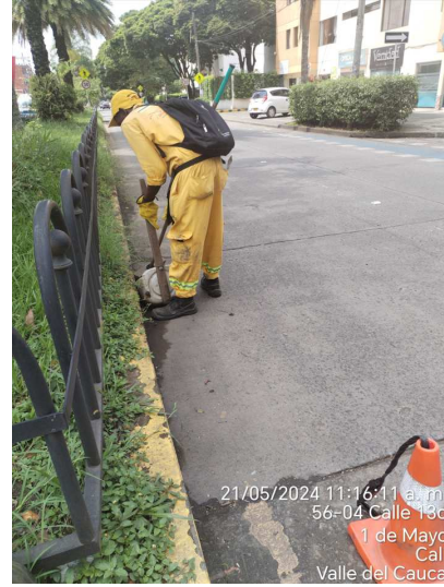
Foto 53. Operario y elementos de la microrruta 05
