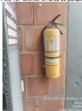
Foto 15. Extintor en área de parqueo
