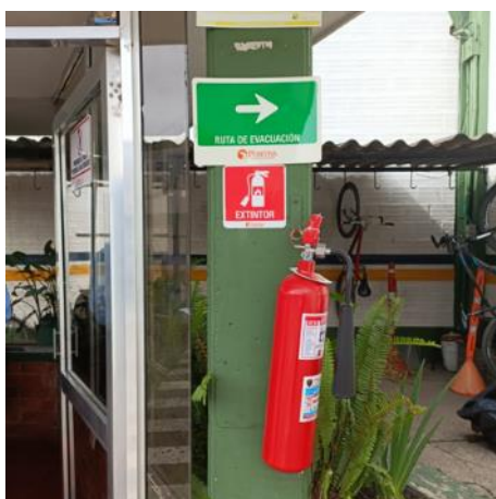
Señalización de circulación y extintor
