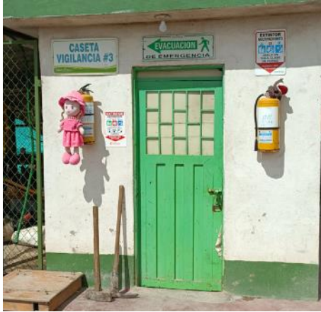
Extintores en el sitio de disposición final.
