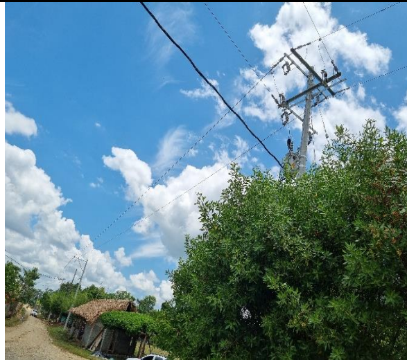
8°42'39.3"N 76°15'13.1"W Estructura fin tramo AAAC 1/0 aproximadamente 5,7 kilómetros, e inicio 0,3 kilómetros en 2 hilos 1/0, El limón
