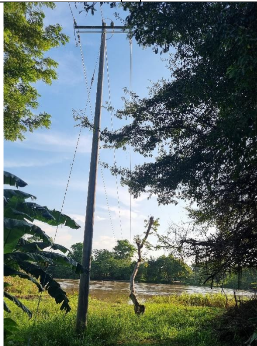
8°55'14.6"N 75°51'17.2"W, Estructura terminal cable ecológico, 2,4 kilómetros, cruce de río.
