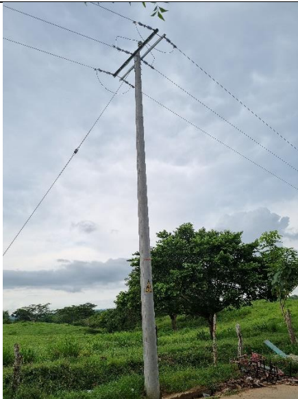
8°57'06.4"N 75°27'29.2"W Estructura inicio AAAC 123 Aproximadamente 560 metros
