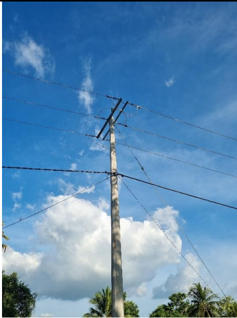
8°55'25.7"N 75°50'27.7"W, Estructura terminal cable AAAC 123, 1 kilómetro e inicio tramo cable AAAC 4/0
