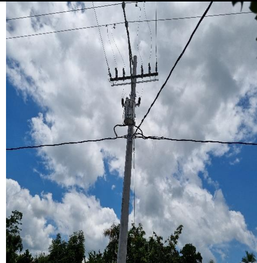
8°41'19.3"N 76°15'37.4"W Estructura Red trenzada, aproximadamente 1,2 kilómetros red trenzada.
