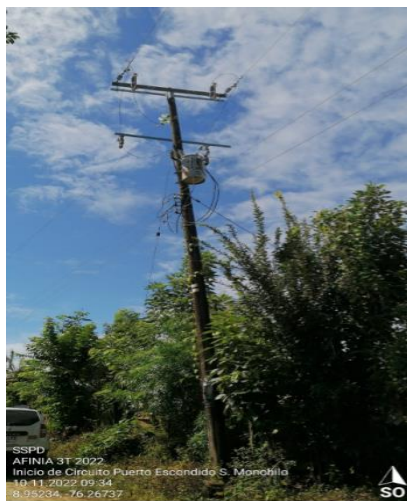
Estructura Cambio de red monohilo – Municipio Puerto Escondido – Departamento de Córdoba
