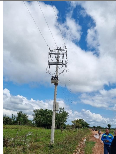
9°08'49.2"N 74°13'19.7"W Estructura terminal tercer tramo 1/0 desnudo.
