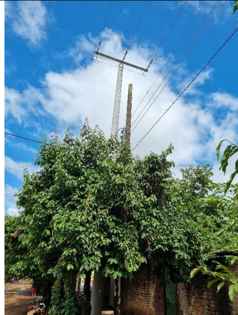
9°08'56.5"N 74°13'34.9"W, Estructura terminal 2do tramo cable desnudo 1/0
