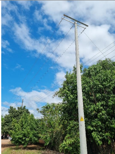
9°08'41.8"N 74°13'18.8"W, Estructura 2do tramo cable desnudo 1/0
