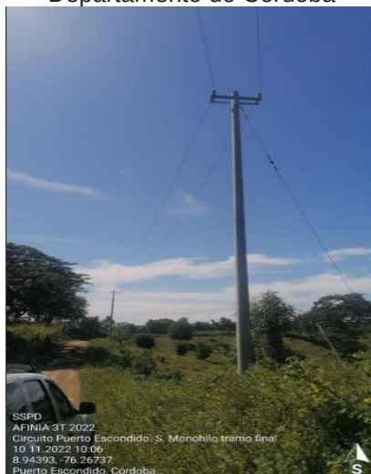
Circuito Sustitución Monohilo Ejecución Tercer Trimestre
