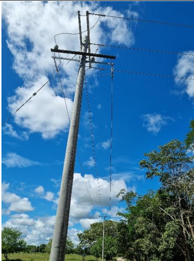
8°43'04.6"N 75°56'44.1"W, estructura intermedia cambio a cable 4/0
