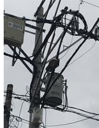
Transformador Villa Cielo Fuente: Visita SSPD
