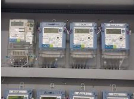
Medida Centralizada Chambacú Fuente: Visita SSPD
