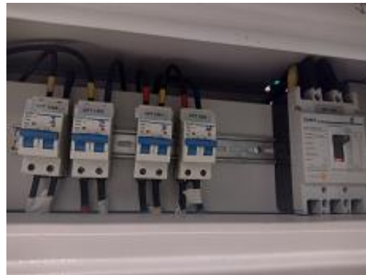
Protecciones y elementos de corte edificio Bambú 320 – piso 15 Fuente: Visita SSPD
