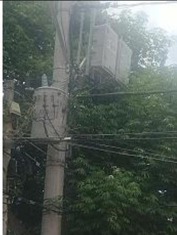
Transformador y concentradores de medida Candelaria Fuente: Visita SSPD
