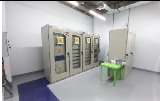
Celdas de control y protecciones
