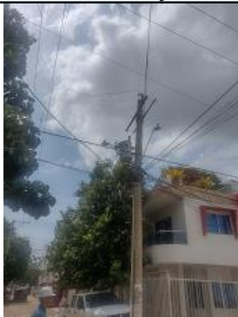
Transformador y redes sector Navas Meisel Fuente: Visita SSPD
