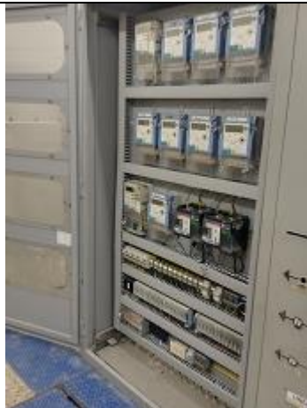
Medida Centralizada Chambacú Fuente: Visita SSPD
