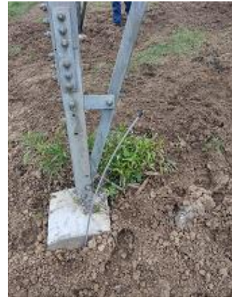
Torre 13 sin conexión al SPT Fuente: Visita SSPD
