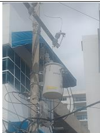
Transformador y medida centralizada Providencia Fuente: Visita SSPD
