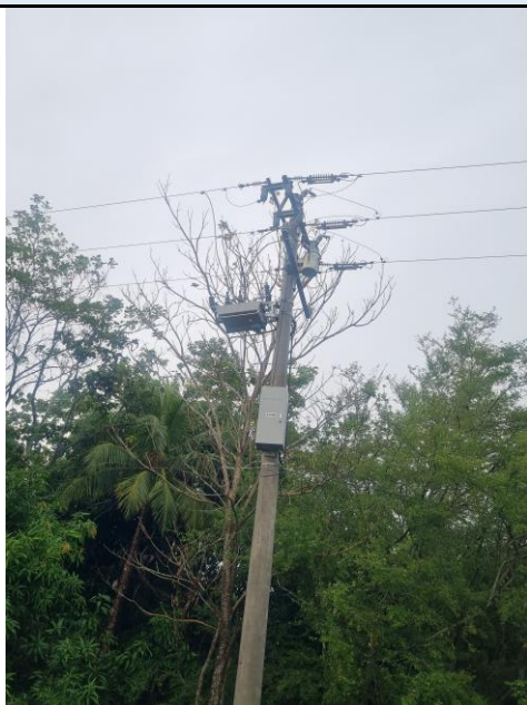
8°38'02.8"N 75°23'30.9"W, Estructura inicio tramo 3, cable AAAC 123
