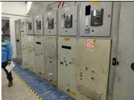
Celdas a cambiar 2024 Chambacú Fuente: Visita SSPD
