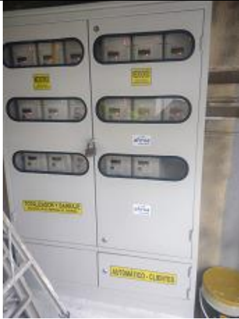
Armarios de medida edificio Zarzuela Fuente: Visita SSPD
