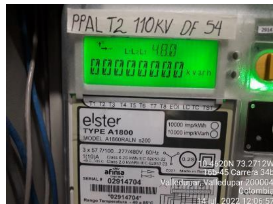
Reposición Medidor N4 – SE VALLEDUPAR-CESAR Fuente: AFINIA
