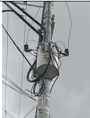
Transformador Olaya Herrera – sector puntilla Fuente: Visita SSPD
