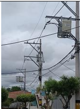
Acometidas Villa Cielo Fuente: Visita SSPD
