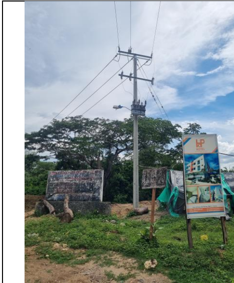
9°23'16.3"N 75°31'58.0"W, Estructura inicio tramo conductor CF125, estación de rebombeo Varsovia.
