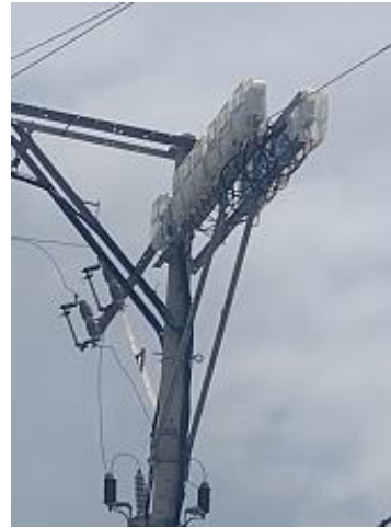
Medida Centralizada Pozón Fuente: Visita SSPD
