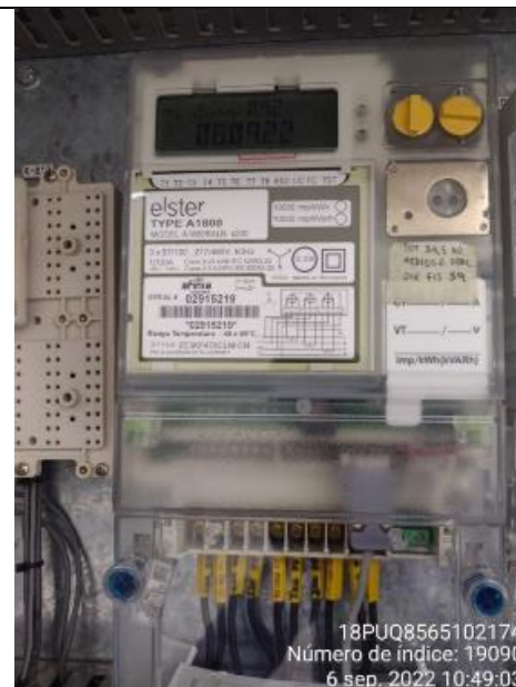
Reposición Medidor N3 – SE TIERRALTA-CORDOBA NORTE Fuente: AFINIA
