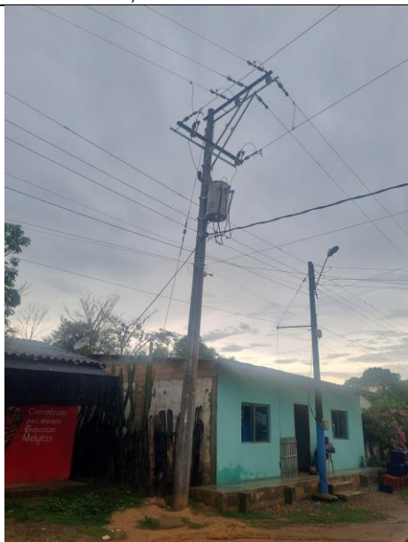
8°38'43.0"N 75°21'50.4"W, Estructura inicio tramo 4, en cable AAAC 123
