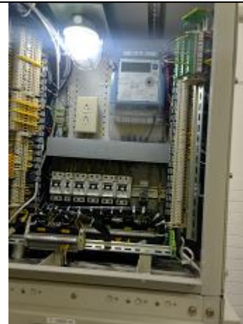
Medida Centralizada Chambacú Fuente: Visita SSPD
