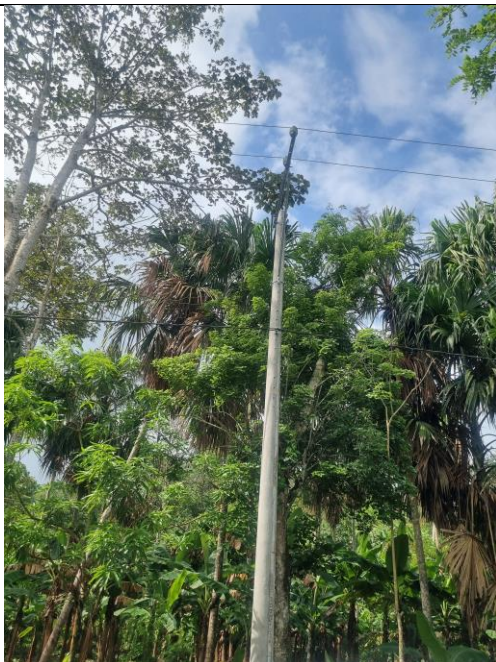
Estructura intermedia, aproximadamente 350 metros red trenzada baja tensión
