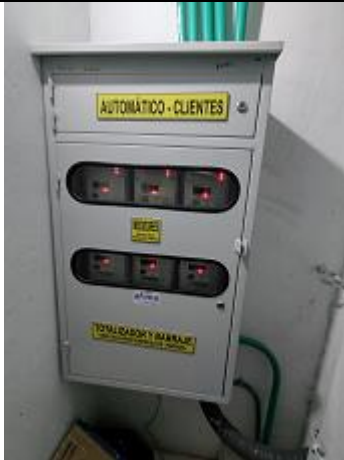
Armario medida edificio Bambú 320 – piso 17 Fuente: Visita SSPD
