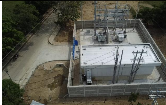
Foto panorámica subestación
