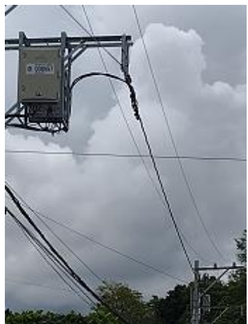
Medida Centralizada Villa Cielo
