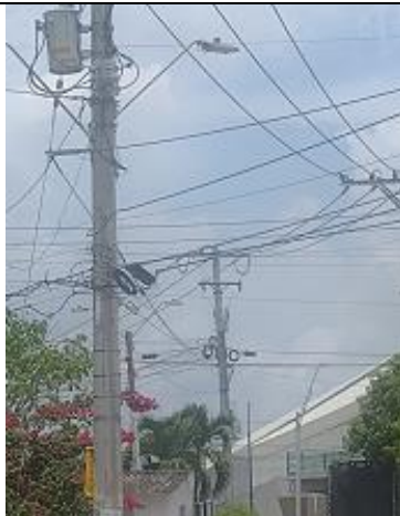
Transformador Portal de la Cordialidad Fuente: Visita SSPD
