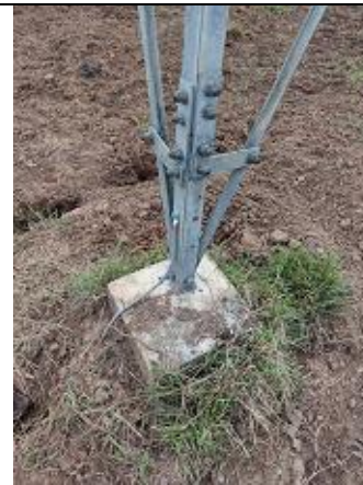
Torre 15 conexión SPT – Visita SSPD
