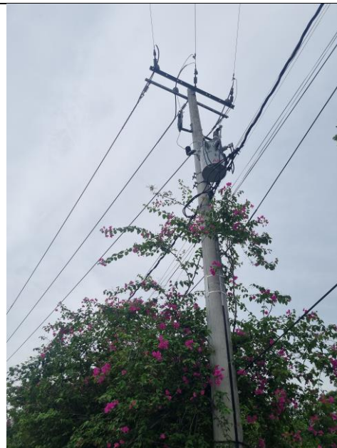
9°20'01.7"N 75°32'31.2"W, Estructura Final, 6,5 kilómetros de red.
