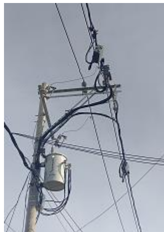
Transformador Mocari Fuente: Visita SSPD
