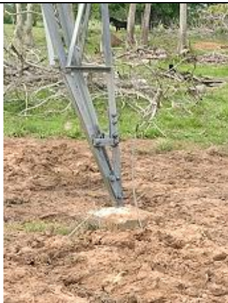
Torre 11 sin conexión al SPT Fuente: Visita SSPD
