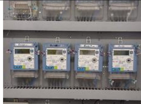
Medida Centralizada Chambacú Fuente: Visita SSPD
