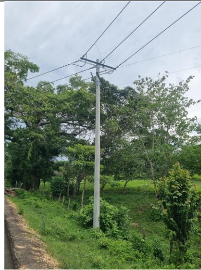
Estructura intermedia y derivación bifásica, medido 2 kilómetros.
