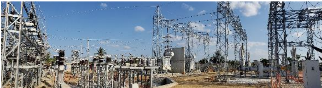
SDL Cerete 110/34,5kV Fuente: AFINIA
