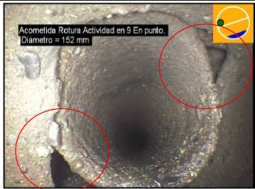
Fotografía No. 5. Acometida de alcantarillado mal emboquillada predio carrera 21 - 30A19
