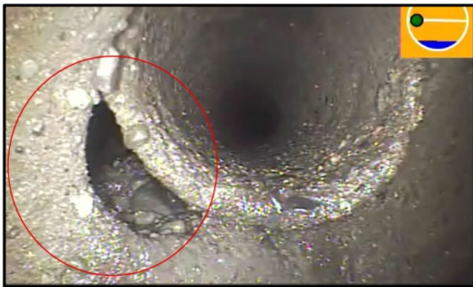
Fotografía No. 6. Acometida de alcantarillado mal emboquillada predio carrera 21 No. 30ª - 19
