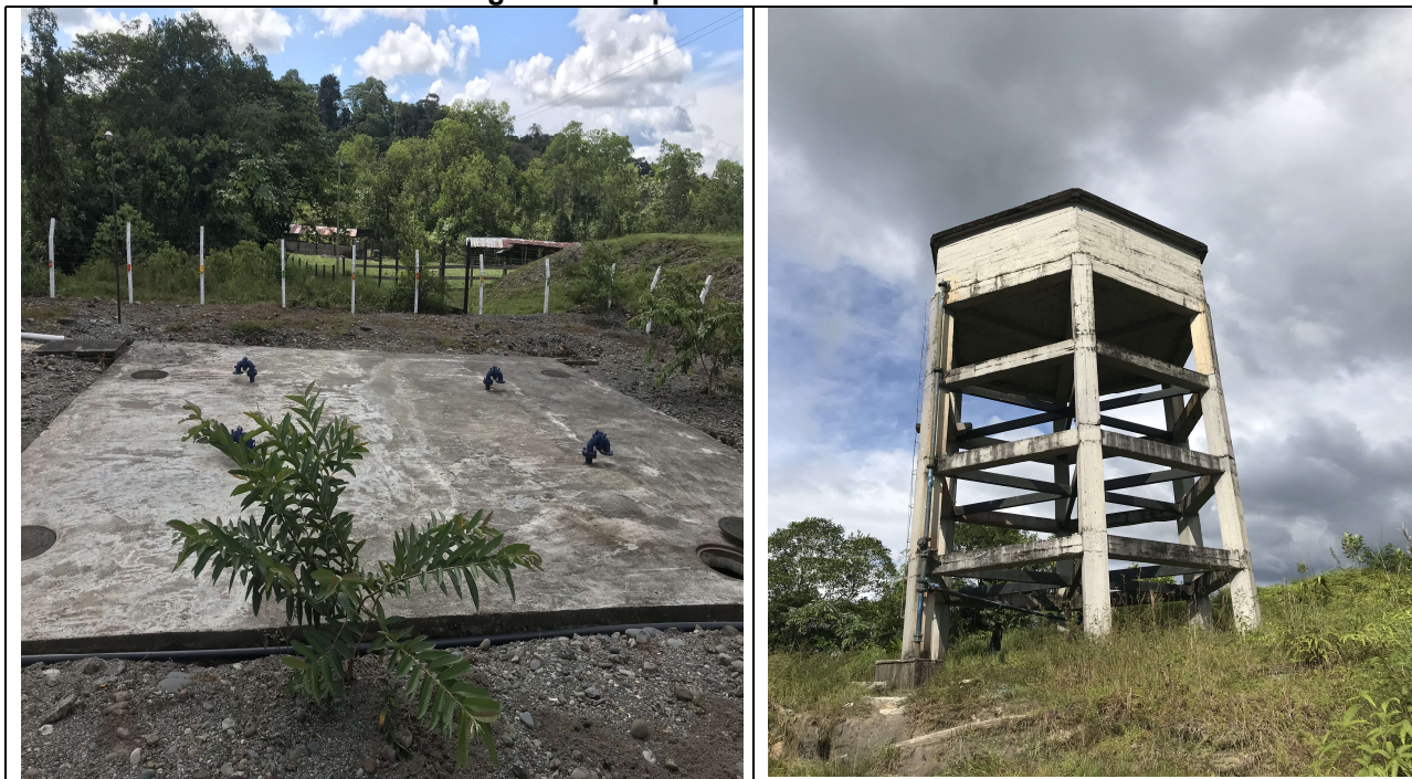
Imagen 23 Tanques de almacenamiento
