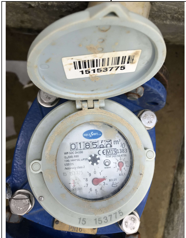
Imagen 24 Macromedidor salida del tanque de almacenamiento elevado
