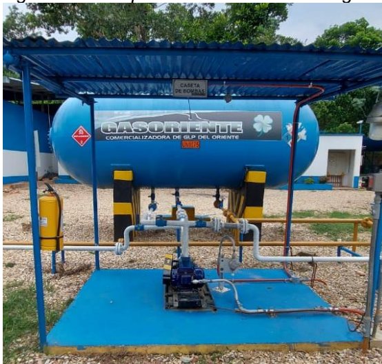
Imagen N°2. Tanque estacionario de 2.800 galones
