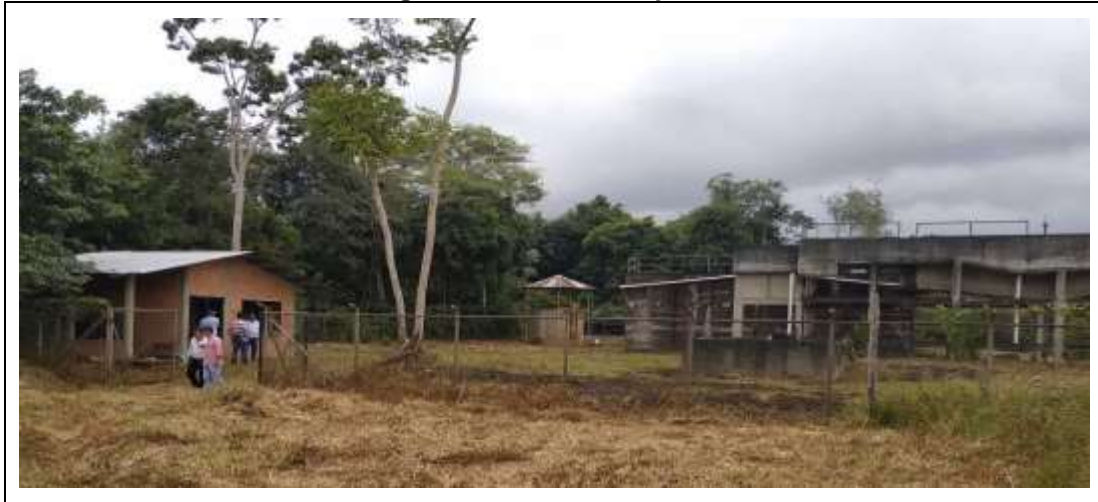
Imagen 27 PTAR municipio Mitú
