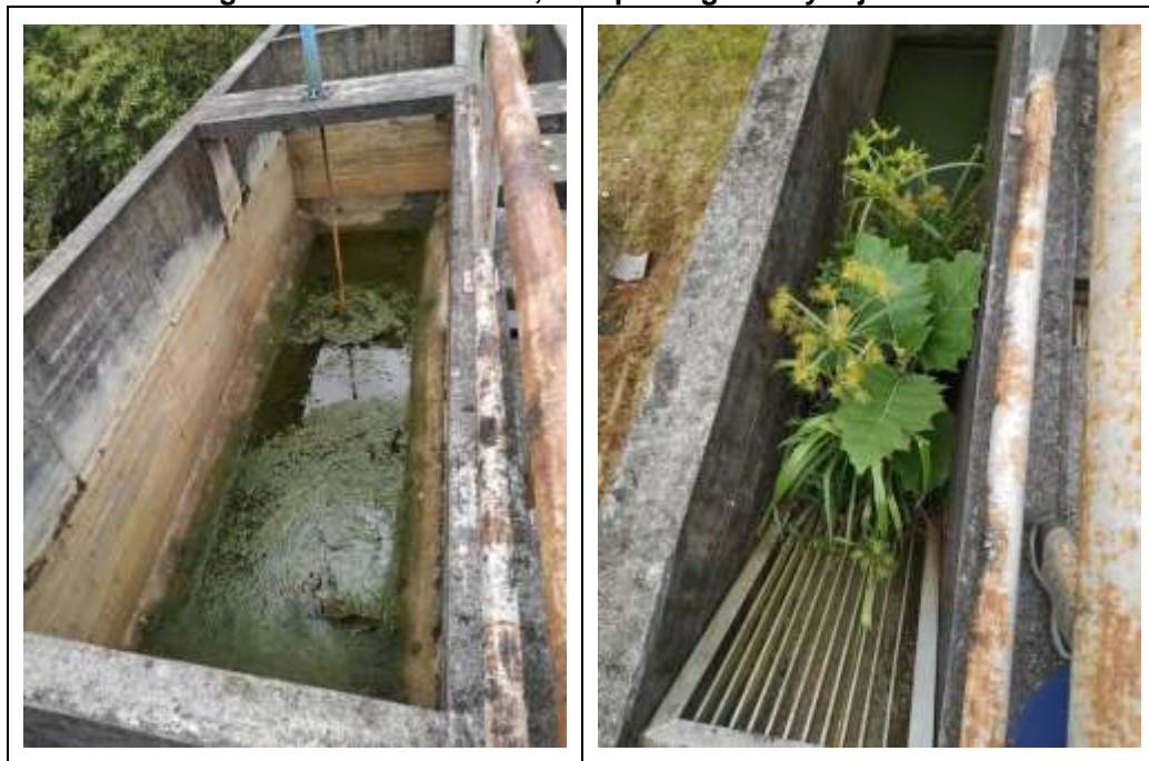
Imagen 29 Desarenadores, trampa de grasas y rejilla PTAR
