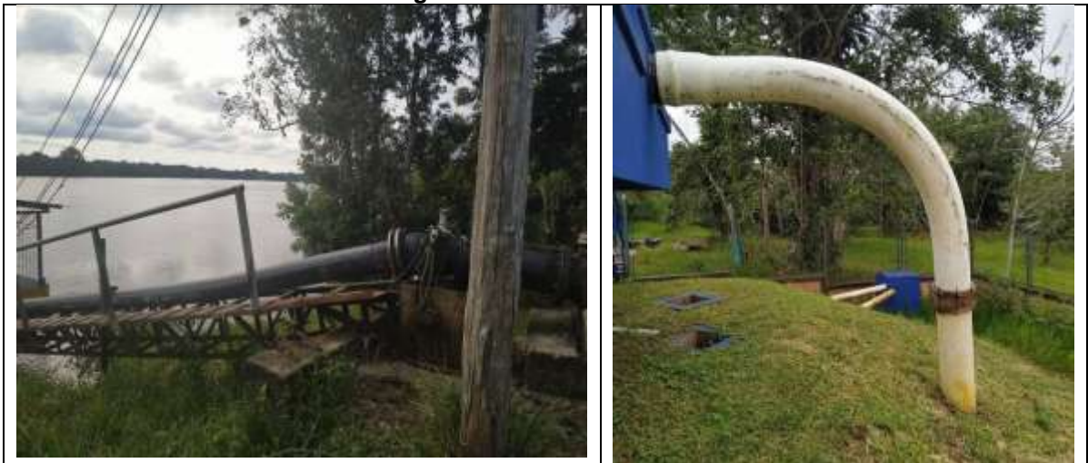
Imagen 9 Tubería de aducción
