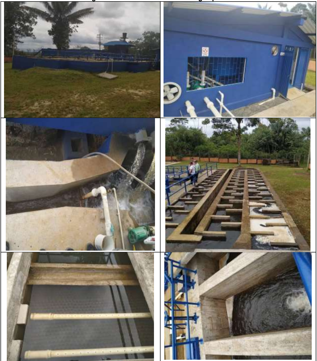
Imagen 11 Planta de tratamiento de agua potable
