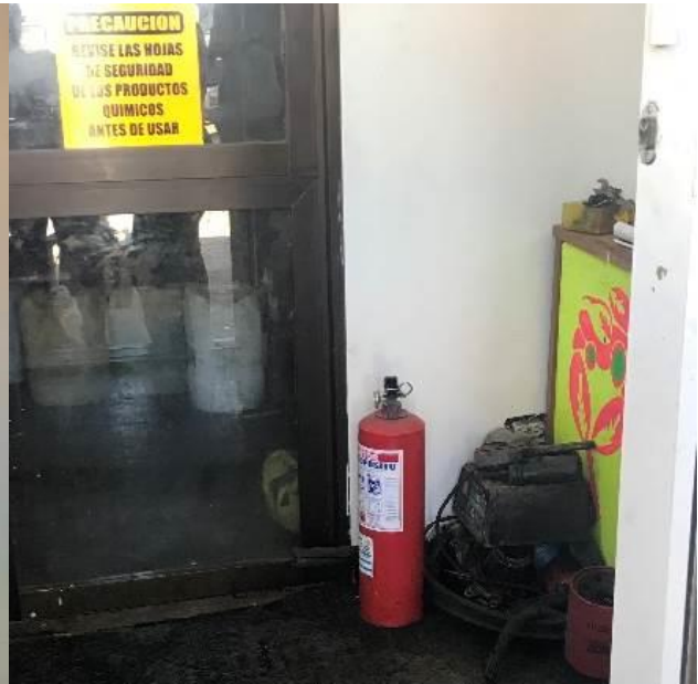
Ref. Equipo contra incendio
