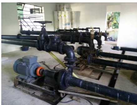
Foto 21. Líneas de bombeo
