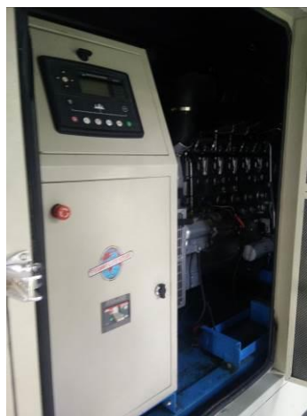
Foto 2. Planta eléctrica de respaldo
