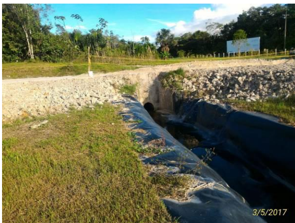
Foto 61. Canal que conduce el lixiviado hasta la Quebrada La Beatriz
