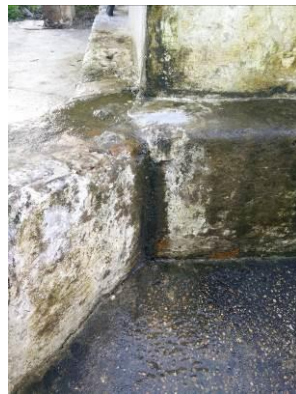
Foto 20. Fuga canal de entrada
