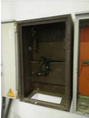
Foto 24. Control eléctrico fuera de funcionamiento
