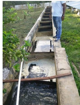
Foto 15. Canal de transporte- Floculador
