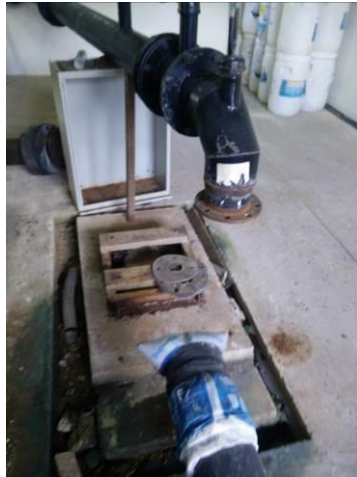
Foto 25. Bomba fuera de operación
