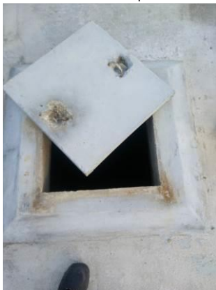
Foto 12. Tanque de paso
