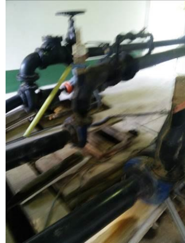
Foto 26. Línea de bombeo fuera de operación
