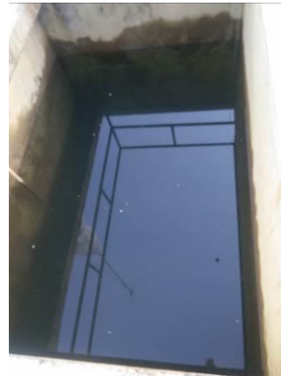
Foto 11. Unidad de filtración
