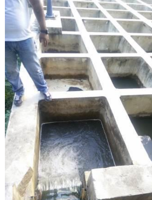
Foto 5. Floculadores de flujo vertical
