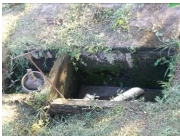
Foto 13. Cámara de entrada PTAP ANTIGUA
