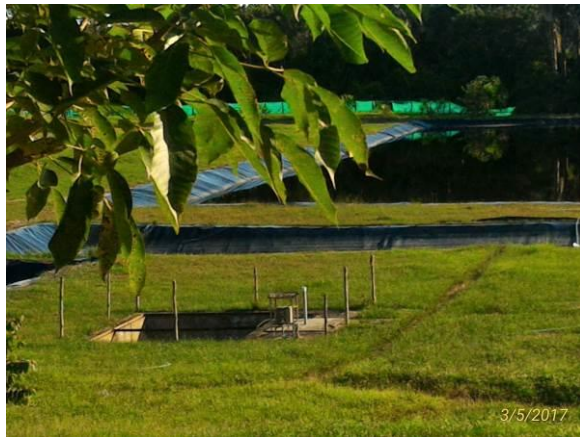
Foto 60. Sistema de Tratamiento de lixiviados
