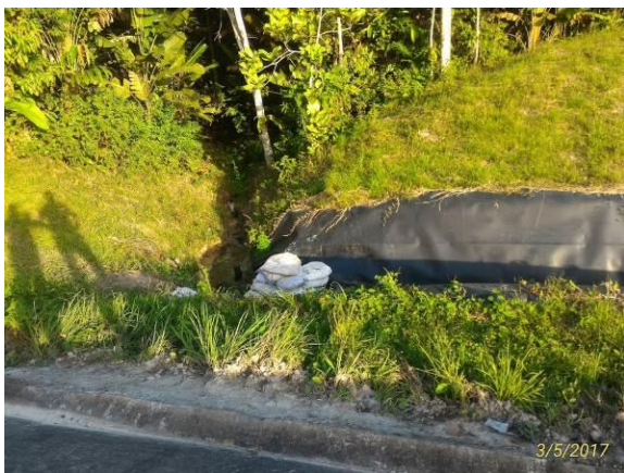
Foto 62. Canal que conduce el lixiviado hasta la Quebrada La Beatriz
