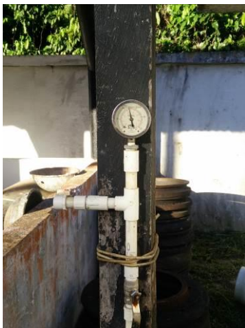
Foto 27. Medición de presión a la salida PTAP
