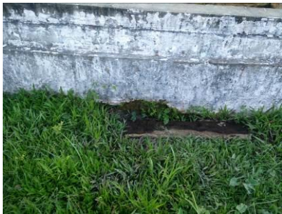
Foto 19. Fuga tanque de sedimentación
