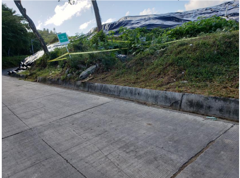
Fuente. Registro fotográfico SSPD – Visita enero 2019
