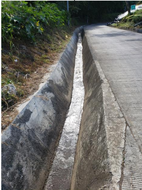
Fuente. Registro fotográfico SSPD – Visita enero 2019
