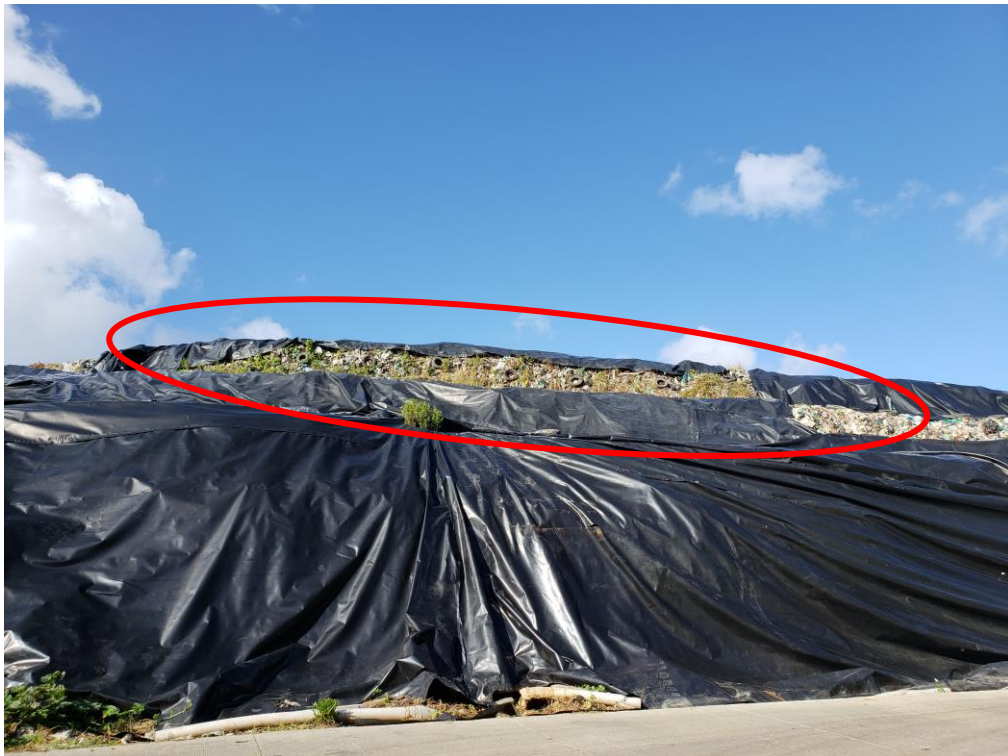
Foto 12. Residuos sin cobertura en zona no activa
