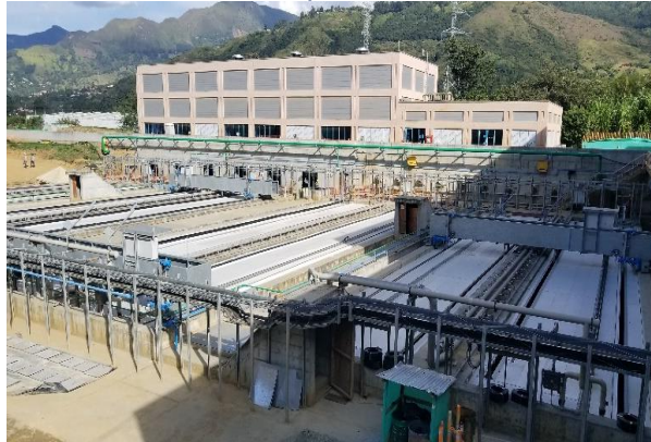
Ilustración 2. Vista general PTAR Aguas Claras. Bello, Antioquia año 2018.
