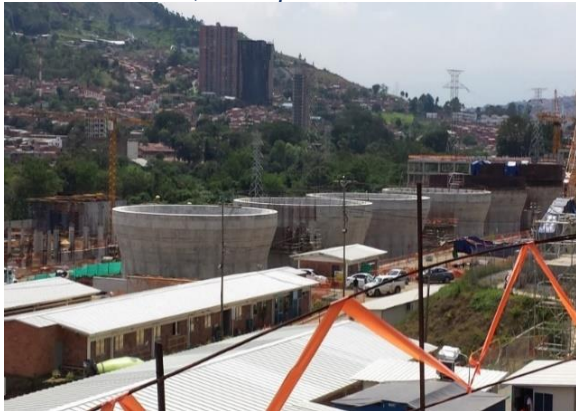
Ilustración 3. Vista general PTAR Aguas Claras. Bello, Antioquia año 2014.
