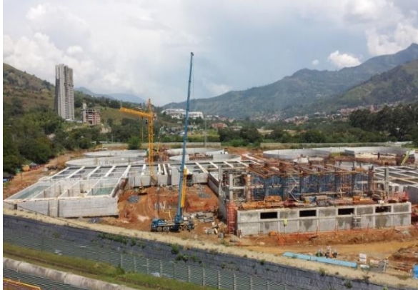
Ilustración 1. Vista general PTAR Aguas Claras. Bello, Antioquia año 2014.
