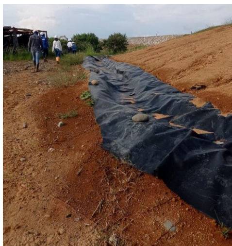
Canales de aguas lluvias en zonas intermedias obstruidos
