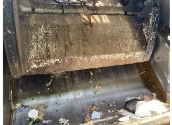
Caja compactadora en zona de parqueo con residuos.
