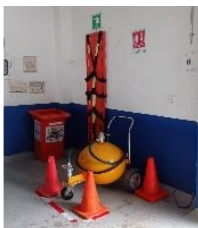
Extintor industrial de 150 libras.
