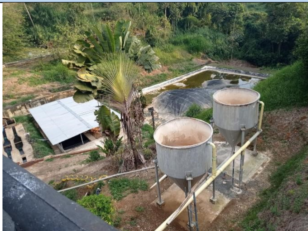
Planta de tratamiento de lixiviados
