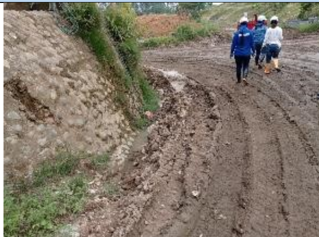
Tramo final que conduce al frente de trabajo donde no se observa manejo de aguas lluvias en sus costados
