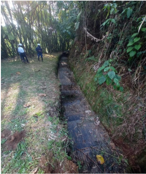
Canales de conducción de lixiviados a la planta de tratamiento
