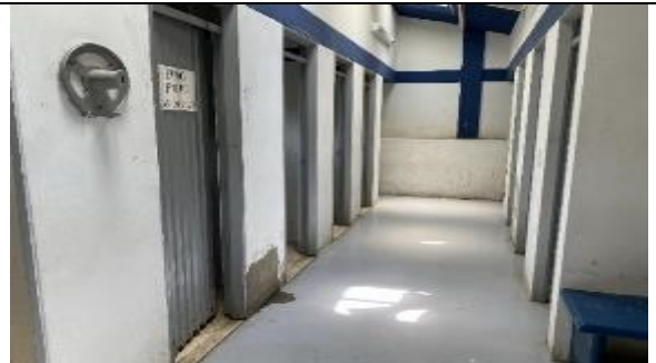
Instalaciones sanitarias con baño fuera de servicio
