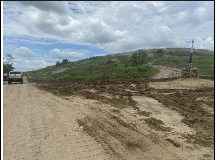
Vías internas, no se observa manejo de aguas lluvias en sus costados
