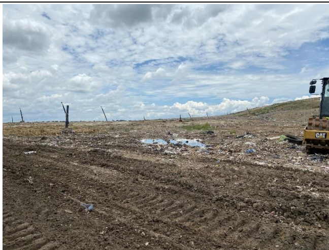
Tramo final que conduce al frente de trabajo donde no se observa manejo de aguas lluvias en sus costados y empozamiento de agua
