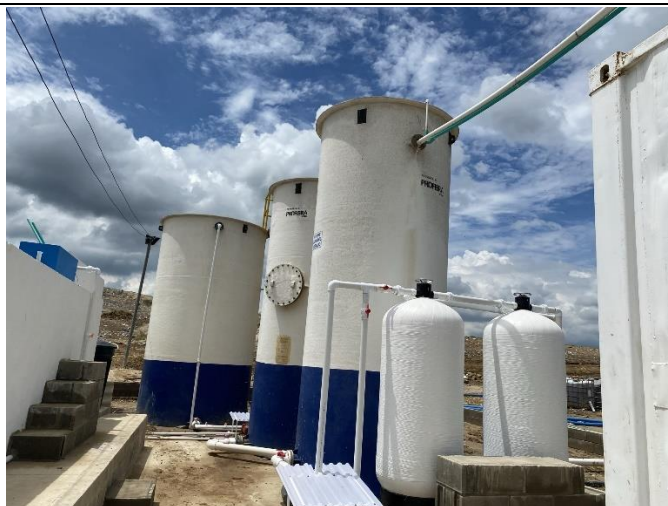
Planta de tratamiento de lixiviados
