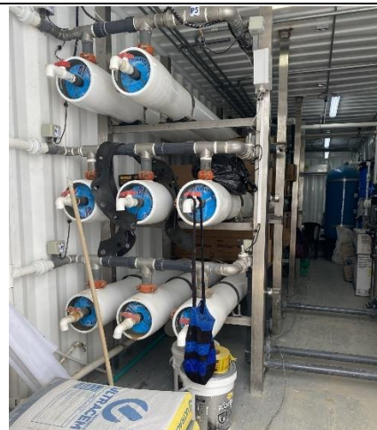
Planta de tratamiento de lixiviados osmosis inversa
