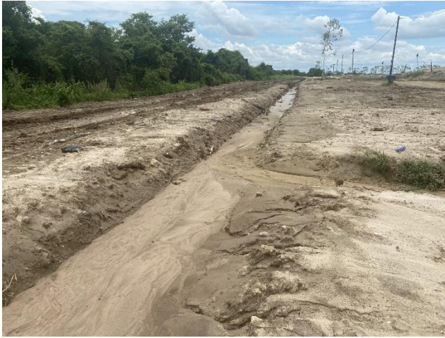
Canales de aguas lluvias en afirmado deteriorado
