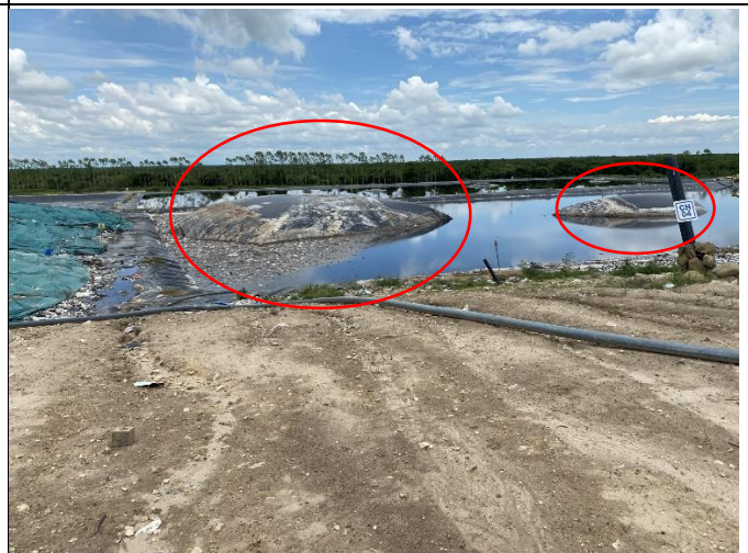
Empozamiento de lixiviados y aguas lluvias y geomembrana con acumulación de aire
