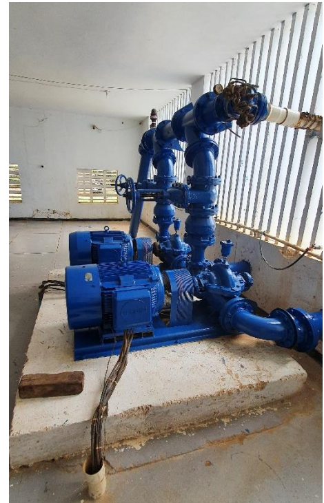
Sistema de bombeo cisterna enterrada
