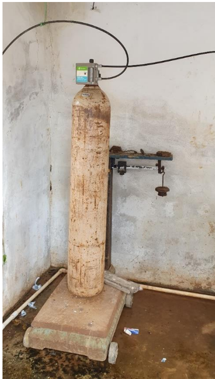
Tanque de cloro gaseoso
