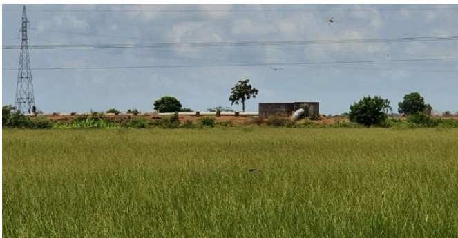
Tubería de entrada al sistema
