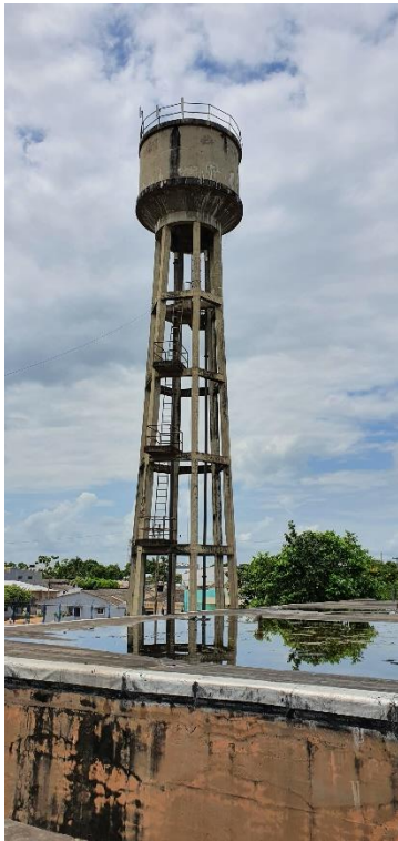
Tanque zona de distribución No. 1
