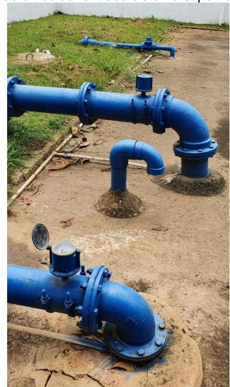
Macromedidores entrada cisterna enterrada
