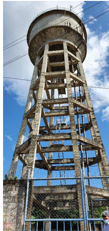
Tanque zona de distribución No. 2
