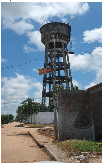
Tanque zona de distribución No. 3
