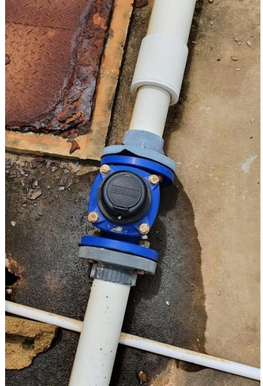
Macromedidor entrada cisterna superficial
