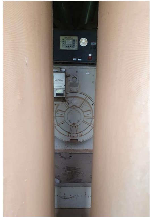
Planta de energía
