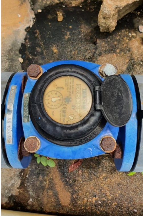
Macromedidor entrada cisterna superficial
