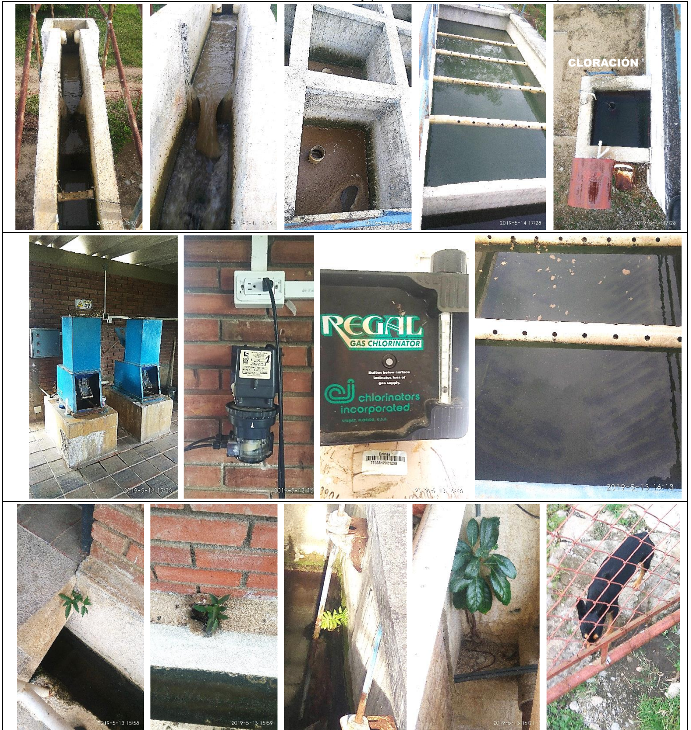
Imagen 9. PTAP nueva del acueducto de Alvarado, Tolima. Se ilustran sus estructuras principales (canal de entrada, vertedero, floculadores, sedimentadores, punto de inyección de desinfectante), dosificadores, detalle de colapso de placas de AC en el sedimentador de la nueva PTAP, presencia de plantas creciendo en diferentes puntos de la estructura, presencia de mascota al interior de la PTAP y panorámica de las estructuras que la componen.
