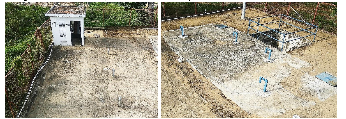
Imagen 12. Se ilustran los tanques de almacenamiento adyacentes a las PTAP del municipio de Alvarado.
