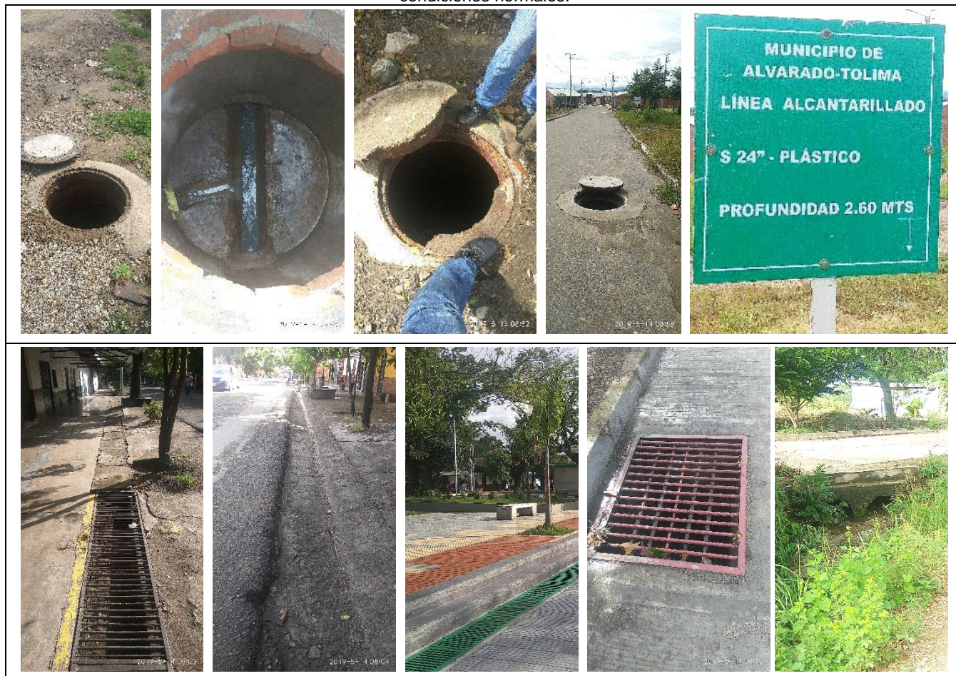
Imagen 16. Pozos de inspección y sumideros de aguas lluvias del casco urbano de Alvarado, operando en condiciones normales.
