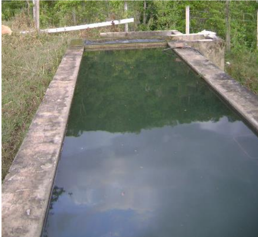
Imagen 11. Desarenador Sistema Quebrada La Grande
