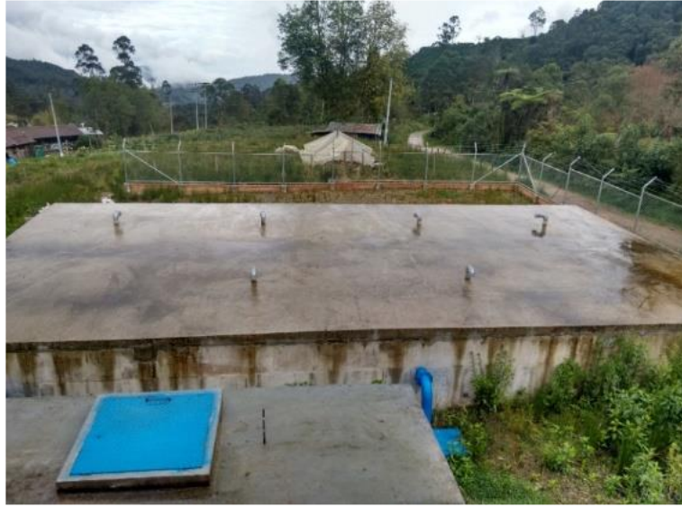
Imagen 67. Tanques de almacenamiento Sistema Quebrada La Chorrera – Acueducto Regional
