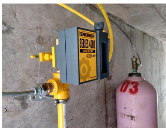
Desinfección con cloro gaseoso
