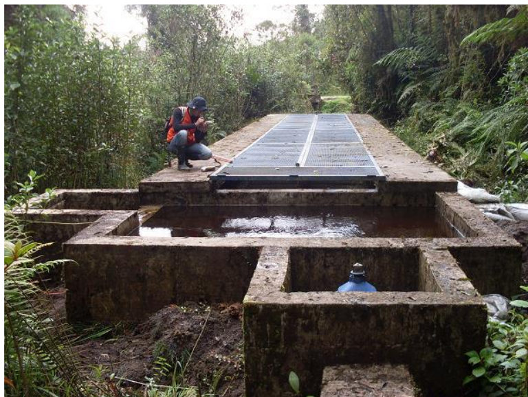
Imagen 12. Desarenador Sistema Quebrada La Chorrera
