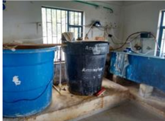
Tanques de preparación del coagulante Planta Convencional
