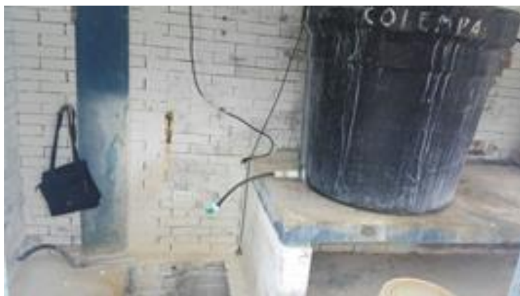
Tanque preparación solución de cloro
