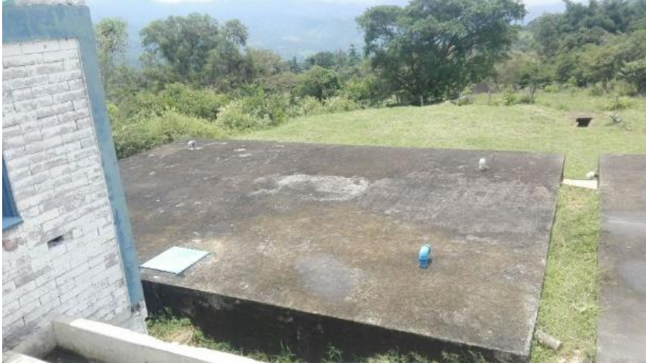
Imagen 56. Tanques de almacenamiento sistema Quebrada Grande – Acueducto Urbano
