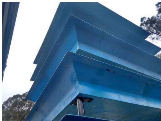
Torre de aireación
