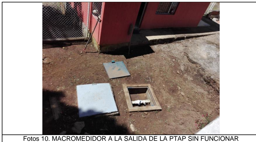
Fotos 10. MACROMEDIDOR A LA SALIDA DE LA PTAP SIN FUNCIONAR
