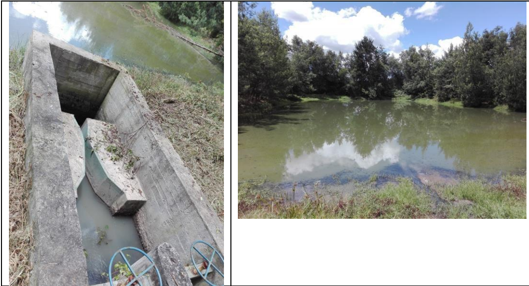
FOTO 13. CANALES DE ENTERADA DE LAS AGUAS RESIDUALES PARA LA PRIMERA LAGUNA DE OXIDACIÓN Y FOTOGRAFIA DE LA LAGUNA
