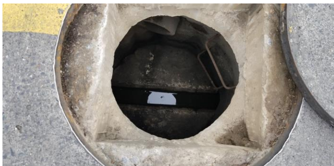
Cámara de inspección sector "San Jorge" Fuente: Registro fotográfico SSPD – visita junio de 2018
