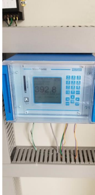
Medición de caudal a la salida de la planta Fuente: Registro fotográfico SSPD – visita junio de 2018
