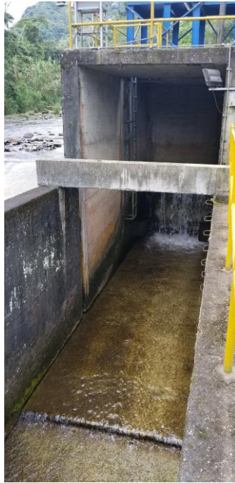
Compuerta del canal de desvío
