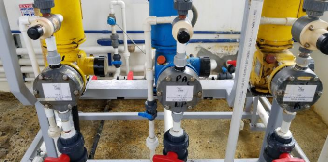
Sistema de dosificación de coagulantes
