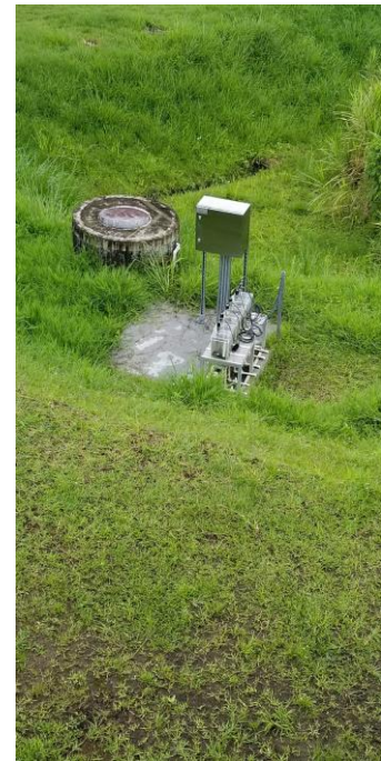
Sensores de medición de parámetros de agua filtrada
