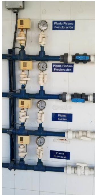
Sistema de dosificación de cloro
