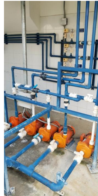
Bombas dosificadoras de cloro
