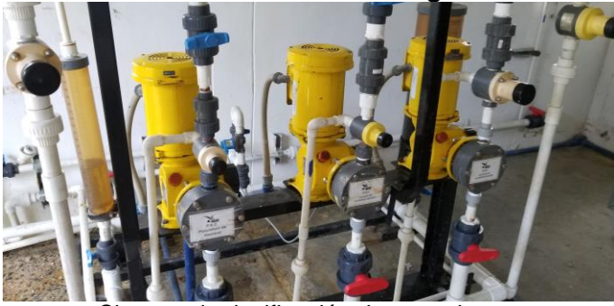
Sistema de dosificación de coagulantes
