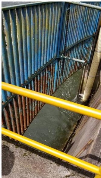
Bocatoma lateral – Rejilla de sólidos gruesos
