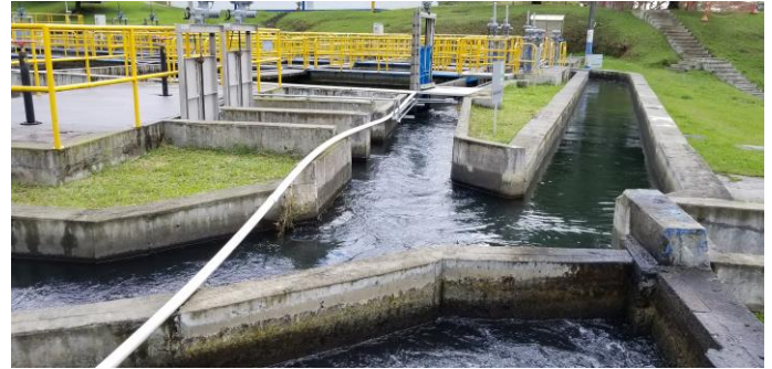
Canal de salida de los desarenadores
