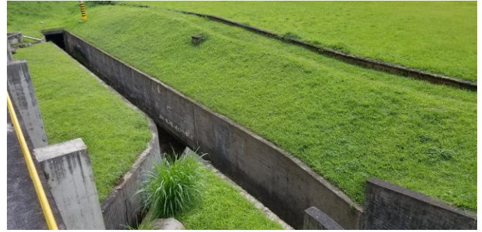
Canales de disposición de arenas y sólidos
