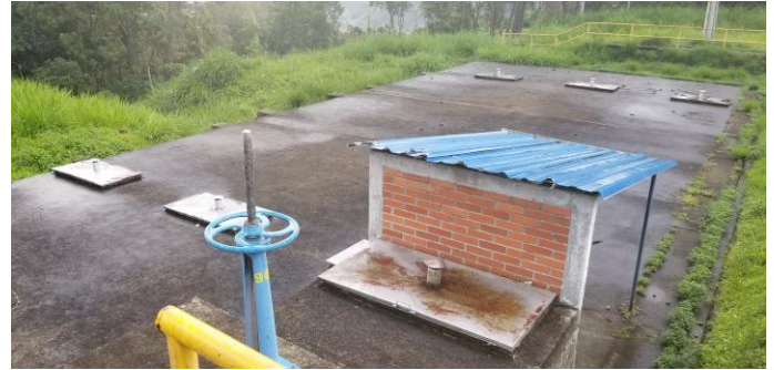
Tanque de contacto de cloro
