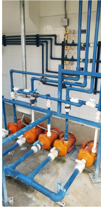
Bombas dosificadoras de cloro
