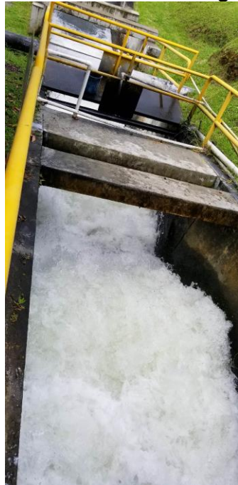
Canal de mezcla rápida
