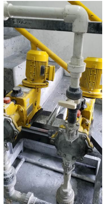
Sistema de dosificación de cal
