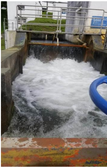
Vertedero y regleta de medición de niveles
