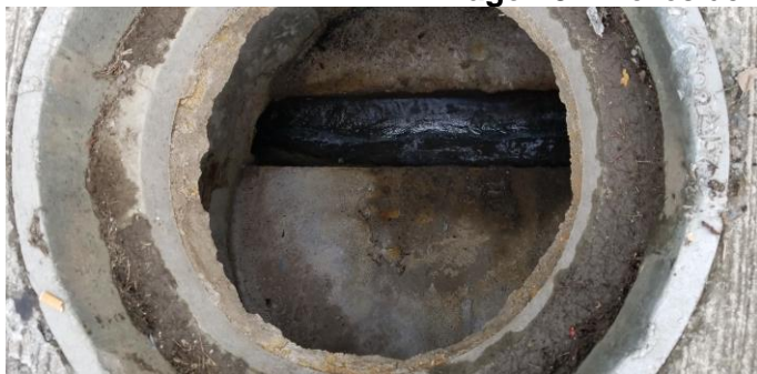
Cámara de inspección sector "La Villa"
