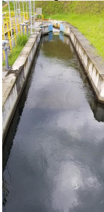
Canal de entrada a la planta
