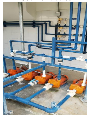
Bombas dosificadoras de cloro
