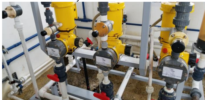
Sistema de dosificación de coagulantes líquidos
