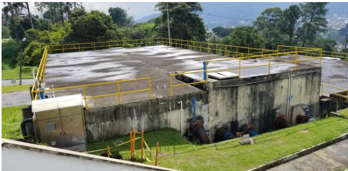
Tanque de contacto de cloro
