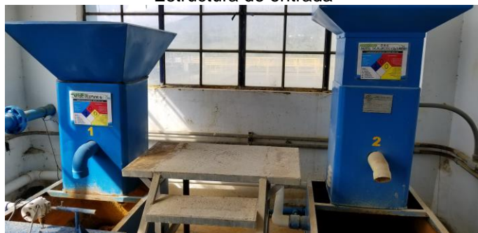
Sistema de dosificación de policloruro de aluminio granulado
