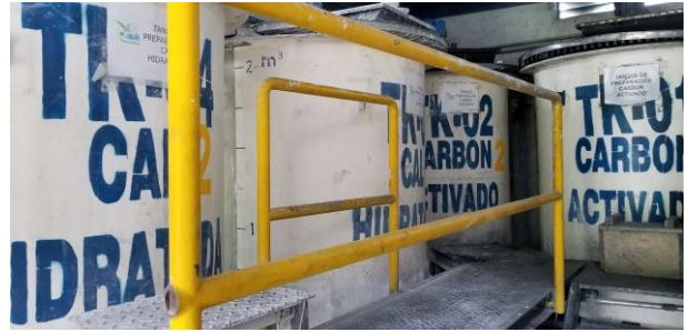
Tanques de almacenamiento de carbón activado y cal
