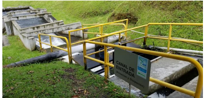
Canal de mezcla rápida
