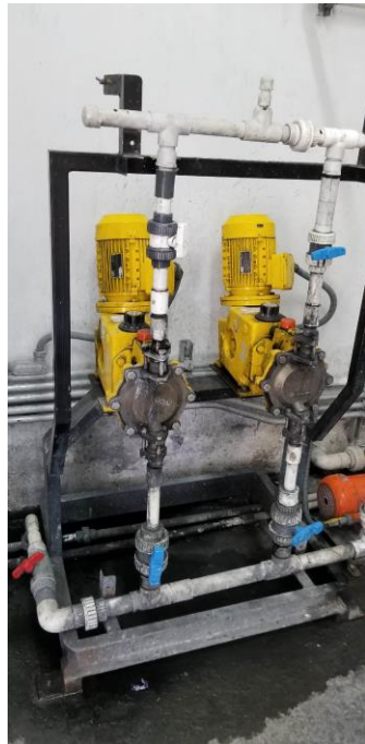
Sistema de dosificación de carbón activado
