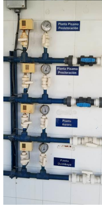
Sistema de dosificación de cloro
