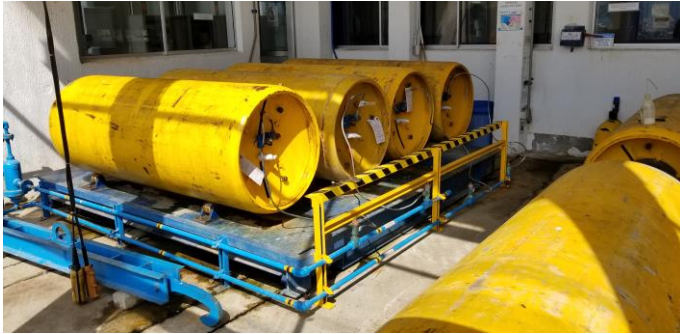
Tanques de cloro gaseoso
