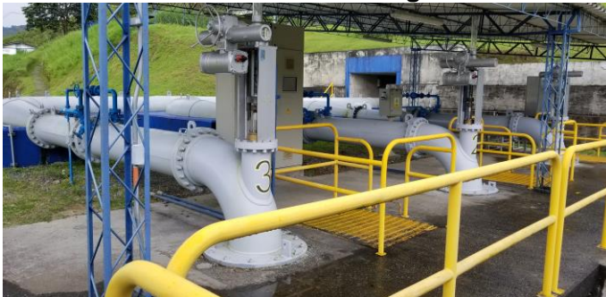
Descarga del sistema de aducción
