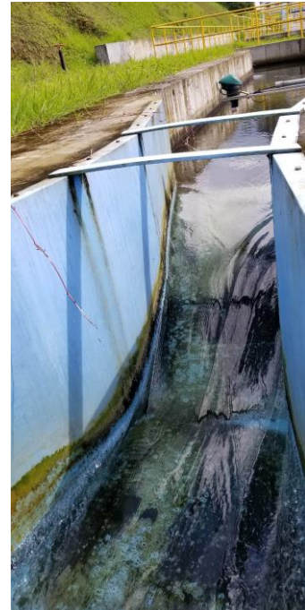
Canaleta Parshall y medición del caudal de entrada
