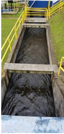
Entrada al sistema de dosificación de carbón activado y cal
