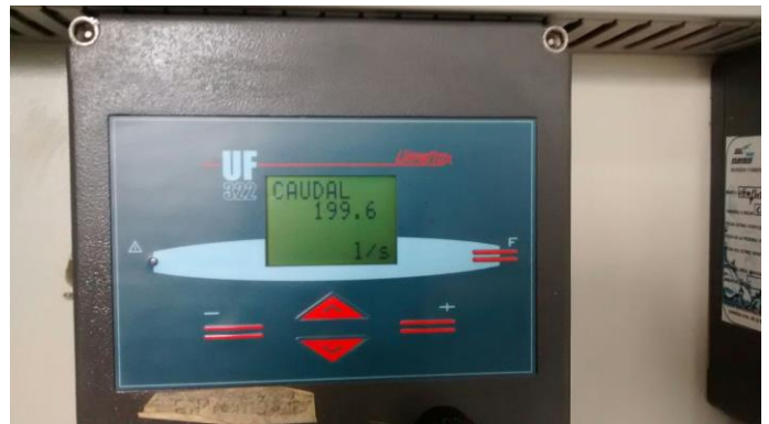
Medición de caudal de salida de la planta
