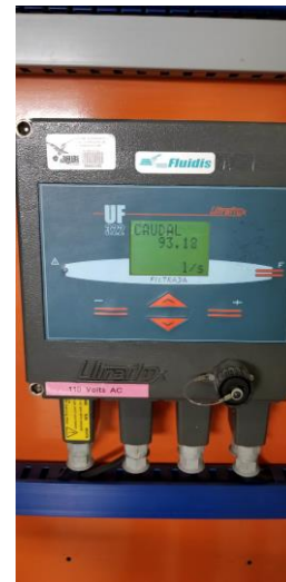
Medición de caudal a la salida de la planta
