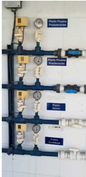
Sistema de dosificación de cloro
