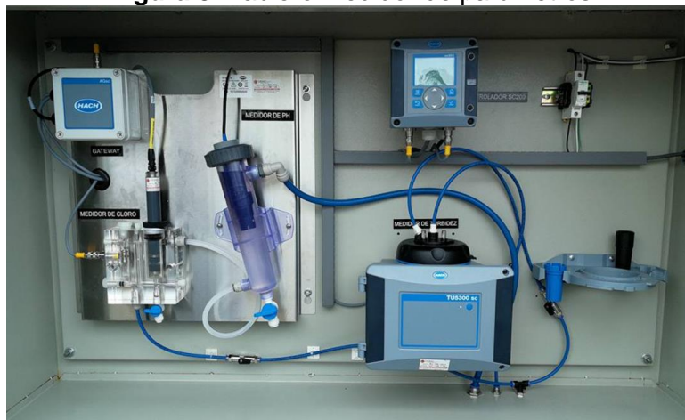
Figura 8. Tablero medidor de parámetros
