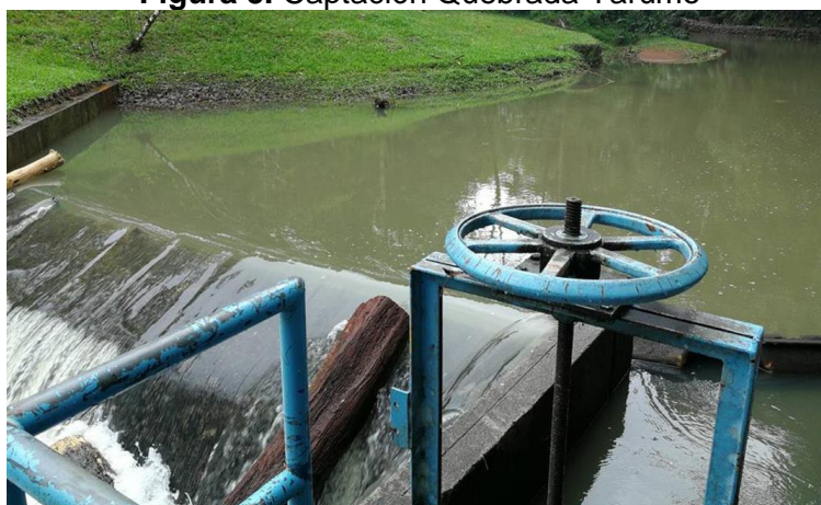
Figura 5. Captación Quebrada Yarumo
