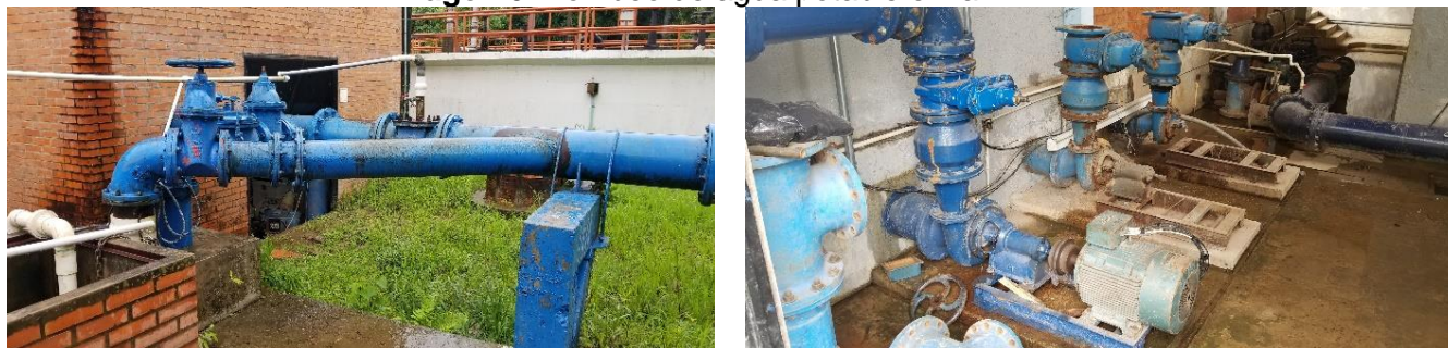
Imagen 6. Bombeo de agua potable en la PTAP.
