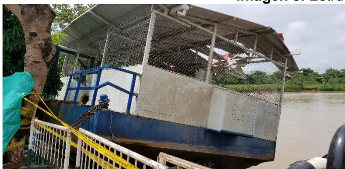
Barcaza flotante – Fuera de operación.
