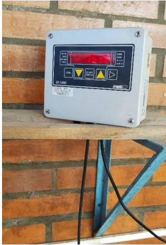
Dosificador de cloro gaseoso.
