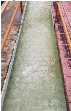
Canal de ingreso a los filtros.
