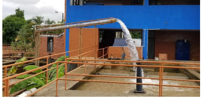
Estructura de entrada – Pozo profundo.
