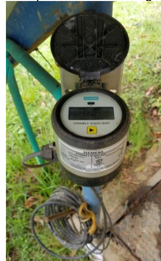
Macromedidor – Salida de 14 pulgadas.
