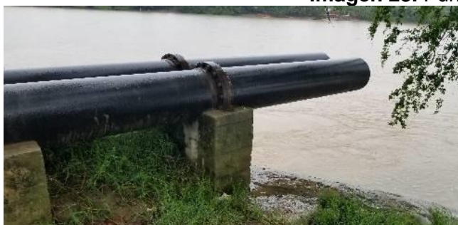
a) Tubería de vertimiento por bombeo.
