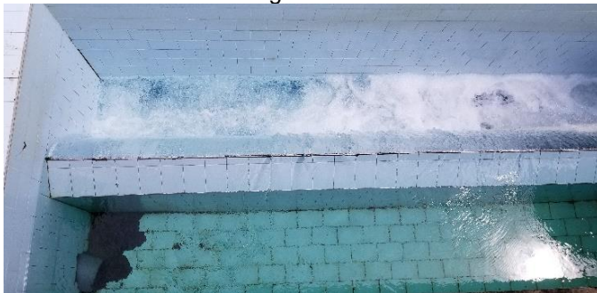
Vertedero para la aireación del agua.
