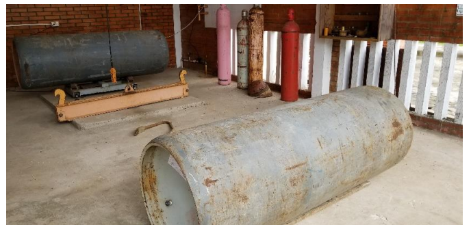
Tanques de almacenamiento de cloro gaseoso.
