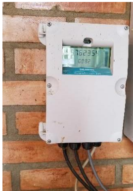
Pantalla del macromedidor.
