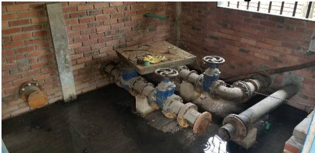
Equipos de bombeo.
