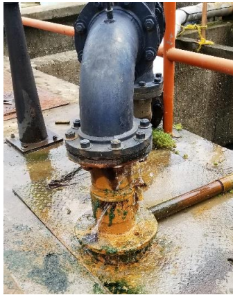
Pozo profundo – PTAP Miramar.
