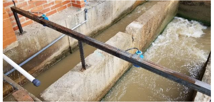
Medición de caudales a la entrada de la PTAP.
