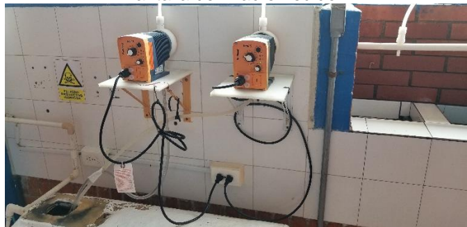
Equipos de dosificación de coagulante.
