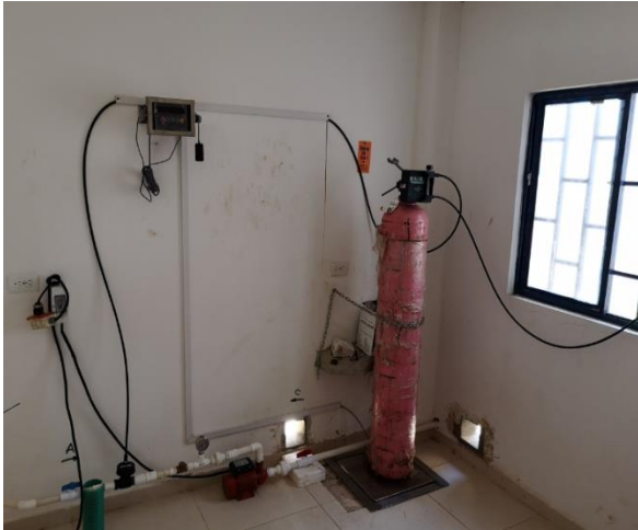
Dosificación de cloro
