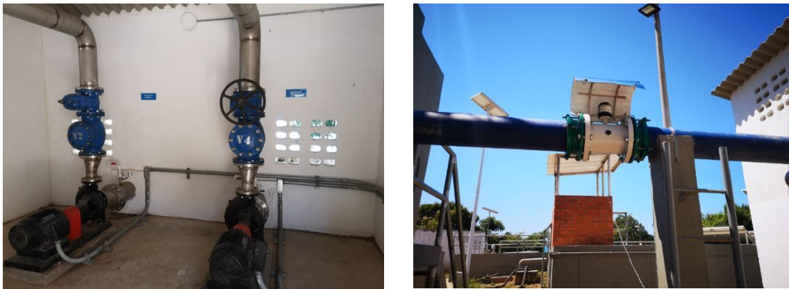
Imagen 7. Bombeo y macromedición en PTAP.
