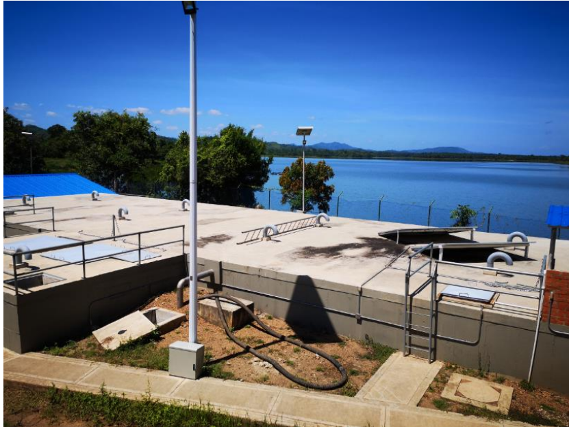
Imagen 12. Tanques de almacenamiento Planta de Tratamiento
