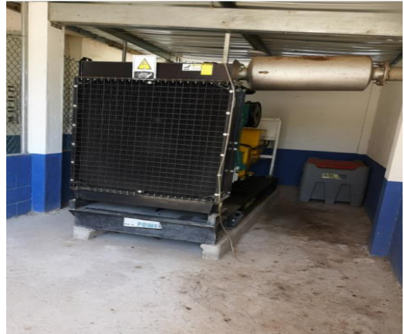
Planta de generación de energía
