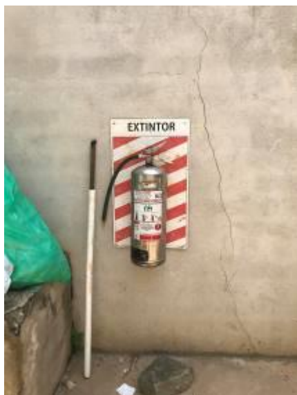
b) Extintor Tipo A, ECA Montelíbano.
