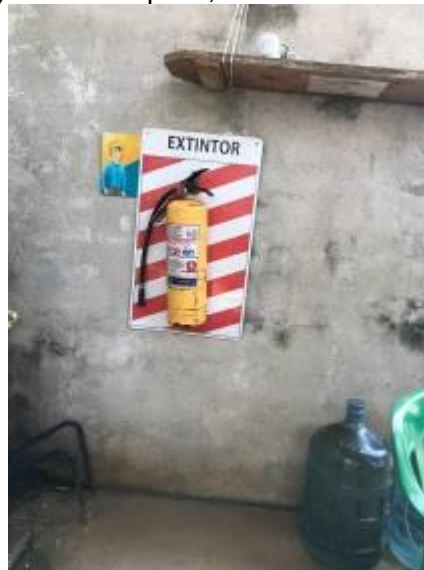
c) Extintor Tipo B, ECA Montelíbano.
